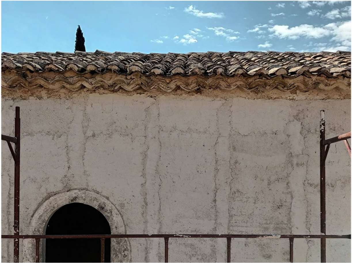
Άποψη του γείσου προς ανακατασκευή
