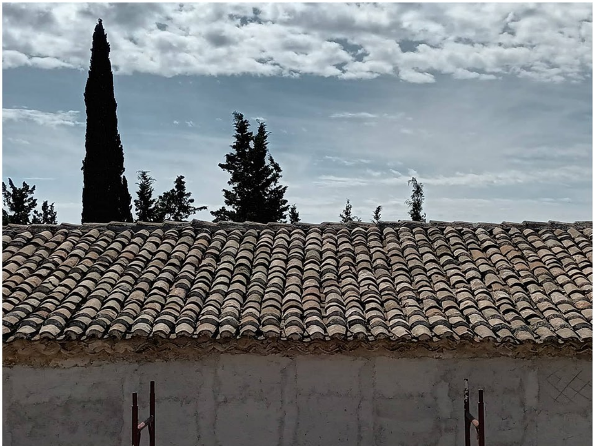
Άποψη της επικεράμωσης προς ανακατασκευή
