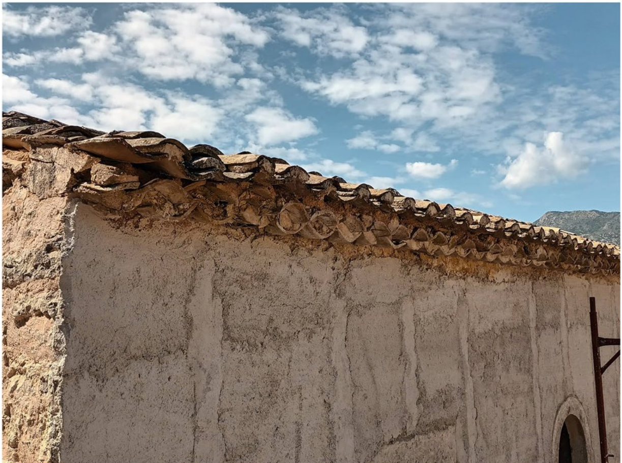
Άποψη του γείσου προς ανακατασκευή
