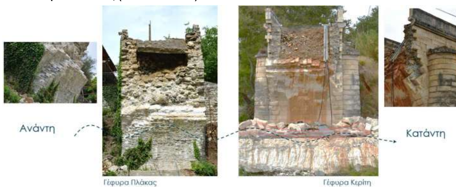
Εικόνα 10.8 Συσχέτιση περίπτωσης γέφυρας Πλάκας και γέφυρας Κερίτη – περιοχές οι οποίες επιβαρύνθηκαν από την συγκέντρωση μέγιστων θλιπτικών τάσεων, λόγω υποσκαφής των
