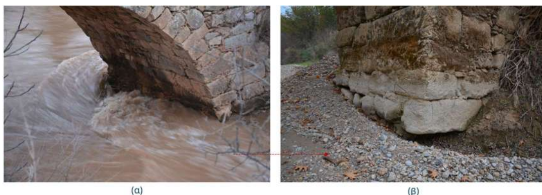
Εικόνα 4.10 Περιοχή σχηματισμού περιδινήσεων στην κατάντη περιοχή μεσοβάθρου λίθινης γέφυρας στον π. Βοιωτικό Κηφισό στην Αγ. Παρασκευή (α) κατά την διάρκεια πλημμυρικού γεγονότος και (β) κατά την περίοδο ξηρασίας όπου διακρίνεται η άρχουσα υποσκαφή του μεσοβάθρου.
