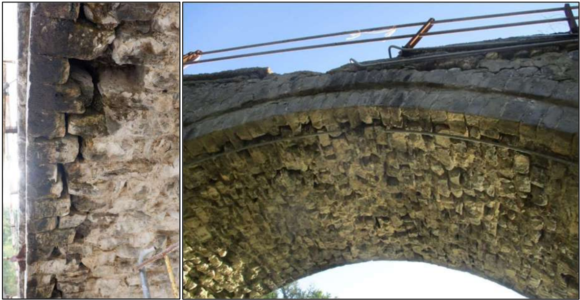
Εικ. 20 Ρηγμάτωση λίθινου φέροντος οργανισμού.
