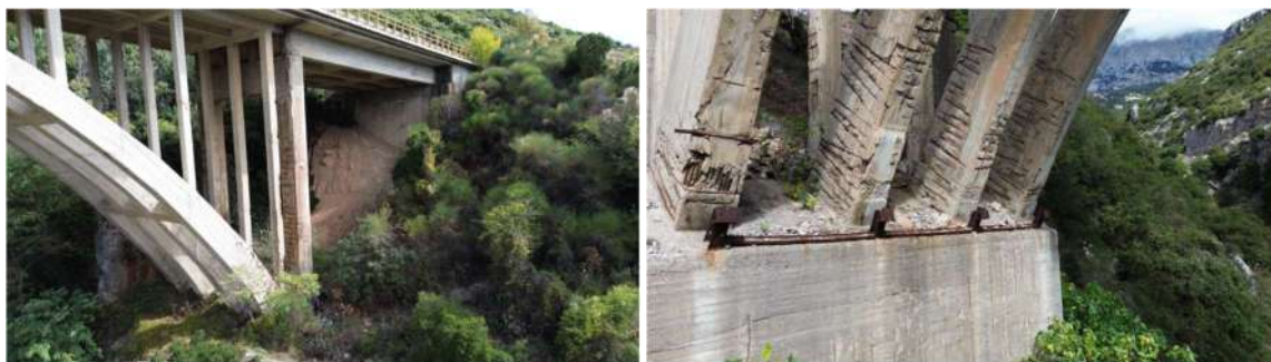
Εικ. 34 Γέφυρα Ζεμενού, οξείδωση σπλισμού.
