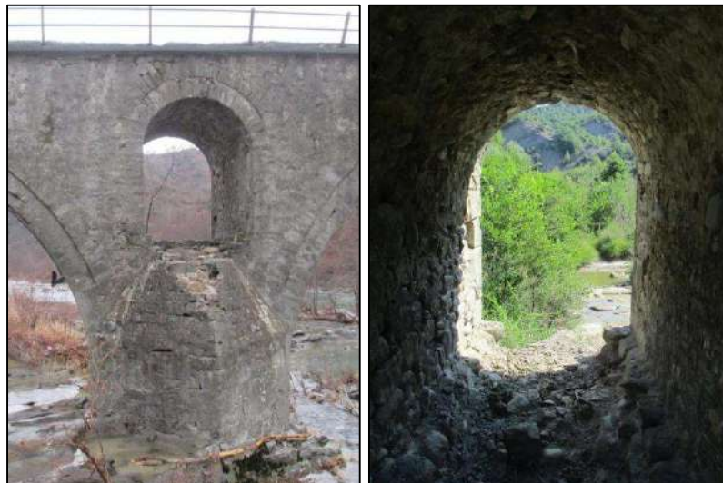
Εικ. 28 Καταστροφές της στέψης των εμβόλων και των λιθόστρωτων δαπέδων των ανακουφιστικών τόξων.
