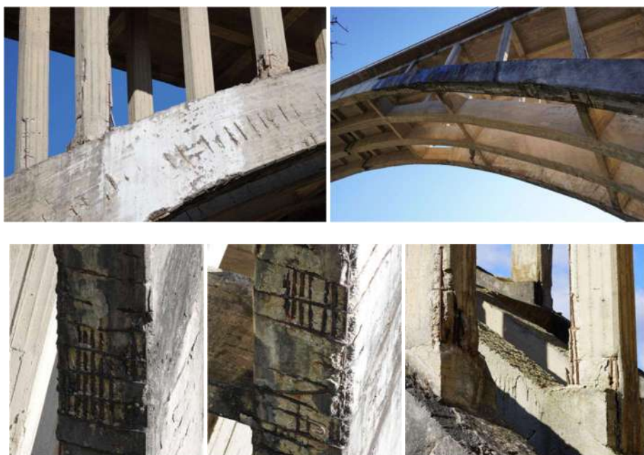
Εικ. 38 Γέφυρα Καρύταινας, οξείδωση οπλισμών.
