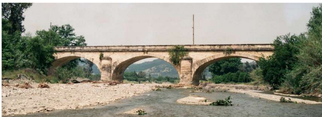
Εικόνα 5.1 Η γέφυρα Κερίτη πριν την μερική της κατάρρευση (πηγή: Α. Χατζηδάκης)
