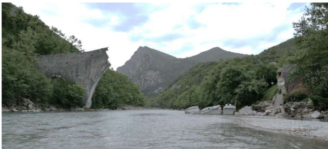
Εικόνα 4.2 Η γέφυρα Πλάκας μετά την μερική κατάρρευσή της (φωτογραφία: Μάιος 2015)
