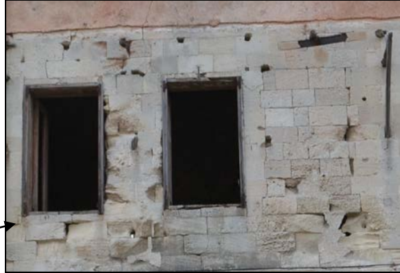
Εικ. 126-127 Έντονα φαινόμενα διάβρωσης λιθοδομής στο τμήμα της βόρειας όψης που κατέρρευσε.
