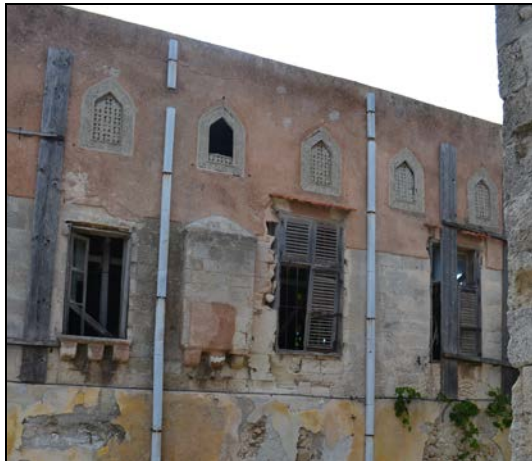
Εικ.71 Εξοχές της λιθοδομής που εδράζονται σε λίθινα φουρούσια, τα οποία αποτελούσαν τις δύο εντοιχισμένες ντουλάπες του νοτιοδυτικού οντά.
