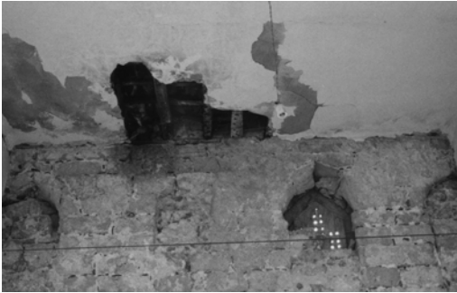
Εικ. 134 Εισροή υδάτων σε τμήμα του δώματος.
