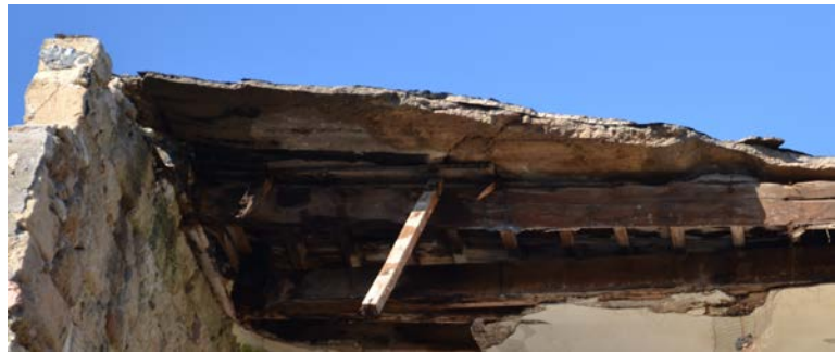
Εικ. 135 Τμήμα δώματος που κατέρρευσε, παρατηρείται ο βαθμός αποσάθρωσης των δοκαριών.
