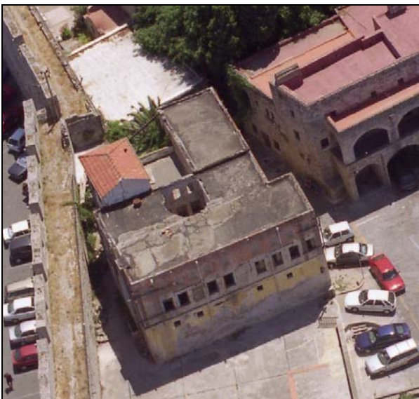
Εικ. 118 Η Κακή κατάσταση διατήρησης του δώματος.
