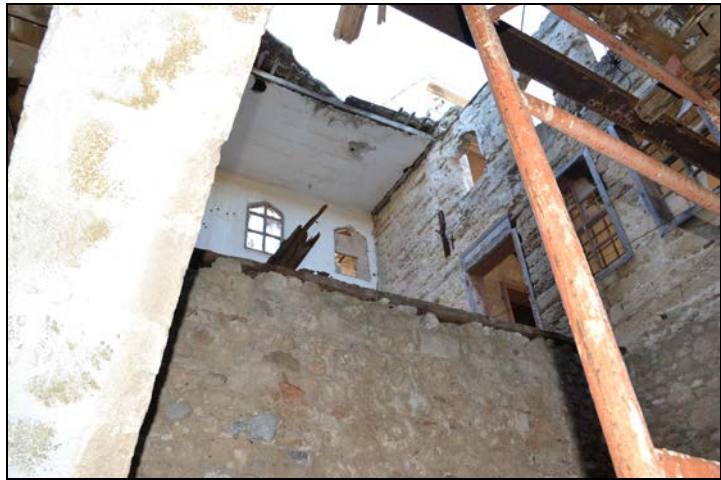
Εικ. 132 Κεντρικό σημείο του χαγιάτι, με τμηματική κατάρρευση δώματος και μεσοπατώματος.
