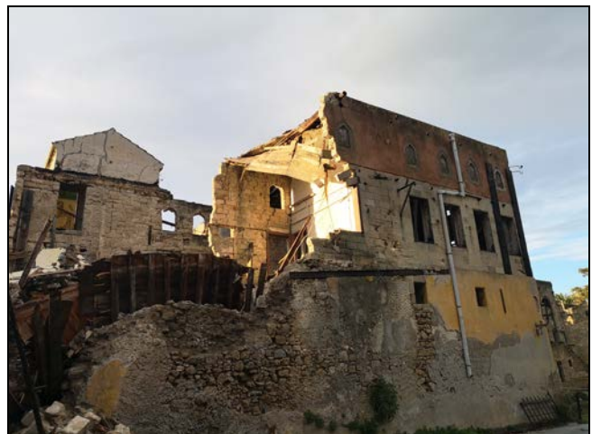
Εικ. 119 Η κατάρρευση στο βορειοανατολικό τμήμα.
