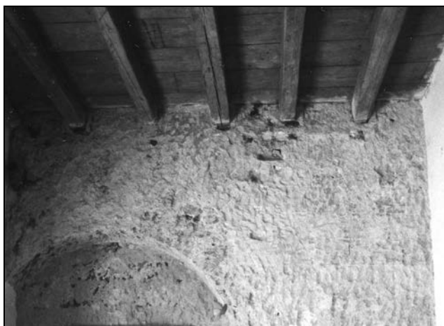
Εικ.87 Έλλειψη ξυλοδεσιάς στο επίπεδο έδρασης των δοκών του μεσοπατώματος.
