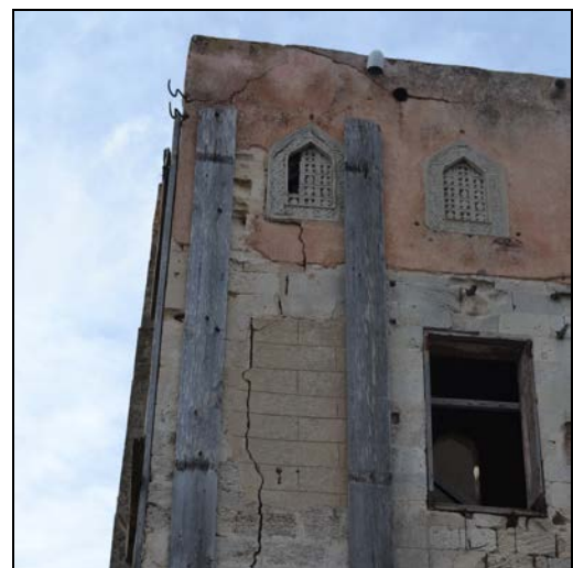
Εικ. 125 Έντονη ρηγματώση στη βορειοανατολική γωνία.
