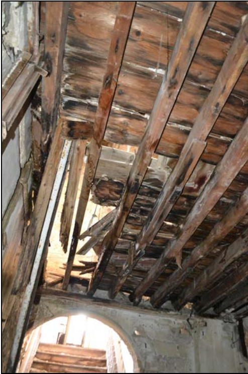
Εικ.131 Τμήμα του μεσοπατώματος σε πλήρη αποσάθρωση.
