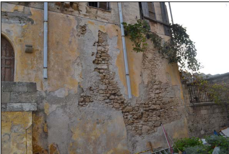
Εικ.120 Απώλεια κονιάματος δομής και αποδιοργάνωση λιθοδομής.
