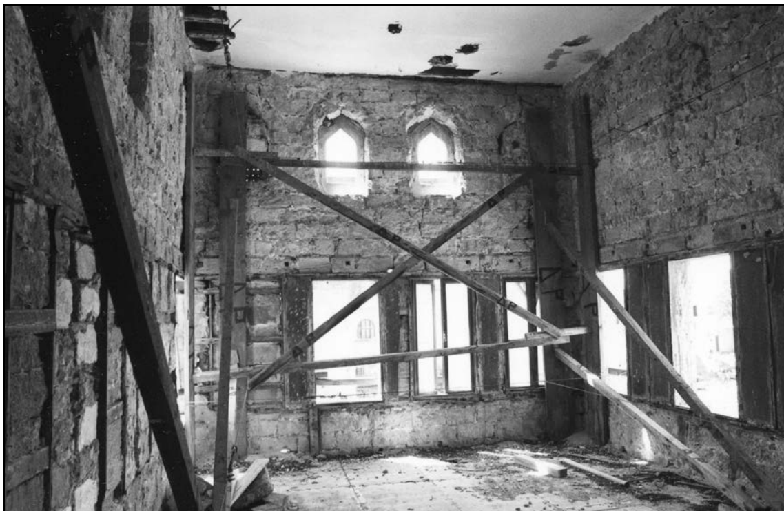
Εικ.65 Στο χώρο των οντάδων, στις εξωτερικές λιθοδομές βόρεια και δυτικά, τα ανοίγματα, διατηρούν τις αρχικές διαστάσεις, με την αλλαγή της μορφής των ξύλινων κουφωμάτων, ανοιγόμενα τζαμλίκια και καρφωτά σκούρα, αντί για τα αρχικά συρόμενα και ταμπλαδωτά.
