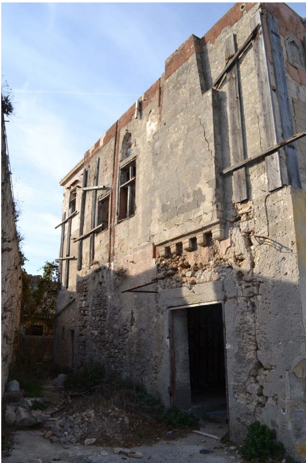
Εικ. 4 Αποδιοργάνωση και ρηγματώσεις στην τοιχοποιία
