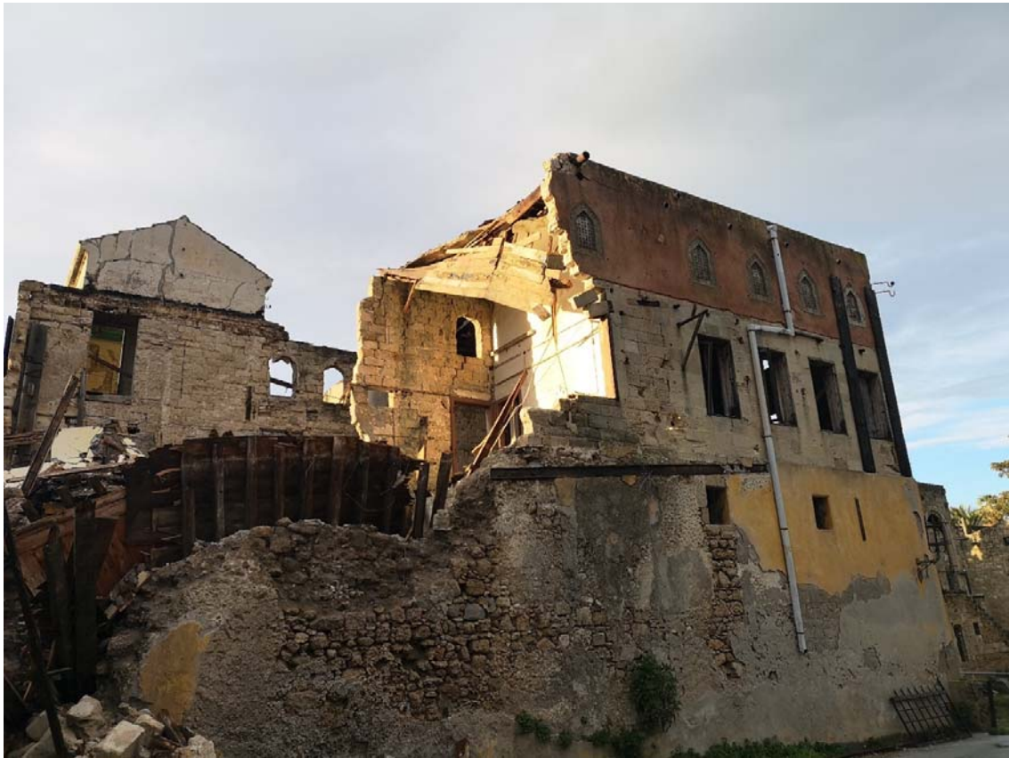
Εικ. 2 Κατάρρευση τμήματος κτιρίου
