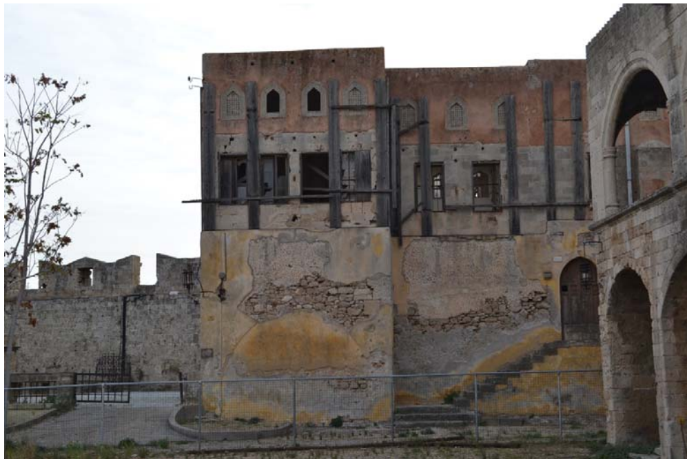
Εικ. 3 Αποδιοργάνωση και ρηγματώσεις στην τοιχοποιία
