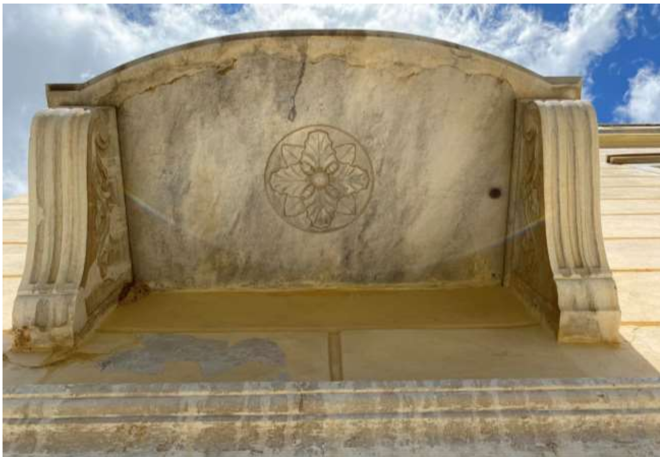
Εικ.35: Κάτω όψη εξώστη νότιας όψης χώρου Α2 (1 ου από δυτικά)
