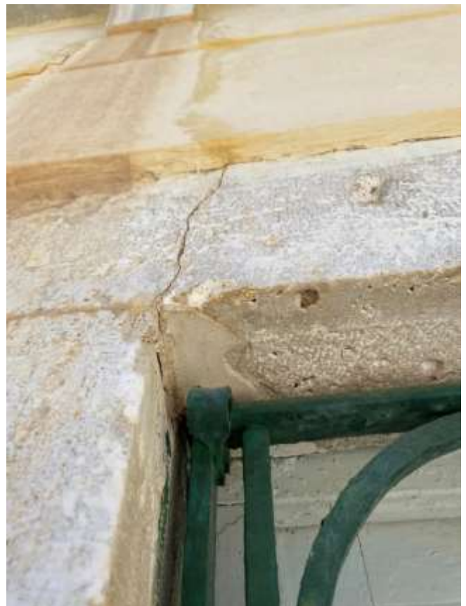
Εικ.31: Λεπτομέρεια εικ.29 - ρωγμή
