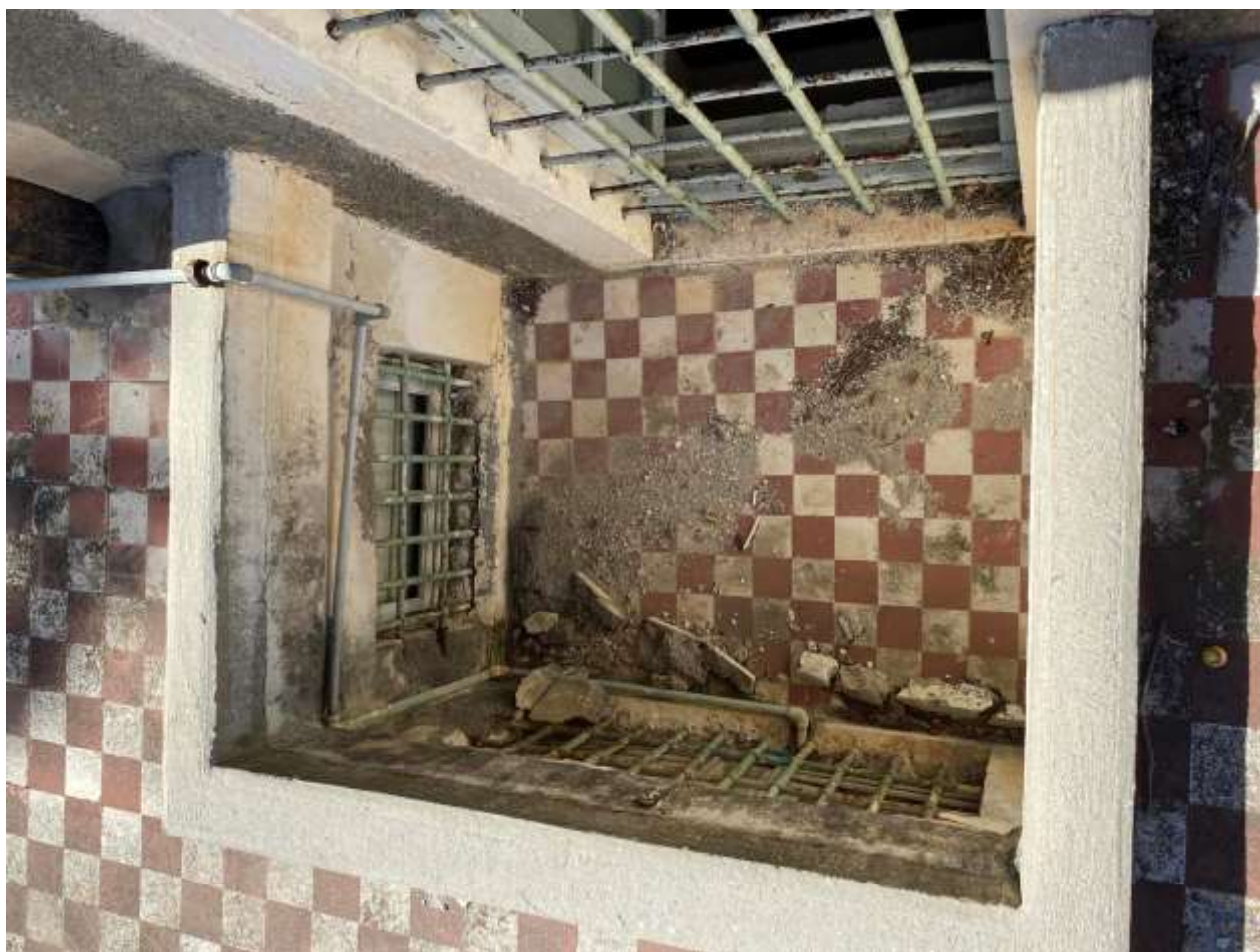
Εικ.91: Υποβαθμισμένο δάπεδο φεγγίτη βορεινής προσθήκης του ισογείου (ΙΣ7, ΙΣ8)
