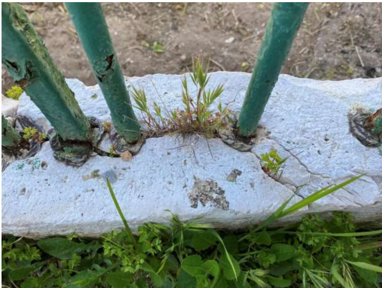
Εικ.143: Λεπτομέρεια κιγκλιδωμάτων περιβολιού: φθορά λίθου
