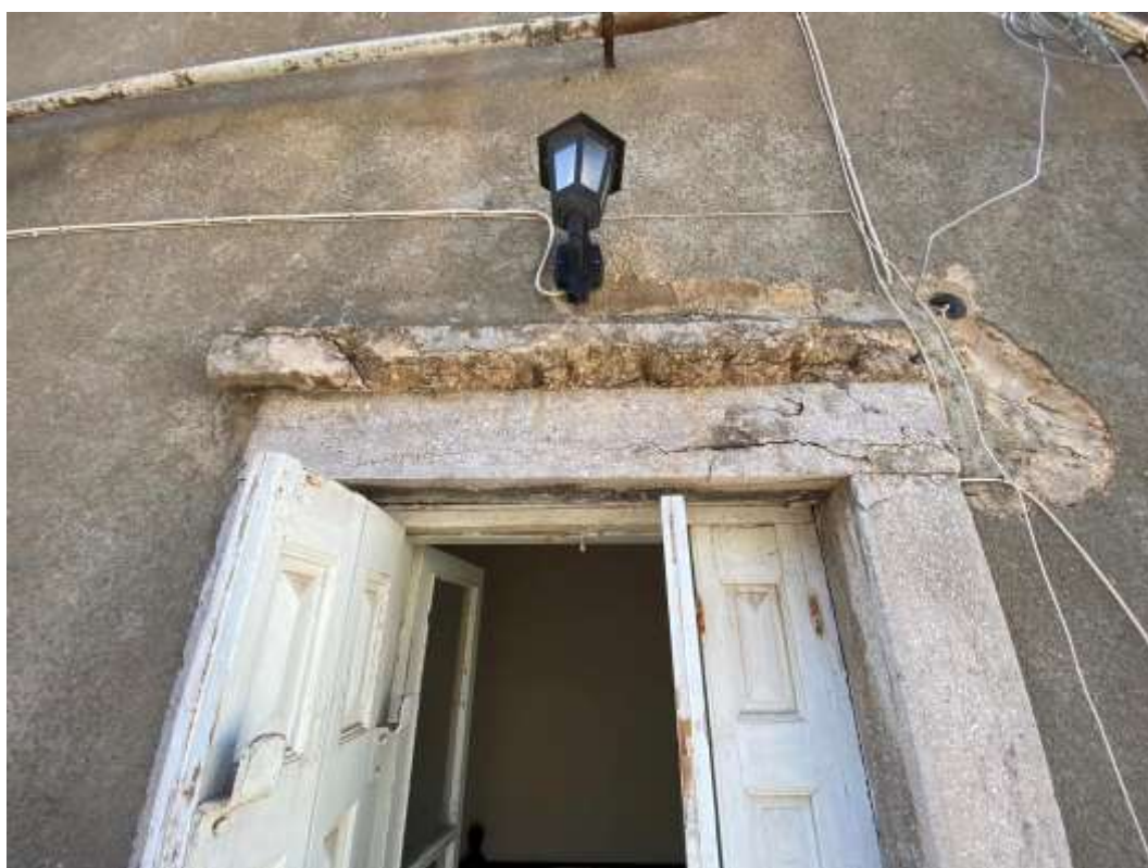
Εικ.82: Φθορά τσιμεντένιου περιθυρώματος εξώθυρας χώρου Α1Β
