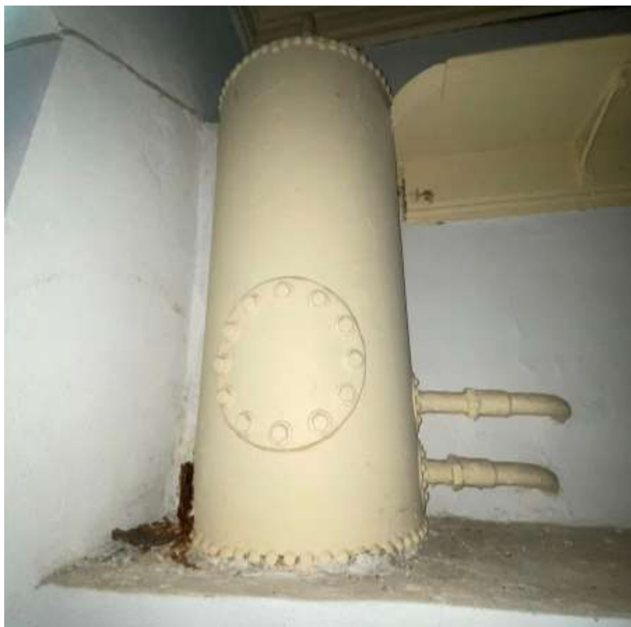
Εικ.202: Λέβητας χώρου ΙΣ6Α
