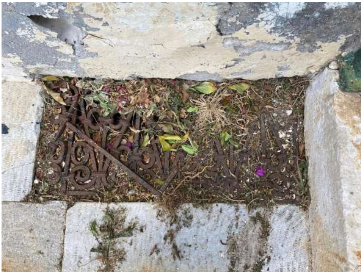
Εικ.154: Μεταλλική σχάρα καταπακτής εξαερισμού
