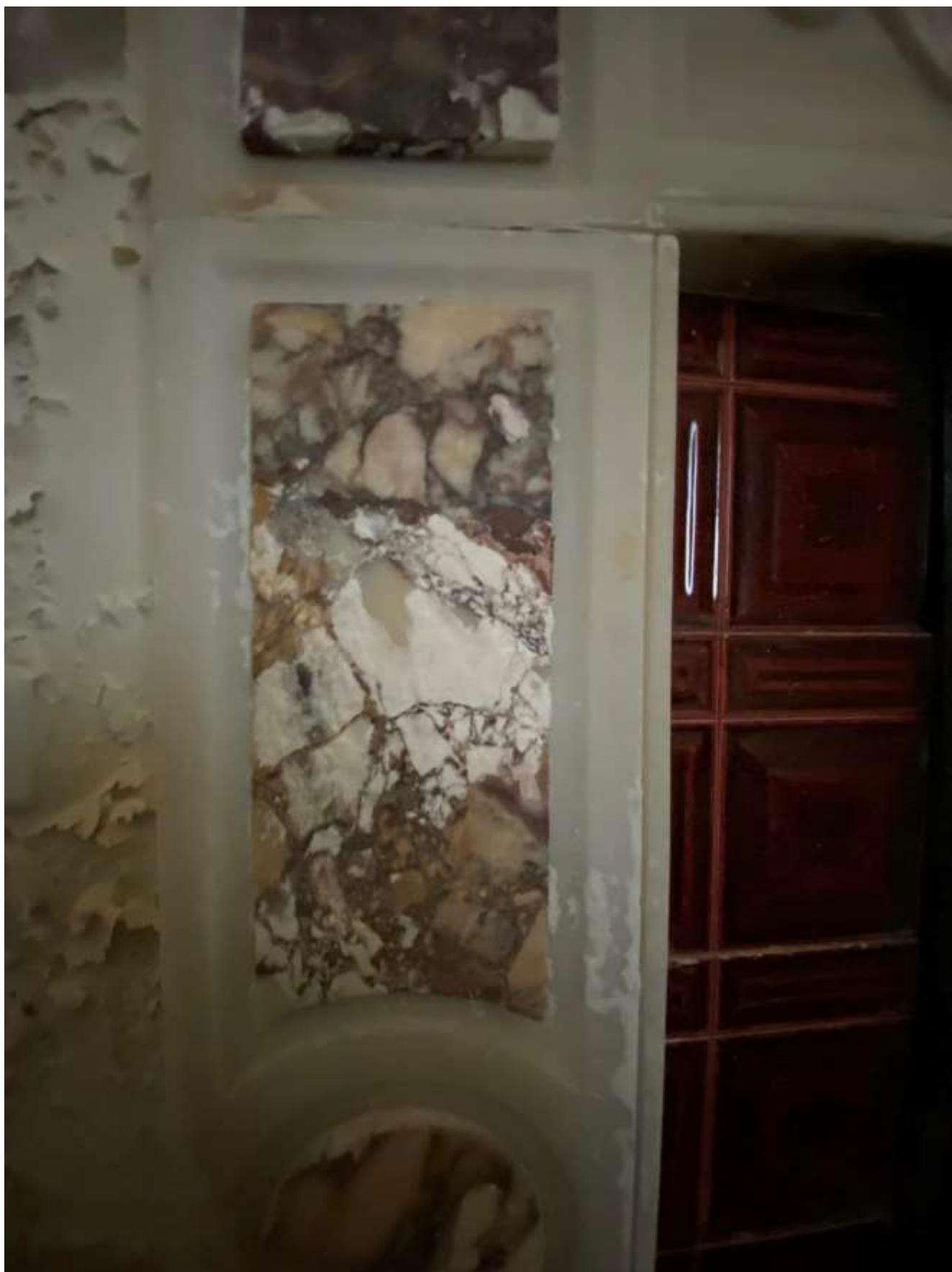
Εικ.187: Τζάκι χώρου ΙΣ3 – λεπτομέρεια: φθορά λίθινης επένδυσης
