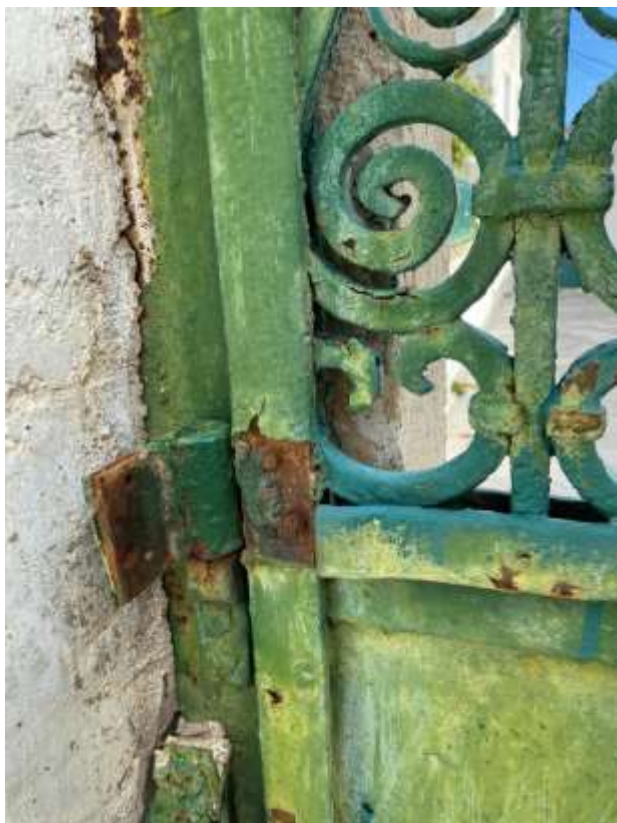
Εικ.100α: Αυλόθυρα. Λεπτομέρεια: χαλασμένος μεντεσές.
