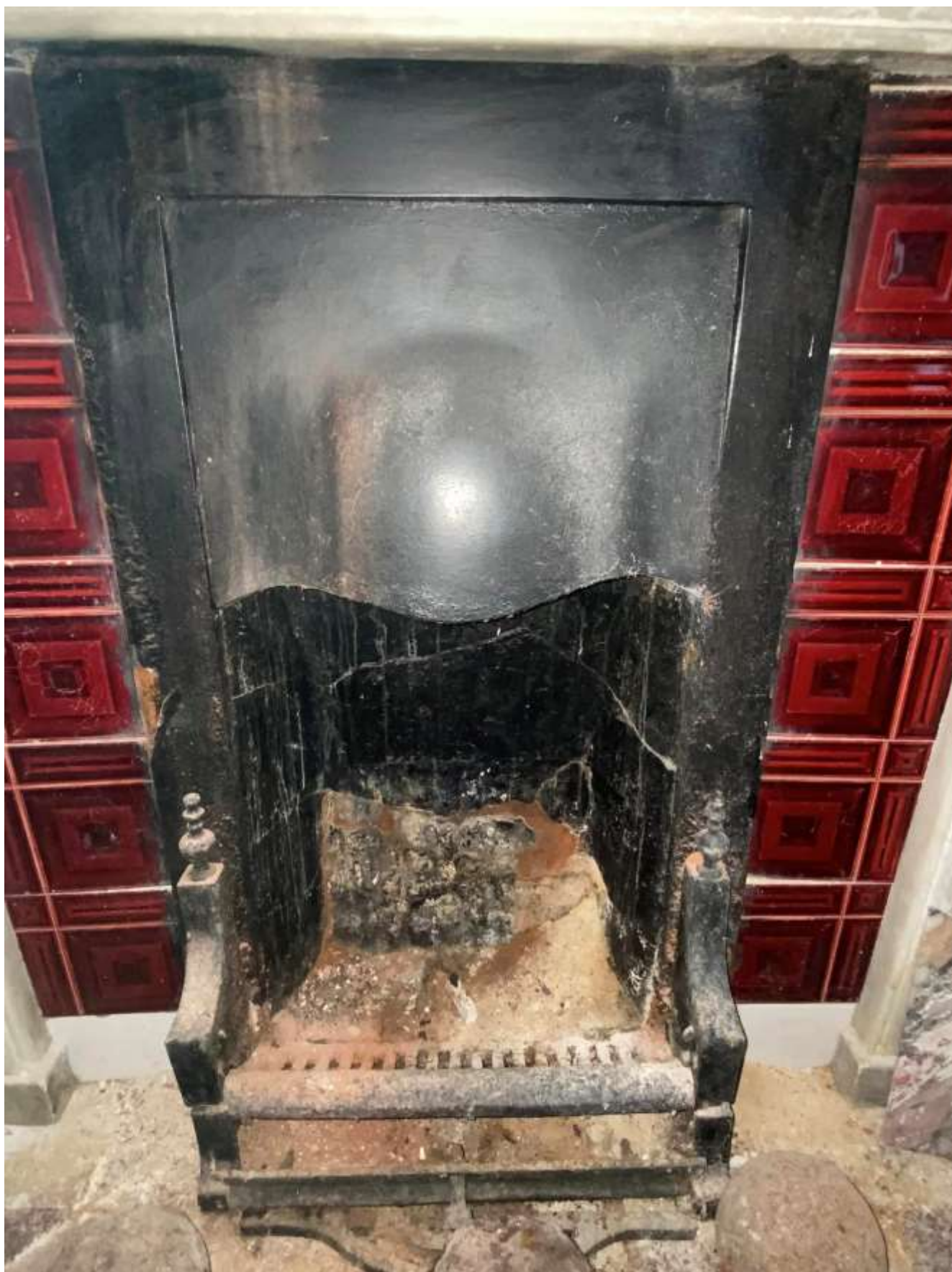
Εικ.183: Τζάκι χώρου ΙΣ3 – λεπτομέρεια: μεταλλική στόφα
