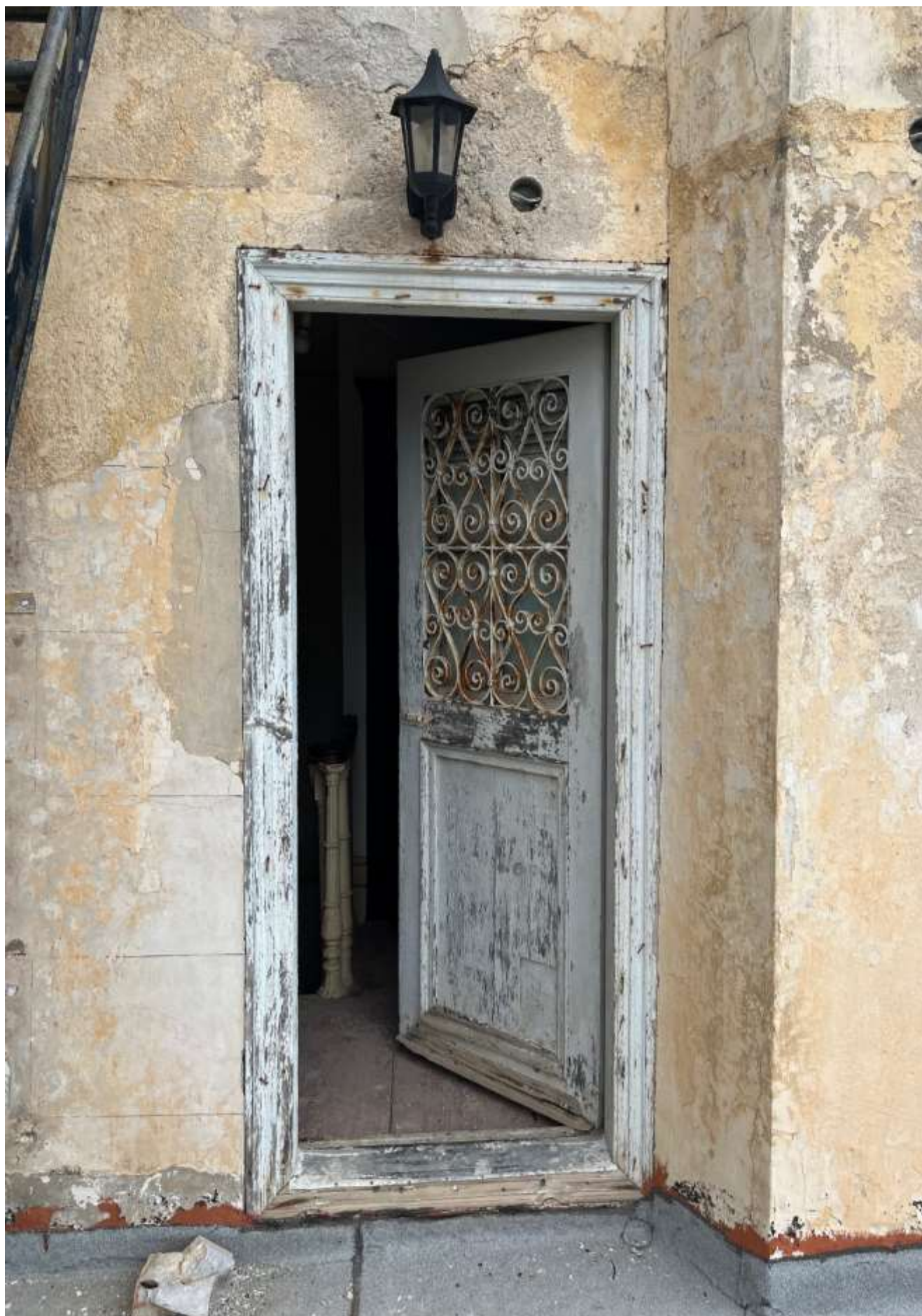
Εικ.61: Εξώθυρα χώρου Β1
