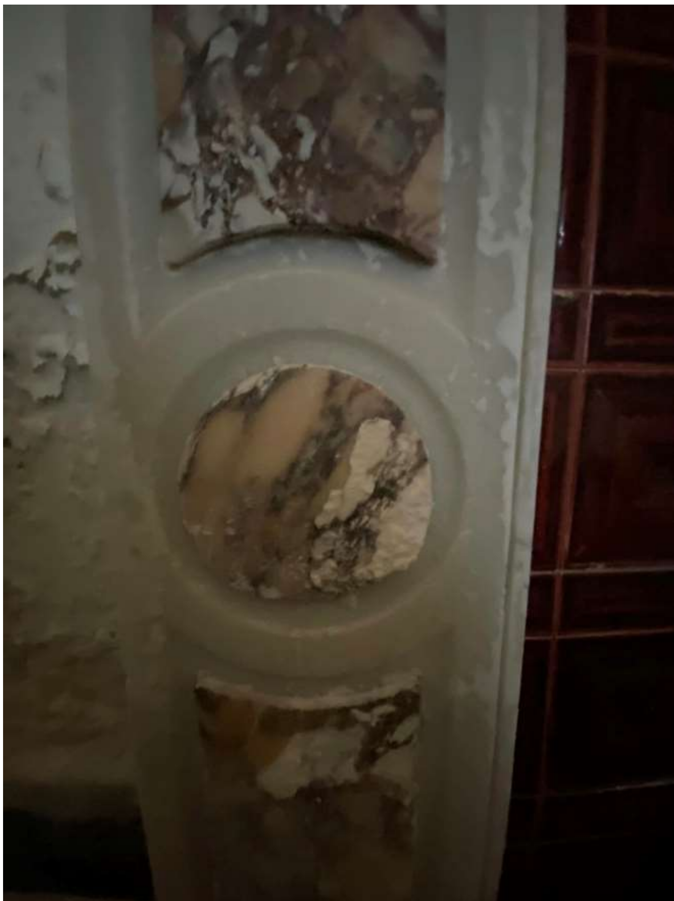
Εικ.188: Τζάκι χώρου ΙΣ3 – λεπτομέρεια: φθορά λίθινης επένδυσης
