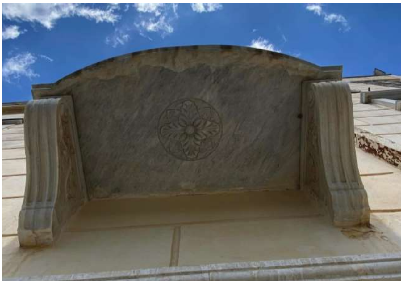
Εικ.36: Κάτω όψη εξώστη νότιας όψης χώρου Α2 (2 ου από δυτικά)
