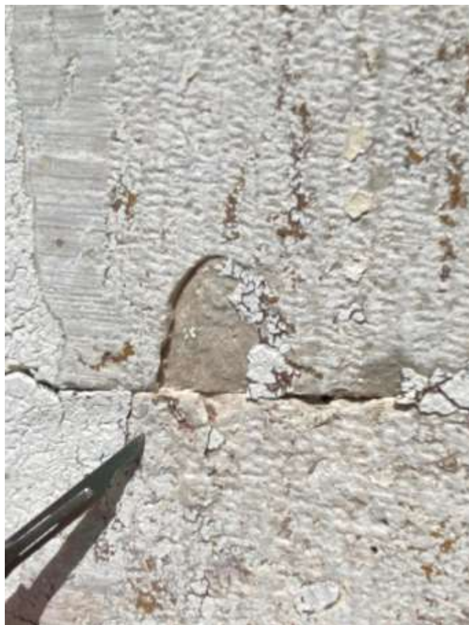
Εικ.33: Κατάσταση λίθινων μαντωμάτων
