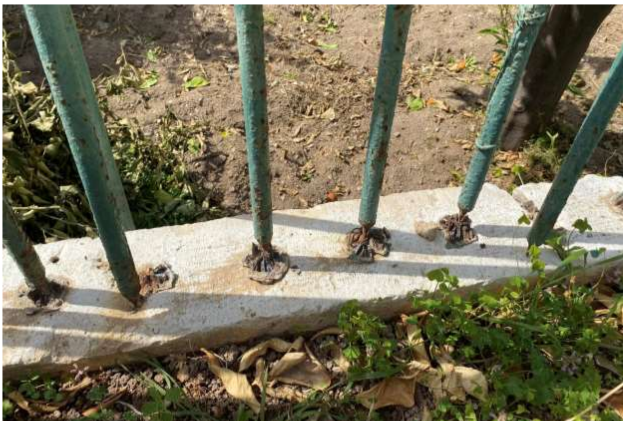
Εικ.144: Λεπτομέρεια κιγκλιδωμάτων περιβολιού: φθορά κατώτερου τμήματος
