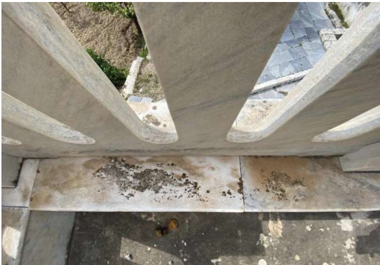
Εικ.72: Λεπτομέρεια φθοράς μαρμάρου στο στηθαίο της βεράντας της δυτικής όψης
