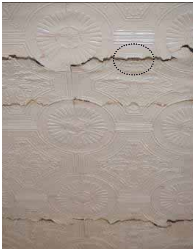
Φωτ. 217 Ρωγματώσεις και αποκολλήσεις στην ταπετσαρία της οροφής.
