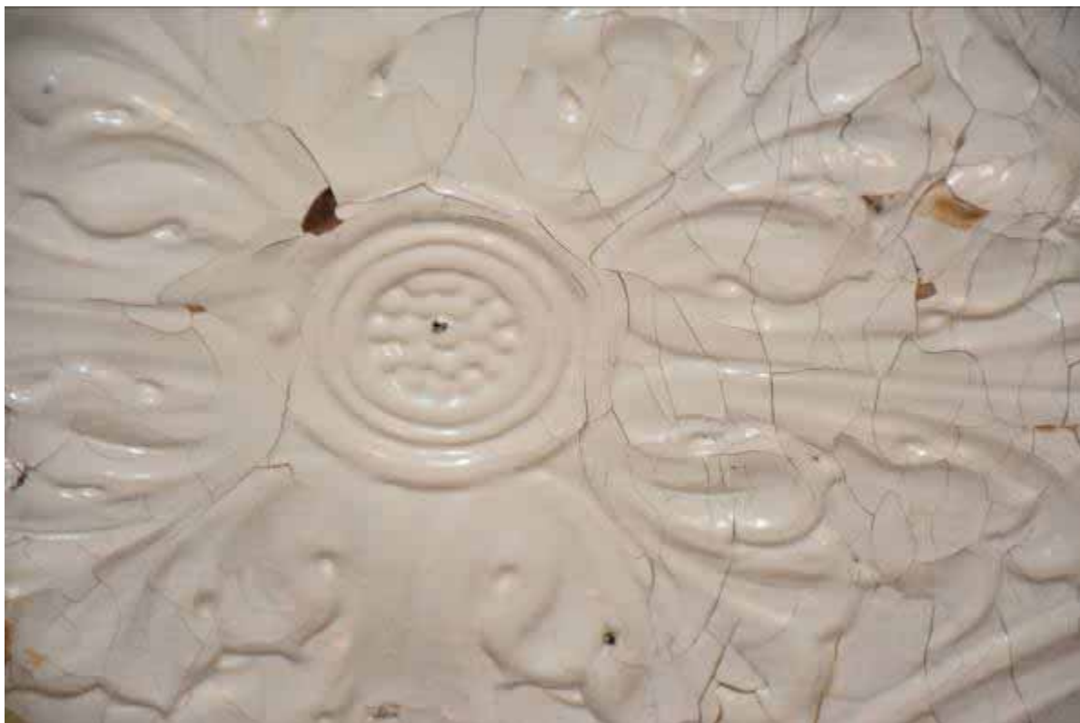
Φωτ. 221 Κρακελαρίσματα, αποκολλήσεις και απώλειες του χρωματικού στρώματος της ταπετσαρίας της οροφής.
