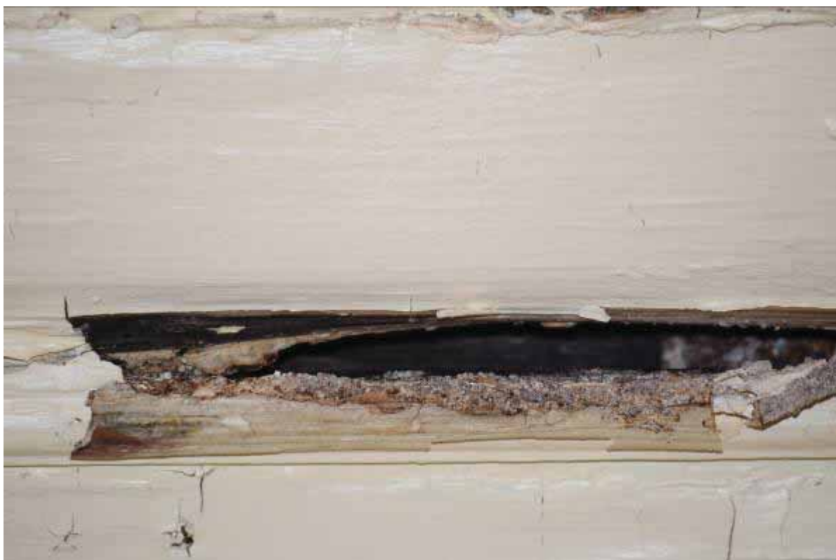
Φωτ. 316 Αποκολλήσεις, απώλειες ξύλινων τμημάτων και προσβολή από ξυλοφάγα έντομα (τερμίτες) στην οροφή του χώρου Α1.
