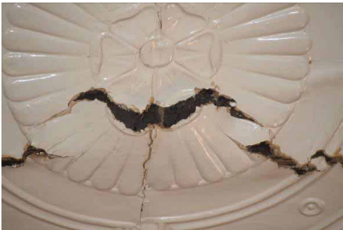
Φωτ. 216 Λεπτομέρεια της φθοράς που βρίσκεται εντός μαύρου πλαισίου στην προηγούμενη φωτογραφία.
