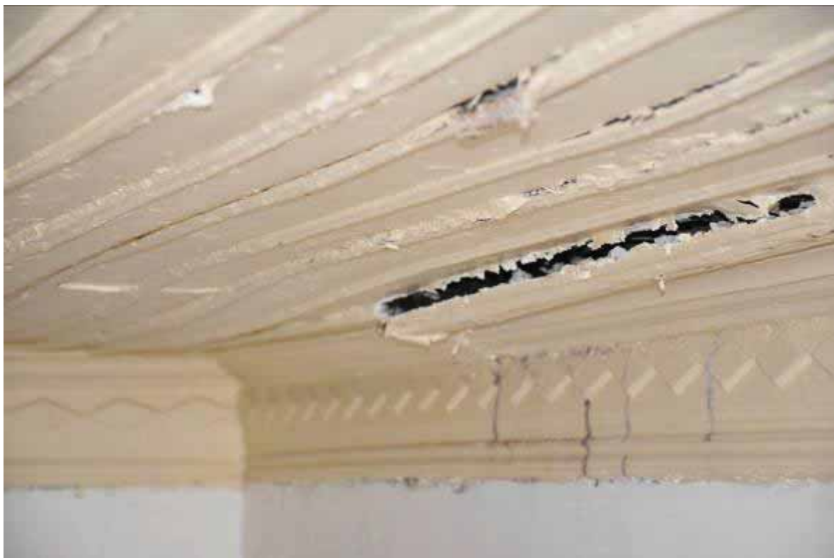
Φωτ. 307 Αποκόλληση ξύλινων τμημάτων στην οροφή του χώρου Α1.
