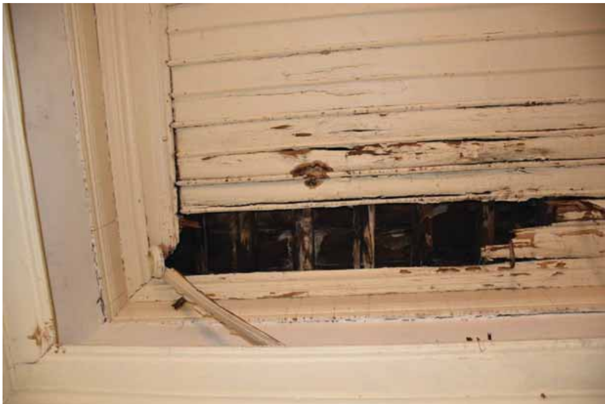
Φωτ. 8 Φθορά στην οροφή του χώρου Α6, όπου μπορούμε να διακρίνουμε τον τρόπο κατασκευής των ξύλινων οροφών και δαπέδων.
