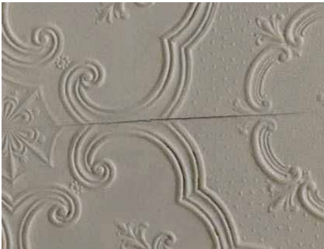
Φωτ. 207 Αποκολλημένη ταπετσαρία στην ένωση δύο τμημάτων της.
