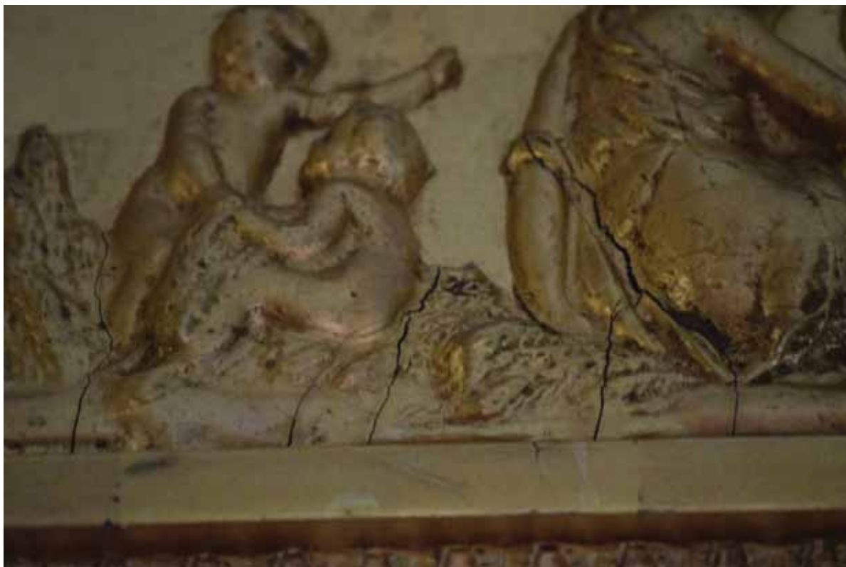
Φωτ. 496 Ρωγματώσεις και επικαθίσεις ρύπων στη γύψινη επιφάνεια των κουρτινόξυλων.
