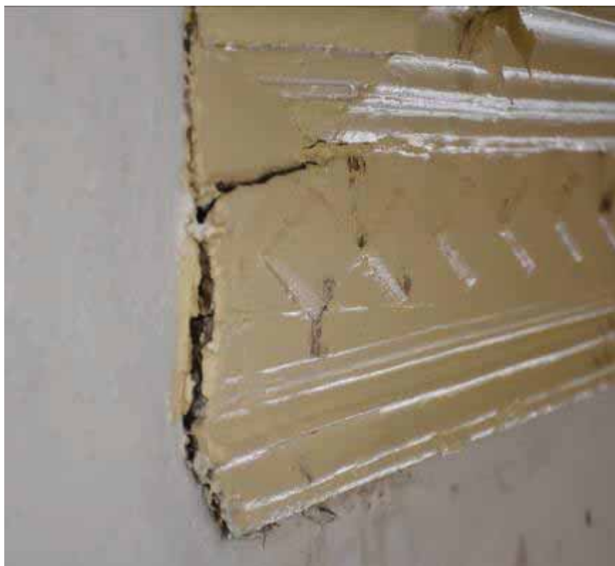
Φωτ. 308 Αποκόλληση ξύλινων τμημάτων στην οροφή του χώρου Α1.
