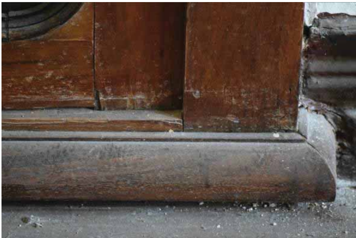
Φωτ. 471 Ρωγματώσεις, απώλεια ξύλινου φορέα κα υδρόλυση του κάτω μέρους στην ξύλινη εντοιχισμένη ντουλάπα του χώρου Α3.
