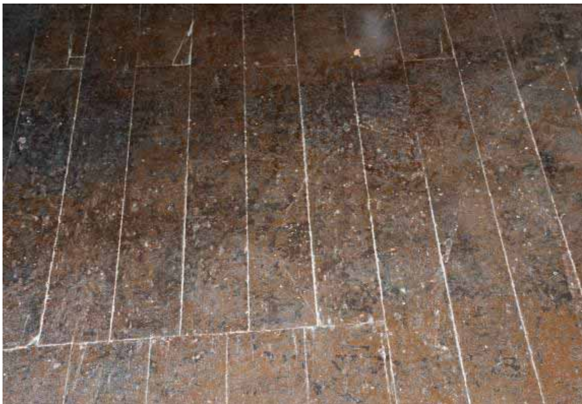
Φωτ. 357 Επάλληλα στρώματα επιχρωματισμών, ρωγματώσεις και εκδορές στο ξύλινο δάπεδο του χώρου ΙΣ2.
