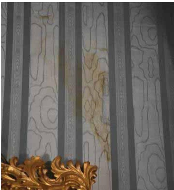
Φωτ. 228 Λεπτομέρεια της φθοράς που βρίσκεται εντός μαύρου πλαισίου στην προηγούμενη φωτογραφία.
