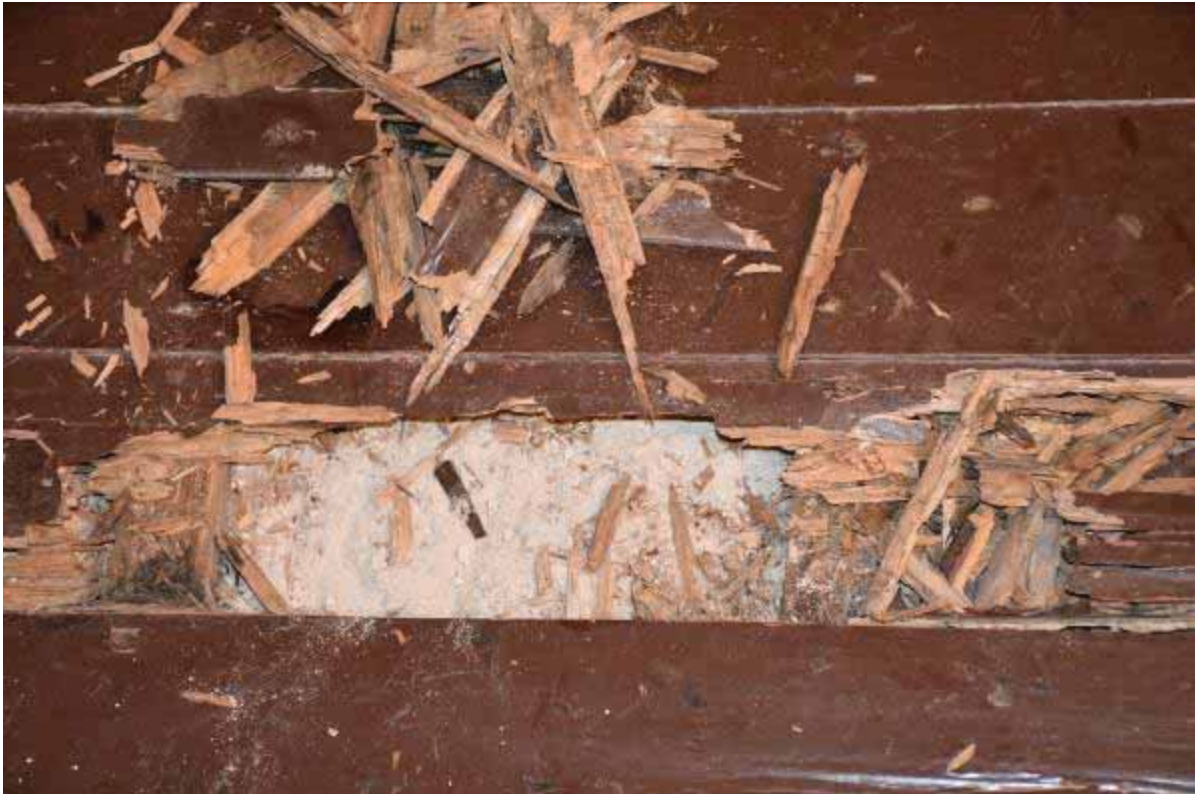
Φωτ. 351 Απώλεια ξύλινων τμημάτων και προσβολή από ξυλοφάγα έντομα (τερμίτες) στο δάπεδο του χώρου ΙΣ5.
