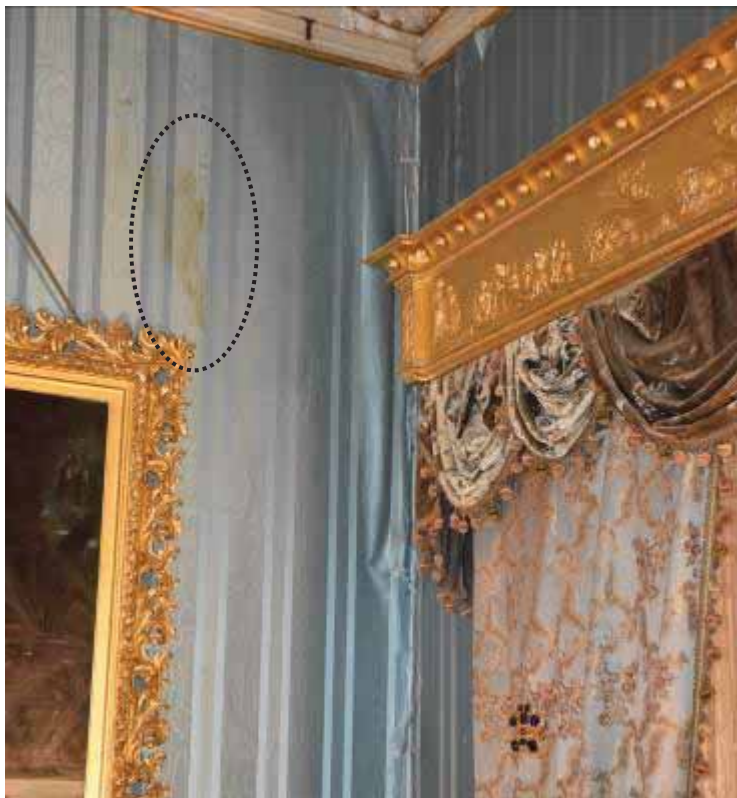
Φωτ. 227 Σκισίματα, αποκολλήσεις και λεκέδες υγρασίας στην ταπετσαρία των τοίχων.
