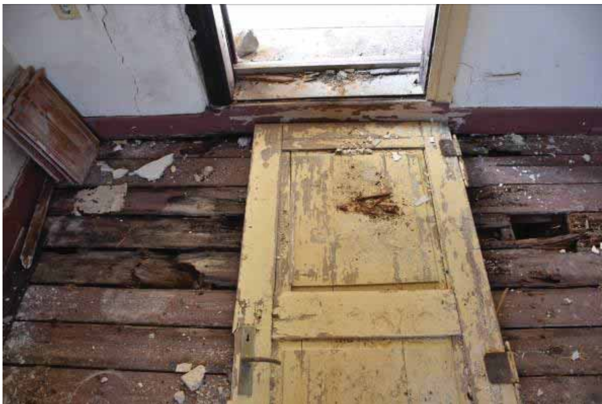
Φωτ. 353 Απώλεια ξύλινων τμημάτων και προσβολή από ξυλοφάγα έντομα στο δάπεδο του χώρου B2.
