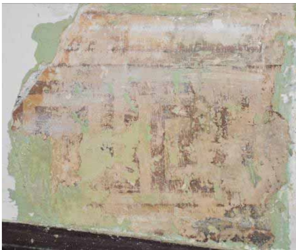
Φωτ. 189 Κονιορτοποιημένο και αποχρωματισμένο ζωγραφικό στρώμα.
