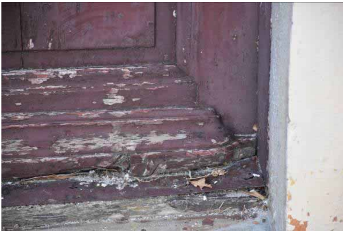
Φωτ. 399 Ρωγματώσεις, υδρόλυση του ξύλινου φορέα και απώλεια χρωστικών μέχρι την επιφάνεια του ξύλου στην εξωτερική πλευρά της ξύλινης εξώθυρας του χώρου ΙΣ7.
