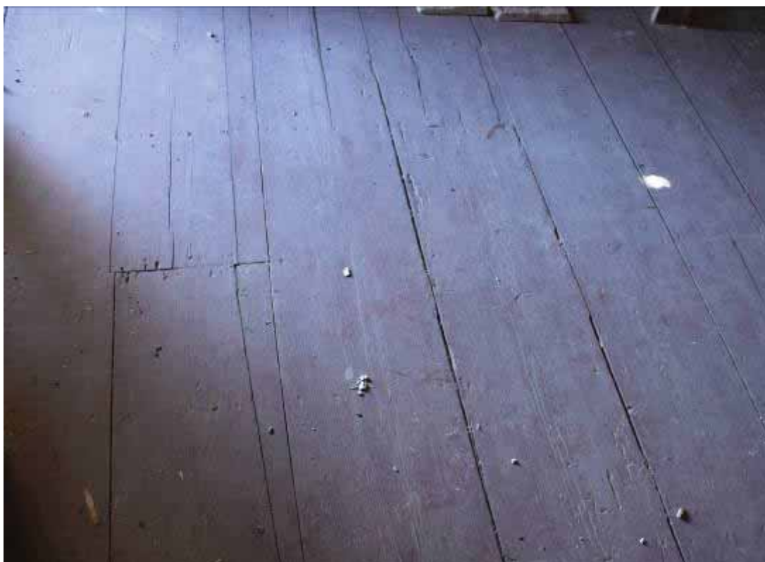
Φωτ. 362 Ρωγματώσεις, εκδορές και οξειδωμένοι μεταλλικοί σύνδεσμοι στο ξύλινο δάπεδο του χώρου Β4.
