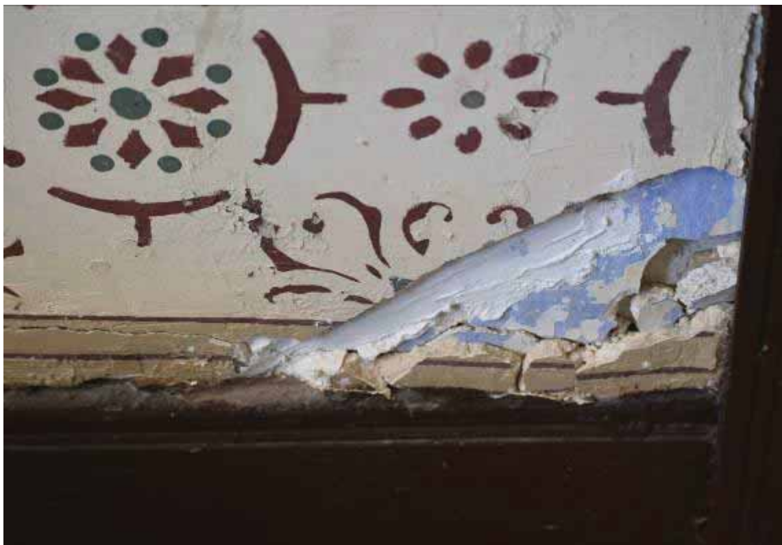
Φωτ. 95 Ρωγματώσεις, απώλειες κονιάματος μαζί με τη ζωγραφική επιφάνεια και πλήρωση απωλειών με νεότερα κονιάματα στο πασαμέντο του χώρου ΙΣ1α.
