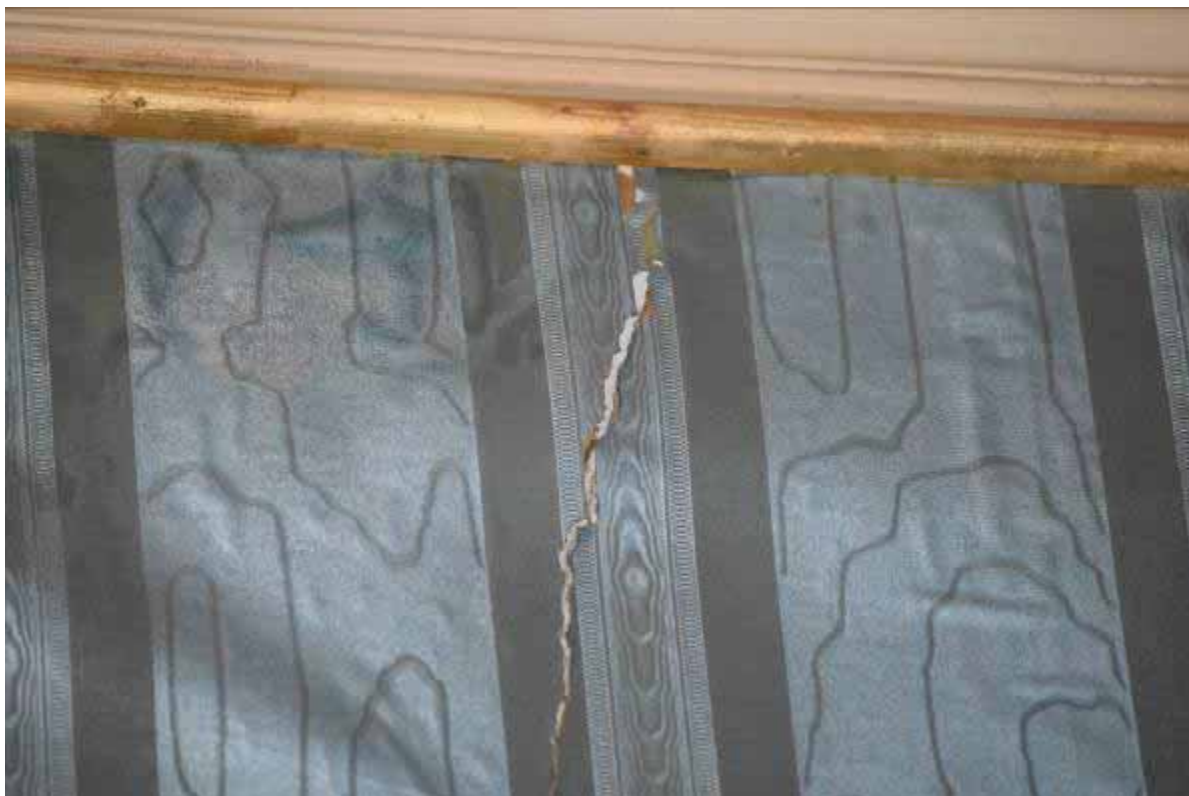
Φωτ. 229 Σκισίματα και αποκολλήσεις στην ταπετσαρία των τοίχων.
