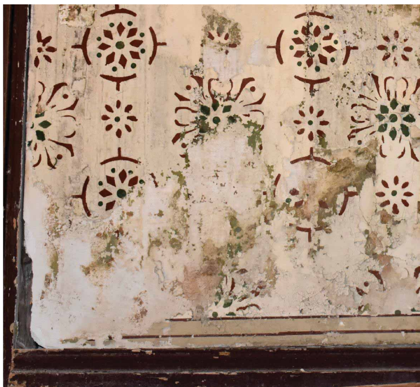
Φωτ. 158 Λεκέδες υγρασίας, συμπλήρωση απώλειας με νεότερο τσιμεντοκονίαμα, σαθροποιημένο υπόστρωμα, αποκολλημένο, αποχρωματισμένο και κονιορτοποιημένο ζωγραφικό στρώμα
