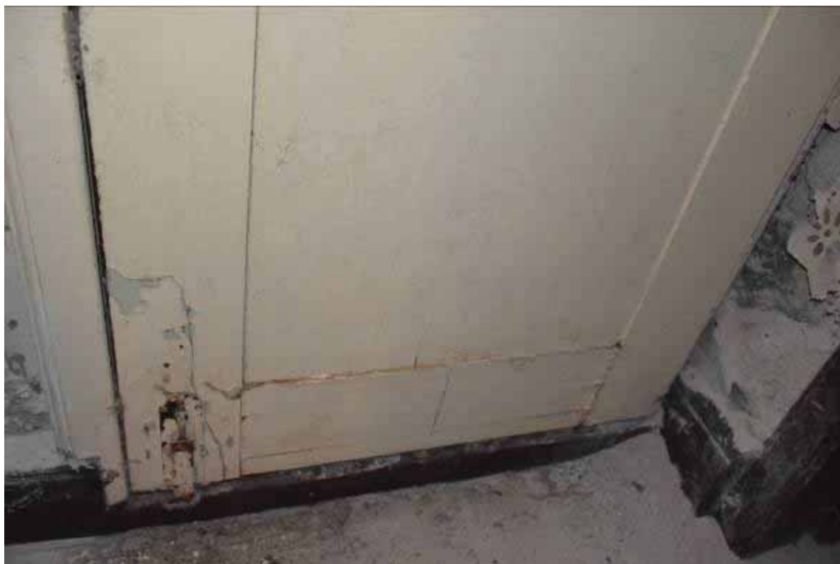
Φωτ. 401 Ρωγματώσεις, οξειδωμένοι σύνδεσμοι και απώλεια χρωστικών μέχρι την επιφάνεια του ξύλου στην εσωτερική πλευρά της ξύλινης εξώθυρας του χώρου ΙΣ7.
