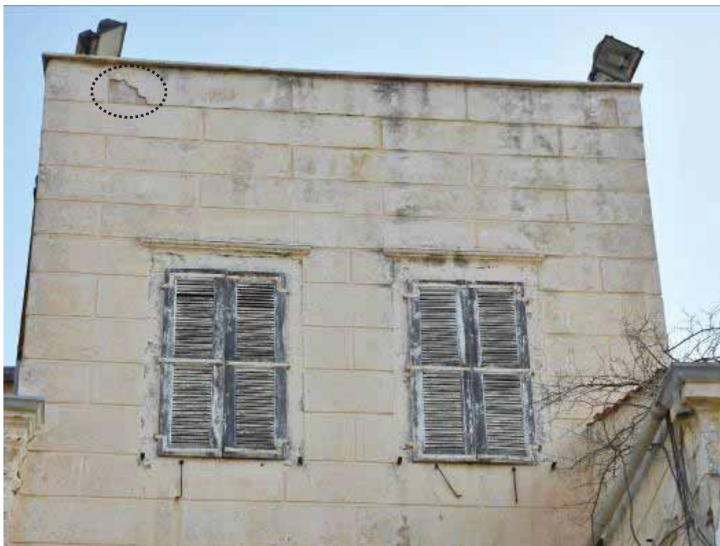
Φωτ. 37 Ρηγματώσεις, αποκολλήσεις, κονιορτοποιήσεις, απώλειες και ανάπτυξη βιολογικών επικαθίσεων στο επίχρυσμα της νότιας όψης.
