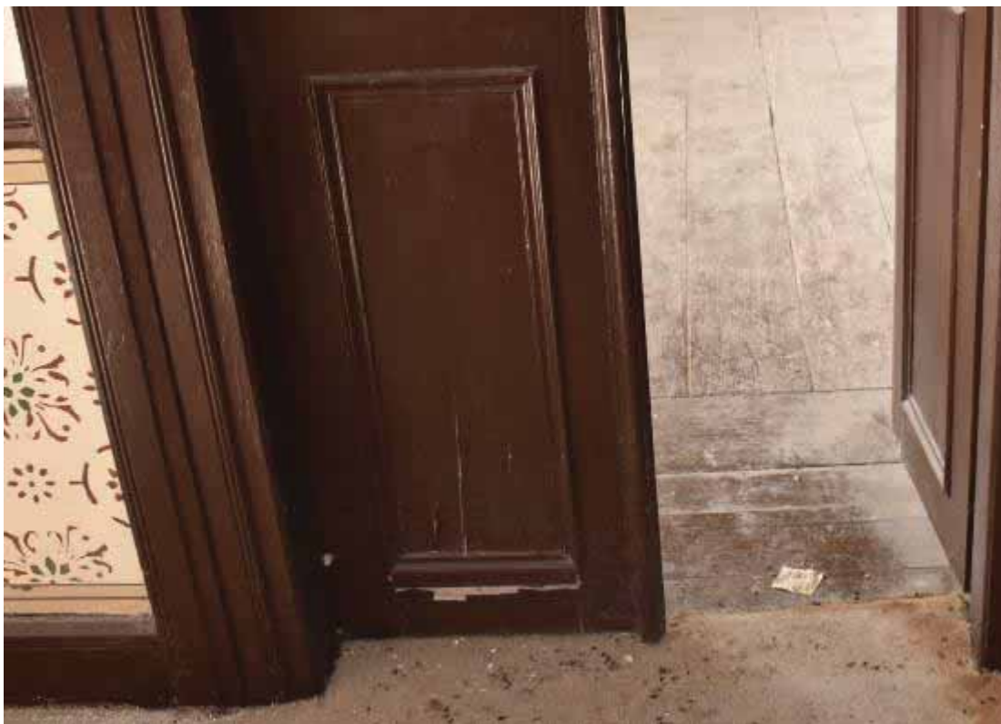
Φωτ. 402 Ρωγματώσεις και απώλεια χρωστικών μέχρι την επιφάνεια του ξύλου στη θύρα του χώρου Α3.
