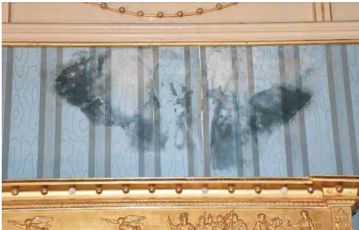
Φωτ. 232 Σκισίματα, αποκολλήσεις, αποχρωματισμοί και ανάπτυξη βιολογικών παραμέτρων και μυκήτων στην ταπετσαρία των τοίχων.
