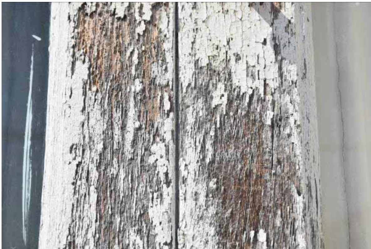
Φωτ. 457 Υδρόλυση του ξύλινου φορέα, αποχρωματισμός των εξωτερικών ξύλινων επιφανειών και απώλειες, αποκολλήσεις και κρακελαρίσματα των χρωματικών στρωμάτων στην εξωστόθουρα του χώρου B4.
