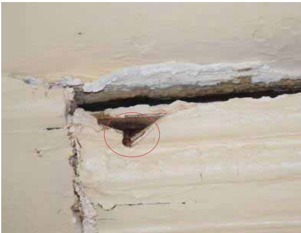
Φωτ. 319 Αποκόλληση ξύλινων τμημάτων και οξειδωμένοι μεταλλικοί σύνδεσμοι στην οροφή του χώρου Α1.
