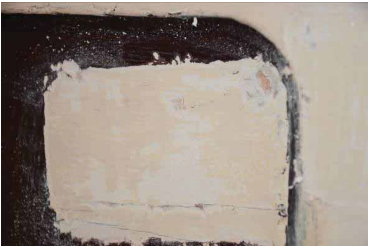
Φωτ. 252 Ρωγματώσεις και επάλληλα στρώματα επιχρωματισμών.
