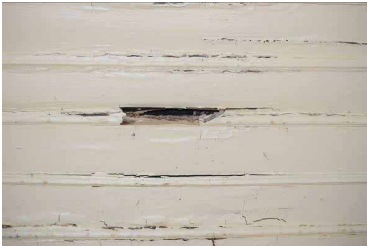
Φωτ. 317 Ρωγματώσεις, απώλειες ξύλινων τμημάτων και προσβολή από ξυλοφάγα έντομα (τερμίτες) στην οροφή του χώρου Α1.
