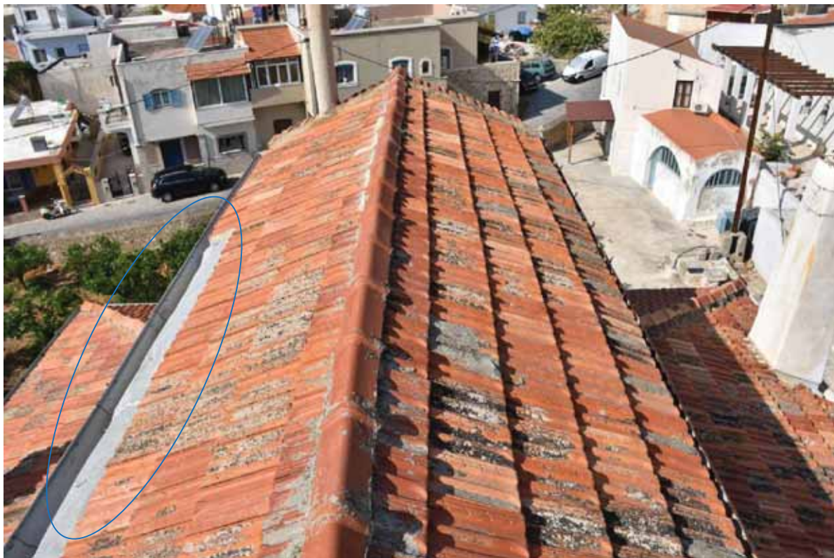
Φωτ. 485 Η κακή διατήρηση της στέγης (απώλειες κεραμιδιών, σπασμένα κεραμίδια) επέτρεψε την είσοδο υγρασίας στο εσωτερικό του κτηρίου.
