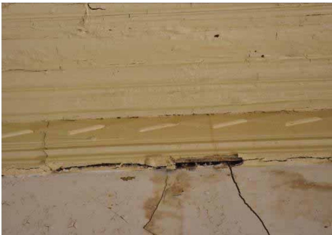
Φωτ. 318 Αποκολλήσεις, απώλειες ξύλινων τμημάτων και προσβολή από ξυλοφάγα έντομα (τερμίτες) στην οροφή του χώρου Α1.
