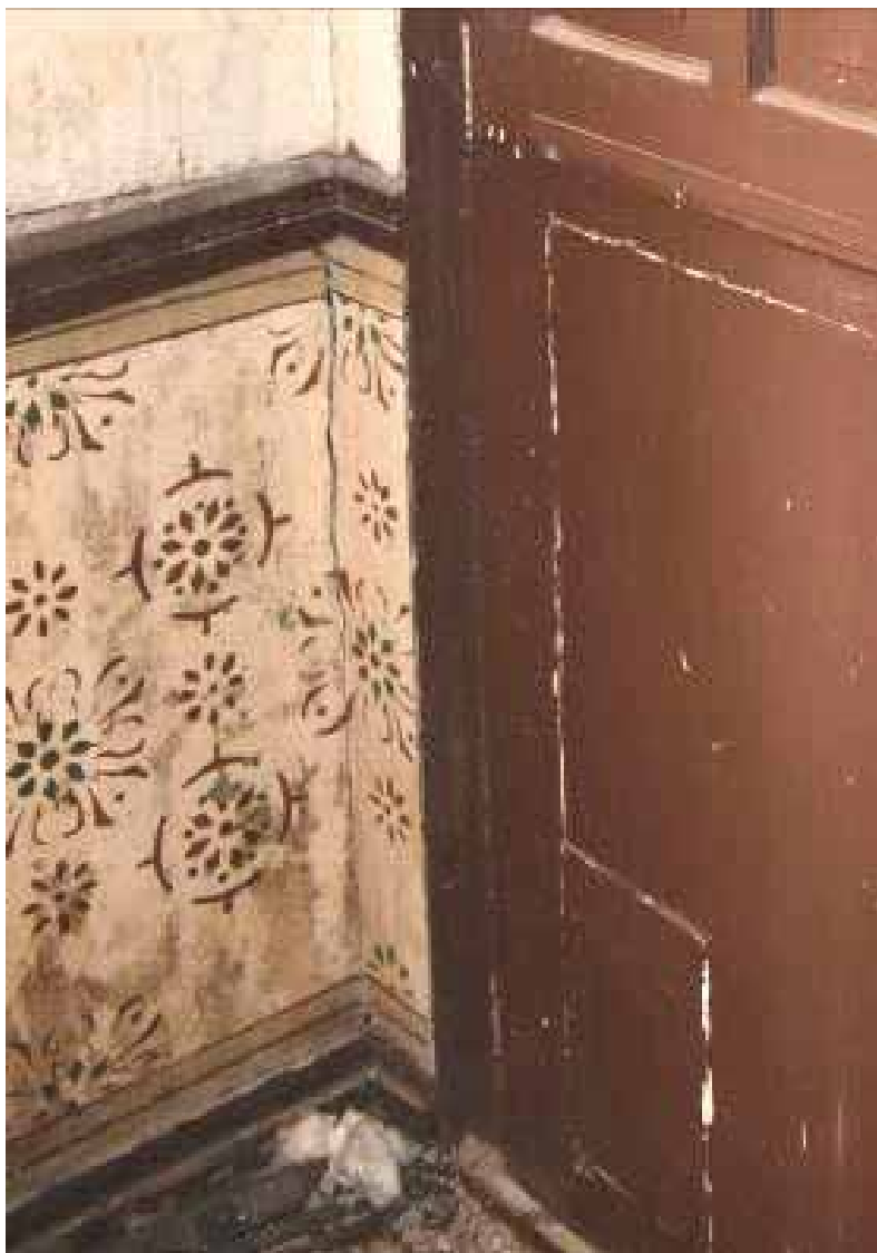
Φωτ. 159 Λεκέδες υγρασίας, ρωγμάτωση, σαθροποιημένο υπόστρωμα, αποκολλημένο, αποχρωματισμένο και κονιορτοποιημένο ζωγραφικό στρώμα
