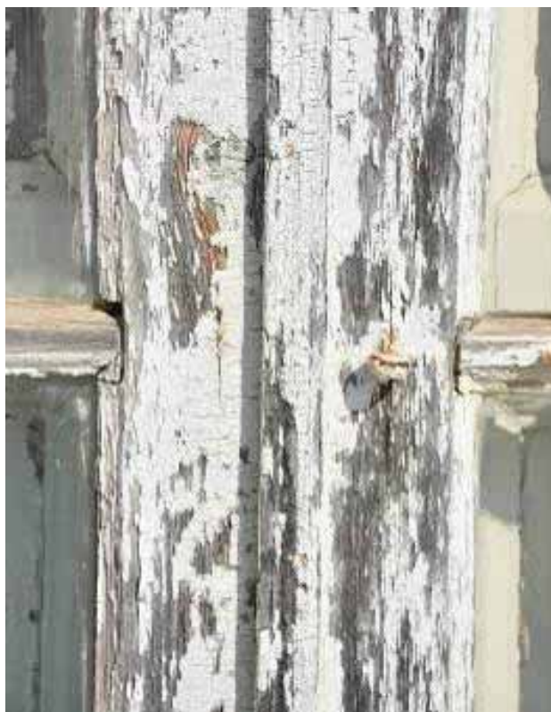
Φωτ. 458 Υδρόλυση του ξύλινου φορέα, αποχρωματισμός των εξωτερικών ξύλινων επιφανειών και απώλειες, αποκολλήσεις και κρακελαρίσματα των χρωματικών στρωμάτων σε άνοιγμα του χώρου B2.
