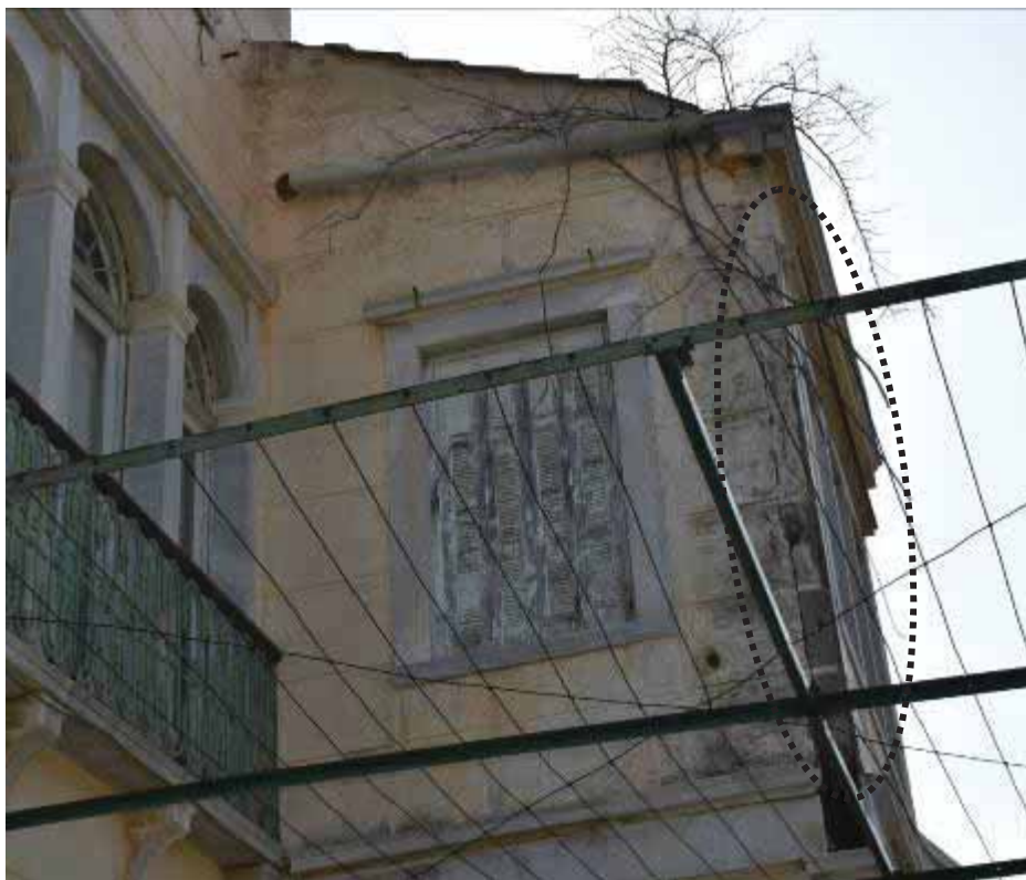
Φωτ. 33 Ρηγματώσεις, αποκολλήσεις και απώλειες στο επίχρυσμα της νότιας όψης.
