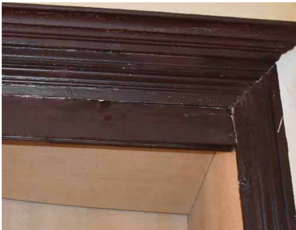
Φωτ. 472 Ρωγματώσεις, απώλεια χρωματικών στρωμάτων και κηλιδώσεις από νεότερες χρωστικές στην ξύλινη εντοιχισμένη ντουλάπα του χώρου Α6.
