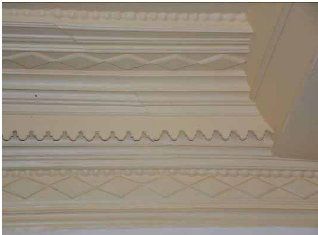
Φωτ. 268 Το γείσο της οροφής του χώρου ΙΣ2.
