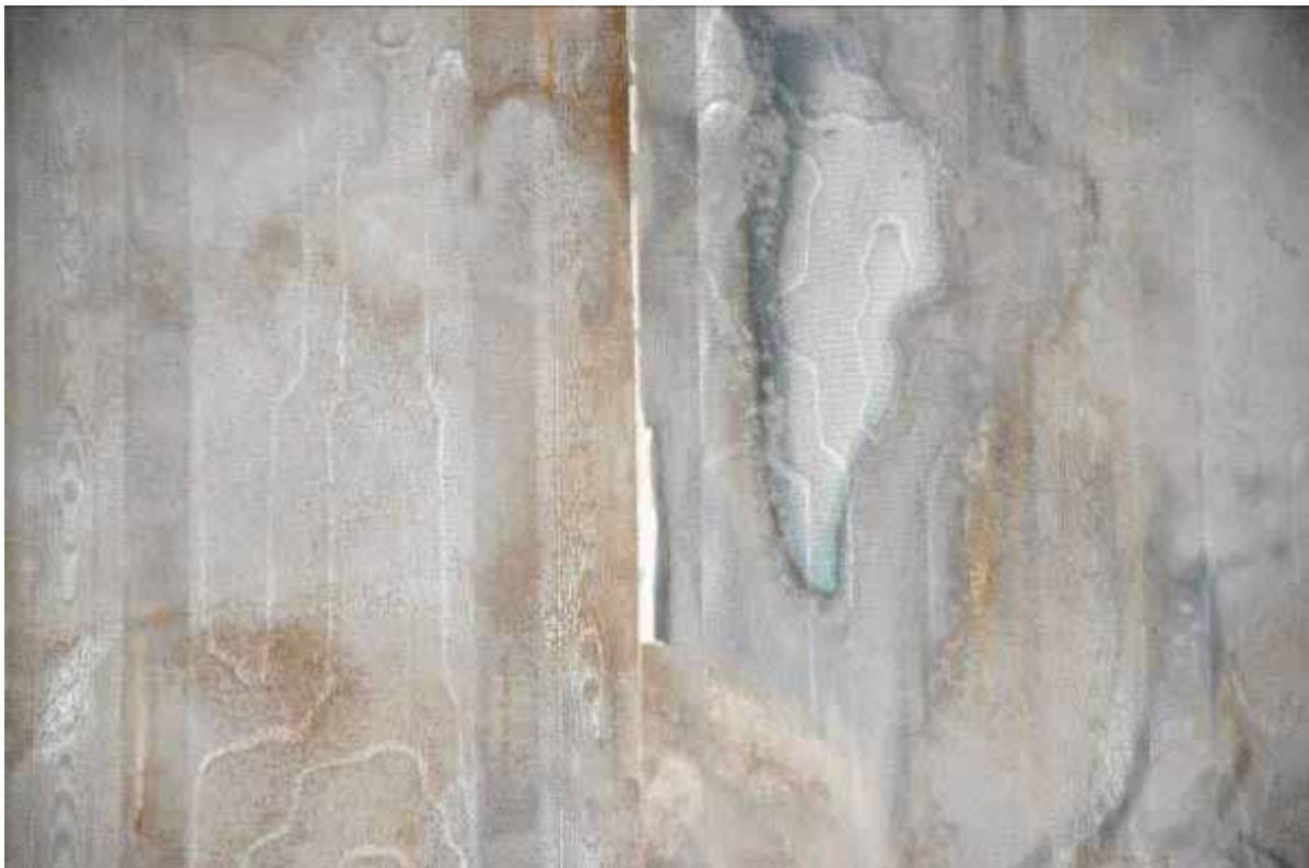
Φωτ. 224 Λεπτομέρεια της φθοράς που βρίσκεται εντός μαύρου πλαισίου στην προηγούμενη φωτογραφία.
