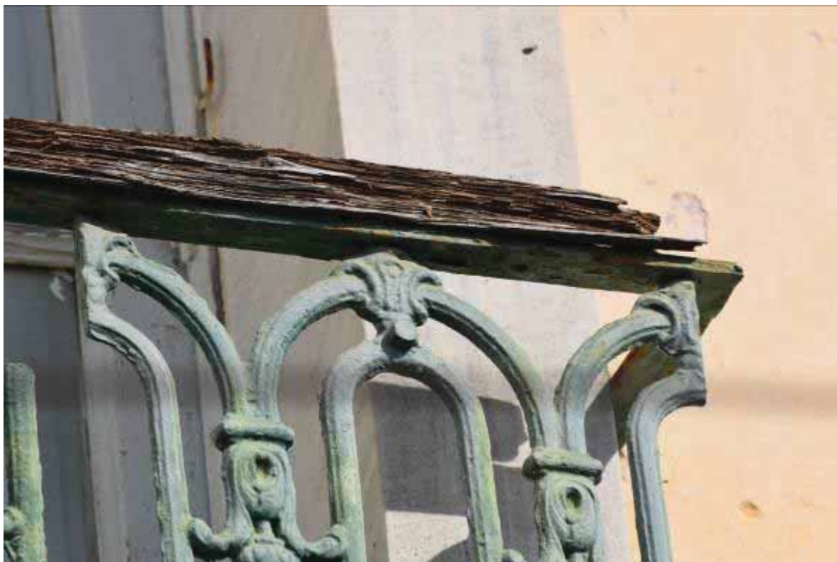
Φωτ. 481 Προσβολή από ξυλοφάγα έντομα, απώλειες ξύλινων τμημάτων, υδρολυμένος και αποσασθροποιημένος ξύλινος φορέας στην κουπαστή του εξώστη του χώρου Α5.
