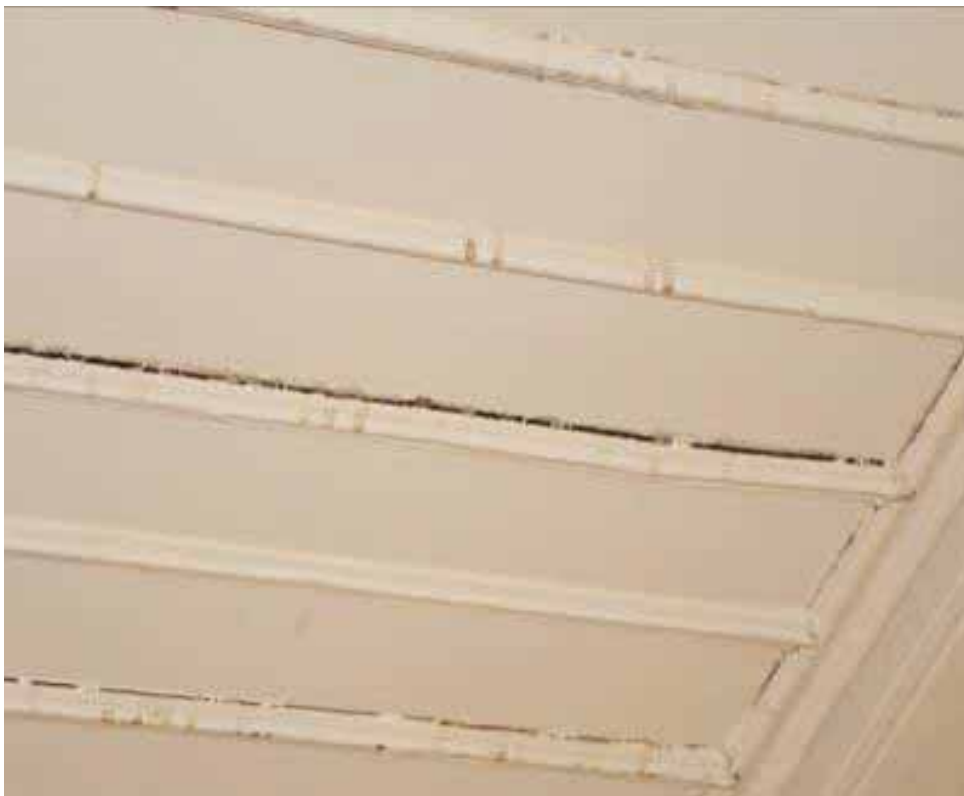
Φωτ. 309 Αποκόλληση ξύλινων τμημάτων στην οροφή του χώρου 1S4.
