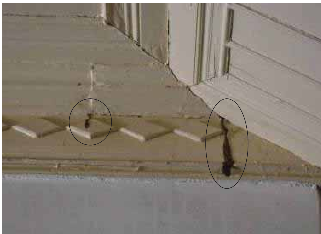
Φωτ. 314 Περιττωματικά υλικά (φαγωμένο ξύλο και ακαθαρσίες) από ξυλοφάγα έντομα (τερμίτες) στην οροφή του χώρου ΙΣ1α.
