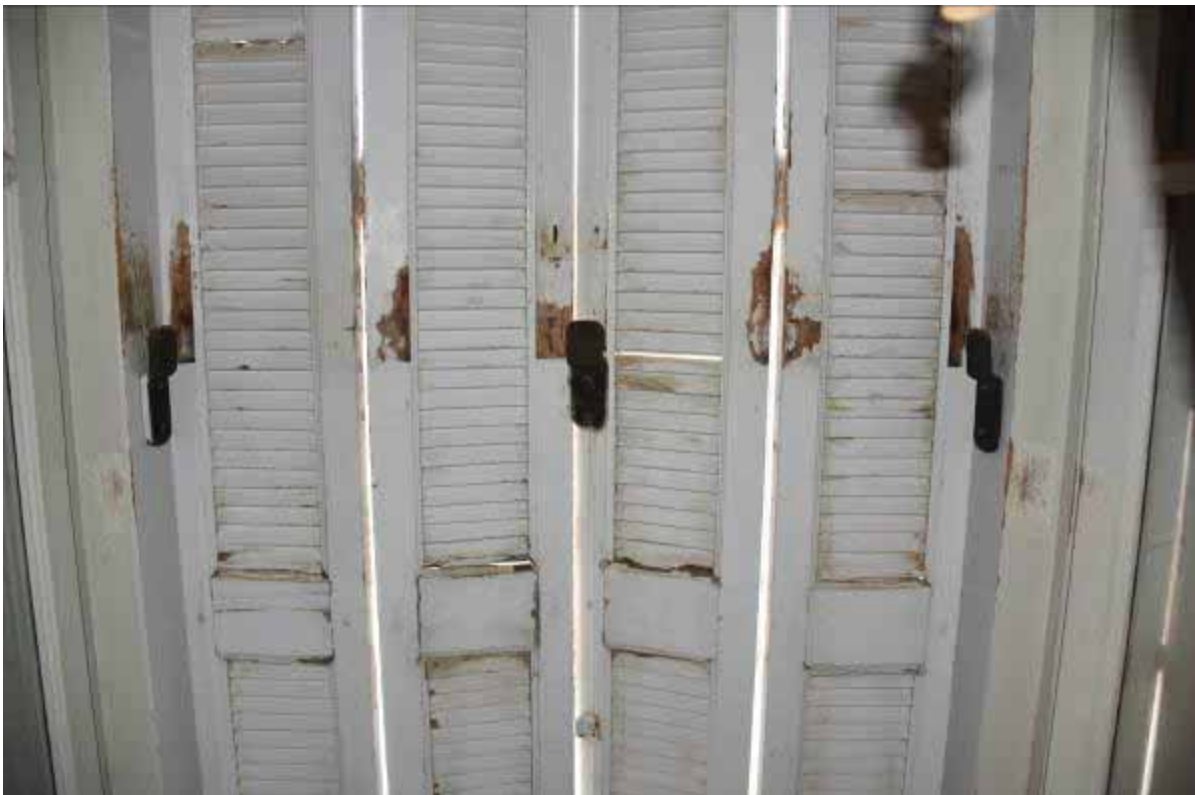
Φωτ. 464 Ρωγματώσεις, απώλεια χρωματικού στρώματος και εκδορές από τη χρήση της μεταλλικής μπάρας σφράγισης της εξωστόθυρας του χώρου Α2.
