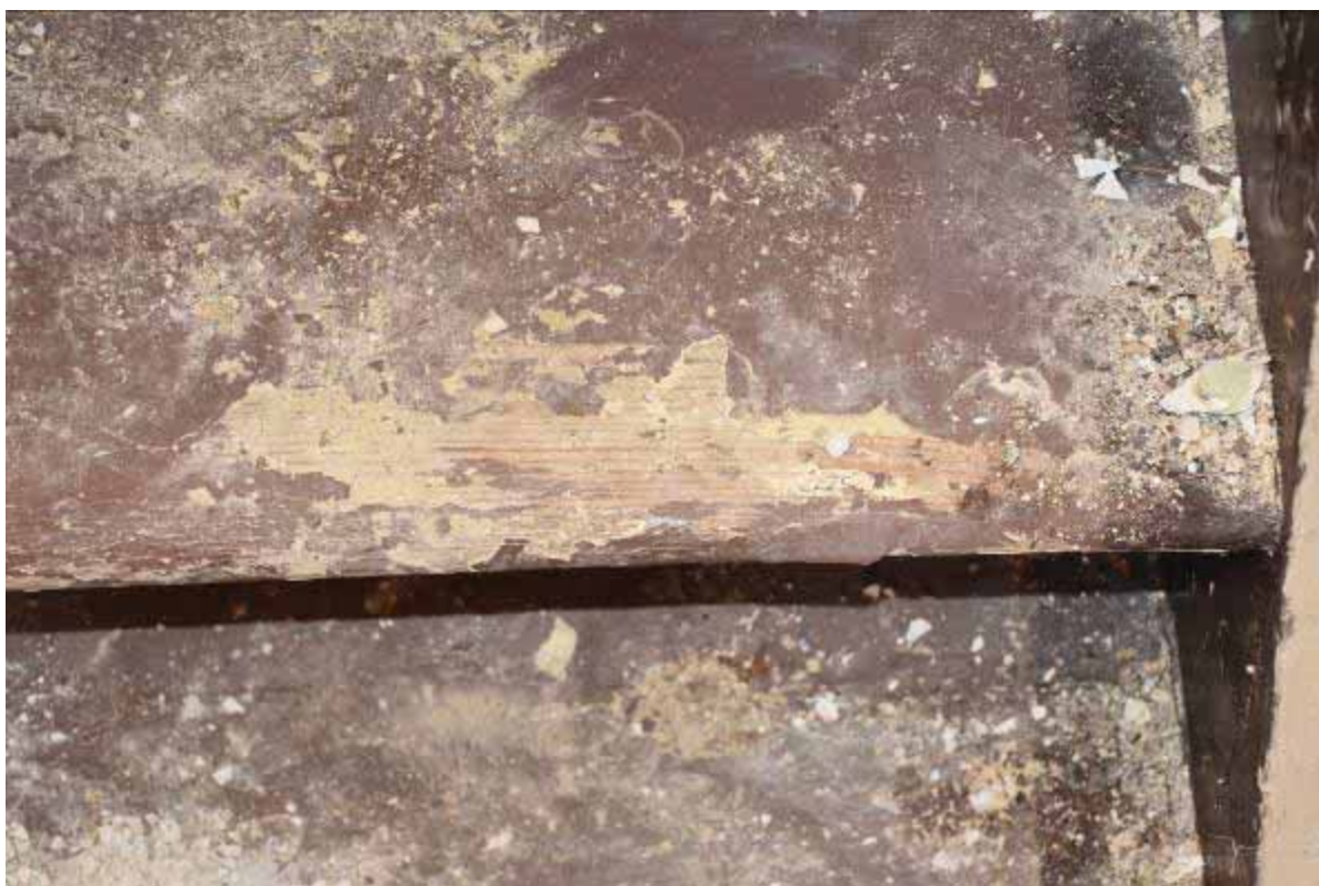
Φωτ. 255 Απώλεια χρωματικών στρωμάτων μέχρι την επιφάνεια του ξύλου.
