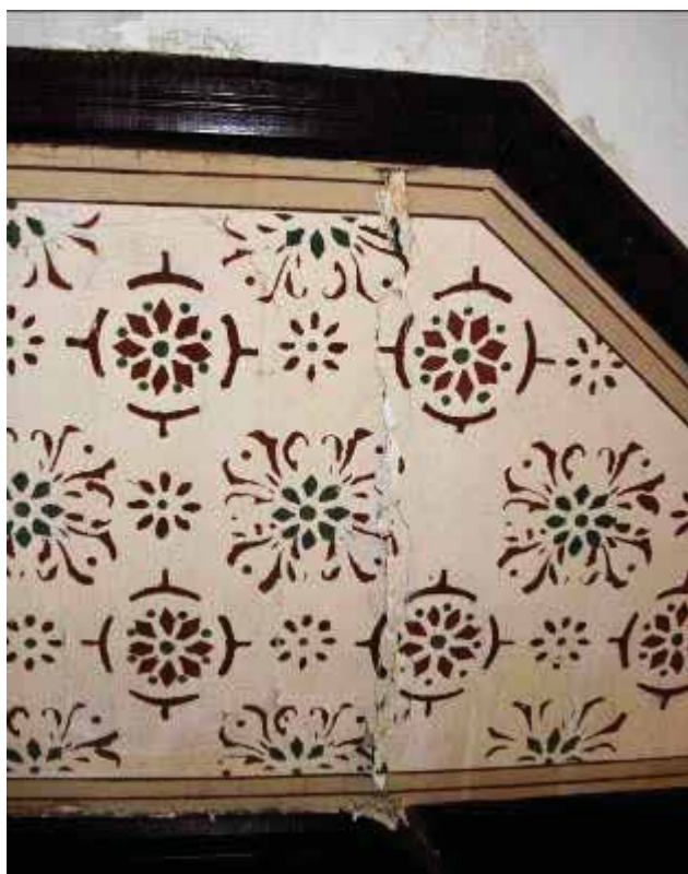
Φωτ. 133 Ρωγματώσεις στο πασαμέντο του χώρου Α1α.
