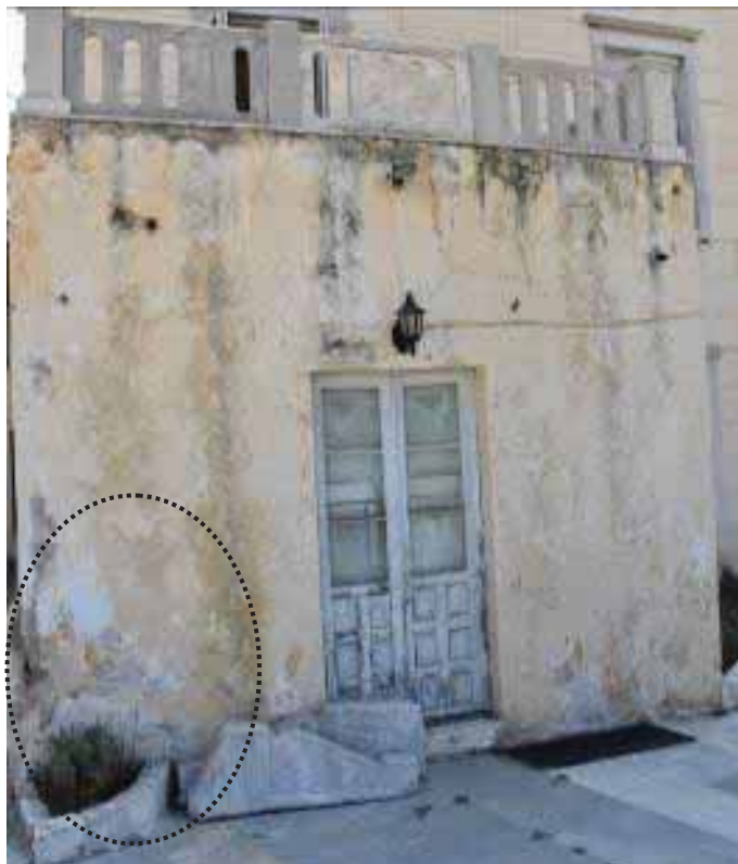
Φωτ. 47 Ρηγματώσεις, αποκολλήσεις, κονιορτοποιήσεις, απώλειες και ανάπτυξη βιολογικών επικαθίσεων στο επίχρισμα της δυτικής όψης.
