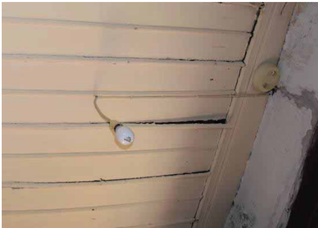
Φωτ. 310 Αποκόλληση ξύλινων τμημάτων και ηλεκτρολογική εγκατάσταση στην οροφή του χώρου B1.
