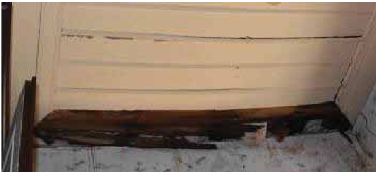
Φωτ. 313 Απώλειες και αποκολλήσεις ξύλινων τμημάτων, υδρόλυση του ξύλινου φορέα και προσβολή από σηπτικούς μύκητες στην οροφή του χώρου Α6.
