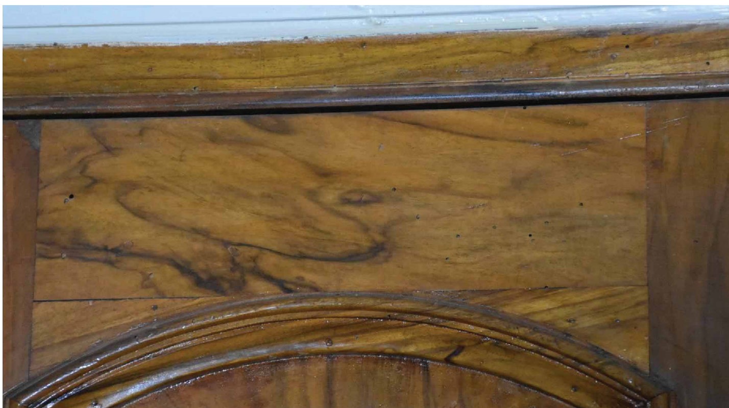
Φωτ. 403 Προσβολή από ξυλοφάγα έντομα στη θύρα του χώρου Α2.
