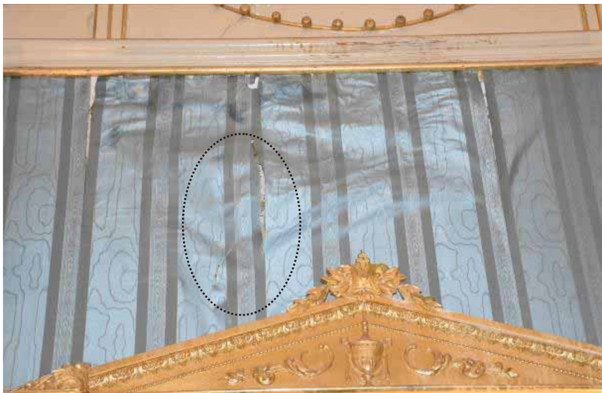
Φωτ. 225 Σκισίματα και αποκολλήσεις στην ταπετσαρία των τοίχων.
