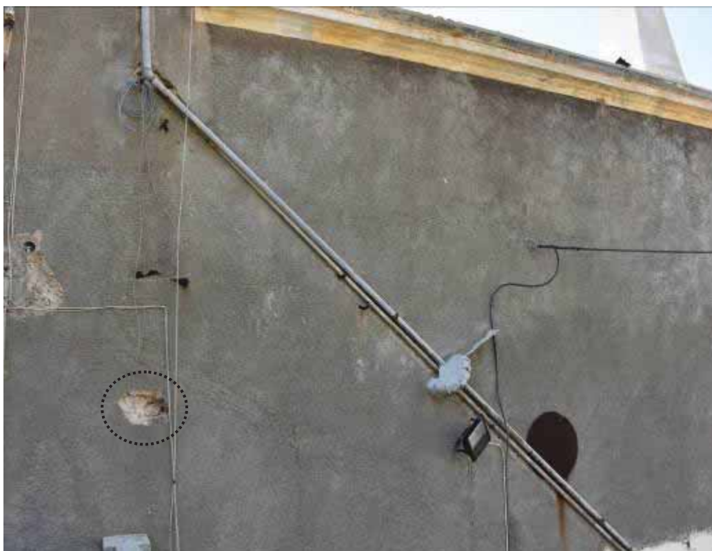
Φωτ. 57 Οξειδωμένοι μεταλλικοί δοκοί, ρηγματώσεις, αποκολλήσεις, απώλειες, σωληνώσεις και καλωδιώσεις στη βόρεια όψη.
