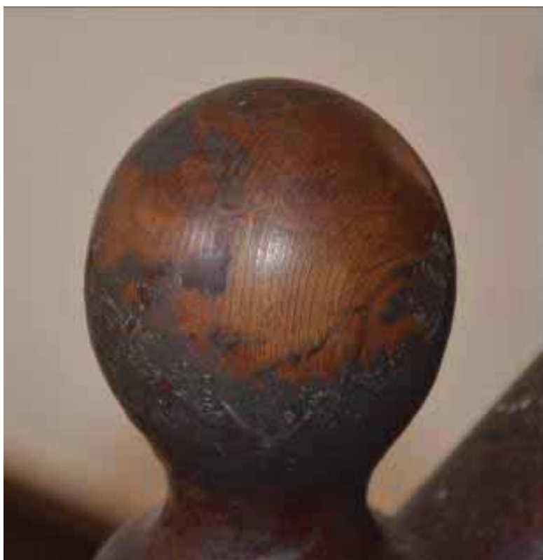
Φωτ. 257 Επικαθίσεις ρύπων στις ξύλινες επιφάνειες.
