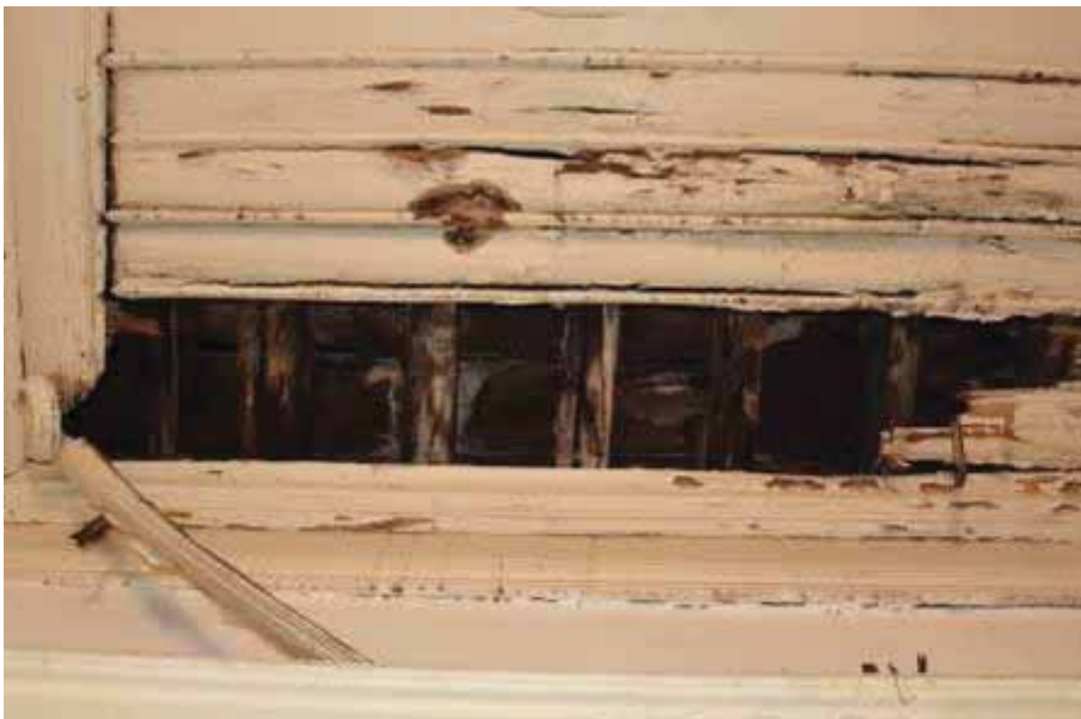
Φωτ. 312 Λεπτομέρεια της παραπάνω φωτογραφίας όπου διακρίνονται η υδρόλυση του ξύλινου φορέα και η προσβολή από σηπτικούς μύκητες.
