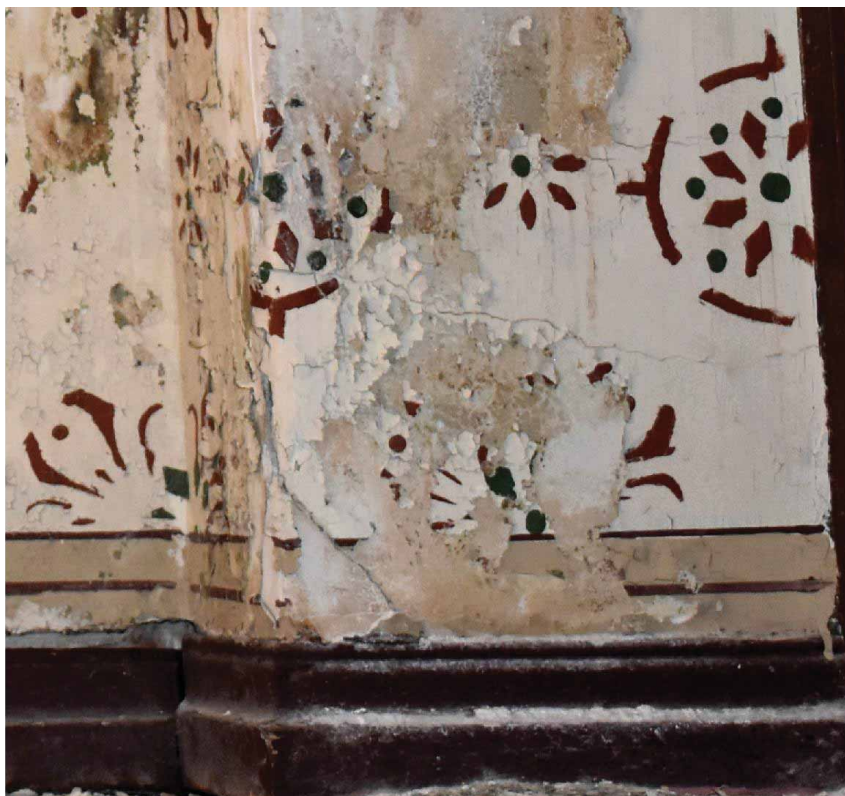
Φωτ. 157 Λεκέδες υγρασίας, ρωγμάτωση, απώλεια κονιάματος μαζί με το ζωγραφικό στρώμα, σαθροποιημένο υπόστρωμα, αποκολλημένο, αποχρωματισμένο και κονιορτοποιημένο ζωγραφικό στρώμα.
