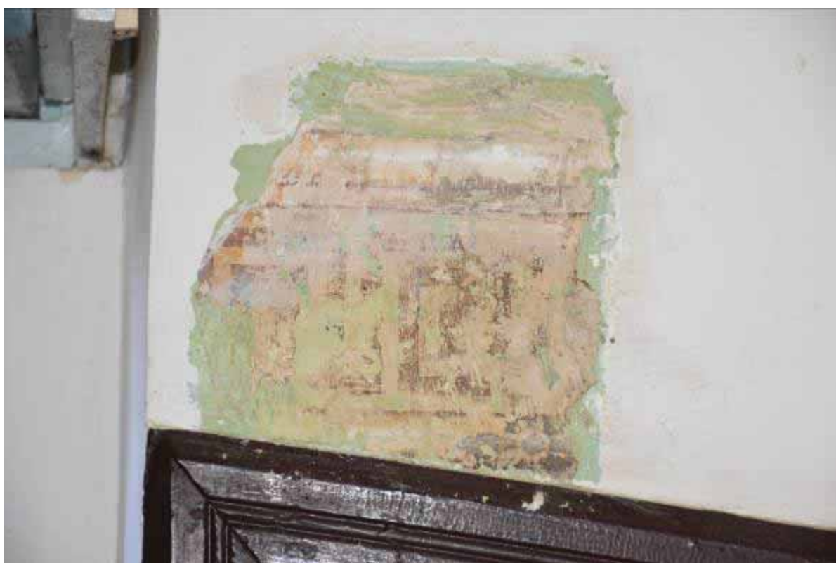
Φωτ. 185 Το υποκείμενο ζωγραφικό στρώμα στη θέση του πασαμέντο στον χώρο του κλιμακοστασίου.
