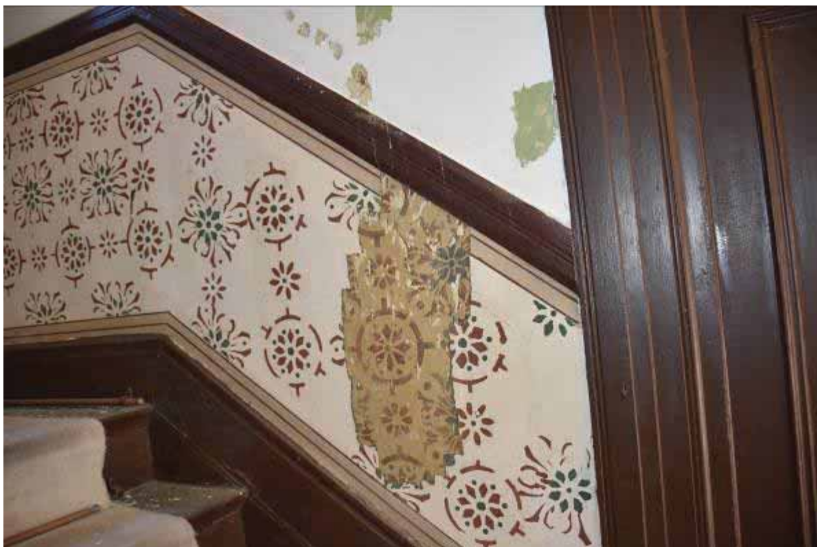
Φωτ. 184 Το υποκείμενο ζωγραφικό στρώμα στη θέση του πασαμέντο στον χώρο του κλιμακοστασίου.
