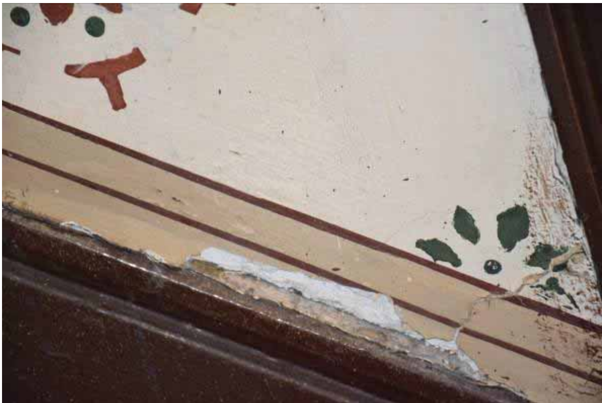
Φωτ. 188 Ρωγματώσεις και απώλειες του κονιάματος μαζί με το ζωγραφικό στρώμα.
