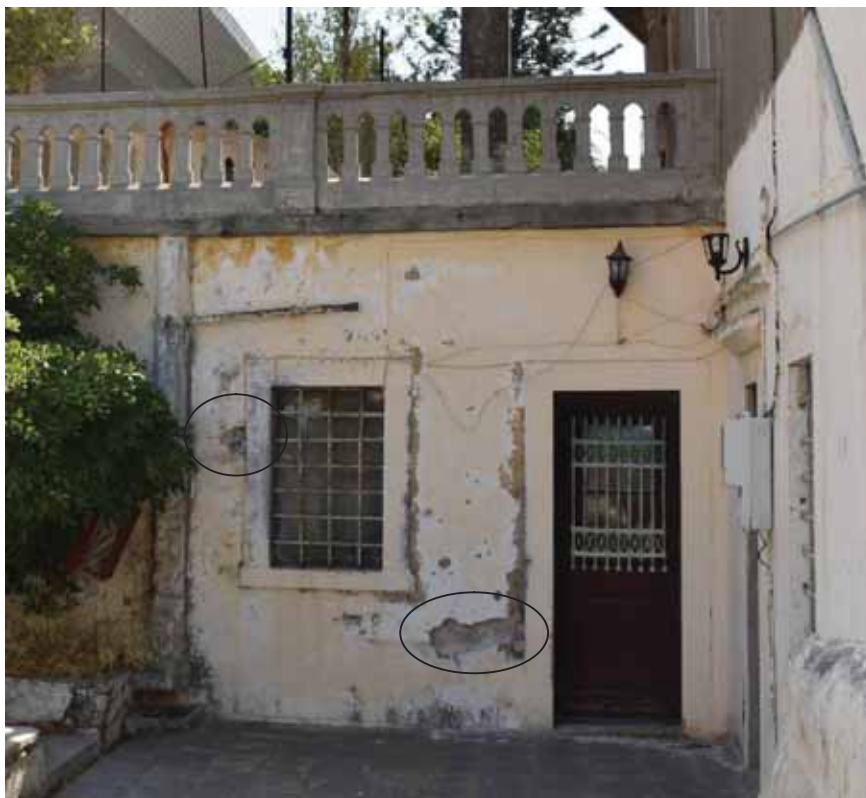
Φωτ. 51 Ρηγματώσεις, αποκολλήσεις, κονιορτοποιήσεις και απώλειες στο επίχρισμα της βόρειας όψης.
