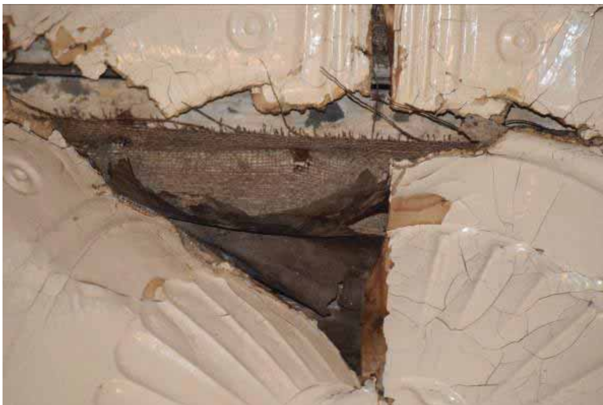
Φωτ. 220 Λεπτομέρεια της φθοράς που βρίσκεται εντός μαύρου πλαισίου στην προηγούμενη φωτογραφία. Παρατηρείται ότι η λινάτσα είναι ιδιαίτερα οξειδωμένη, τα νήματα της έχουν αποξηλωθεί, ενώ οι μεταλλικοί σύνδεσμοι έχουν οξειδωθεί.
