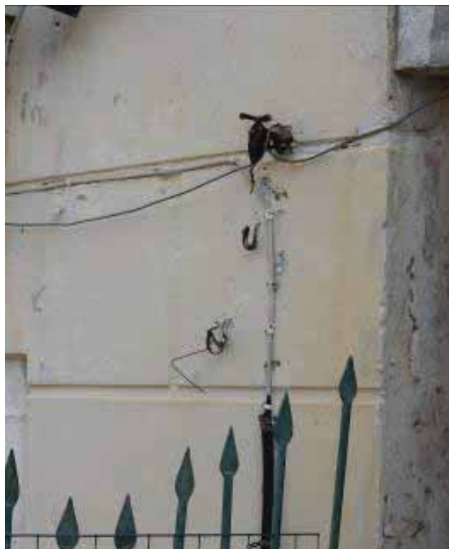
Φωτ. 61 Νεότερη ηλεκτρολογική εγκατάσταση στη νότια όψη.
