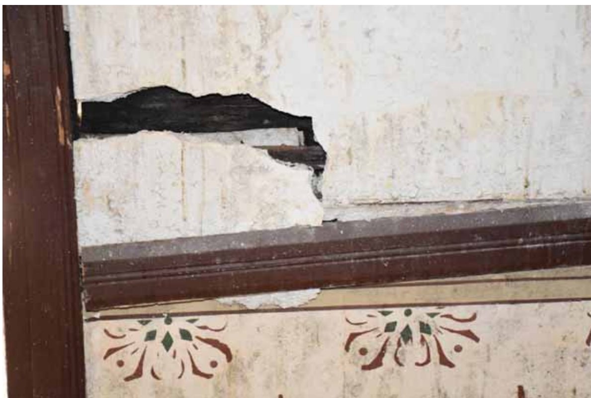
Φωτ. 4 Ξυλόπηκτος τοίχος ο οποίος είναι εμφανής από απώλεια κονιάματος στον χώρο Β1.
