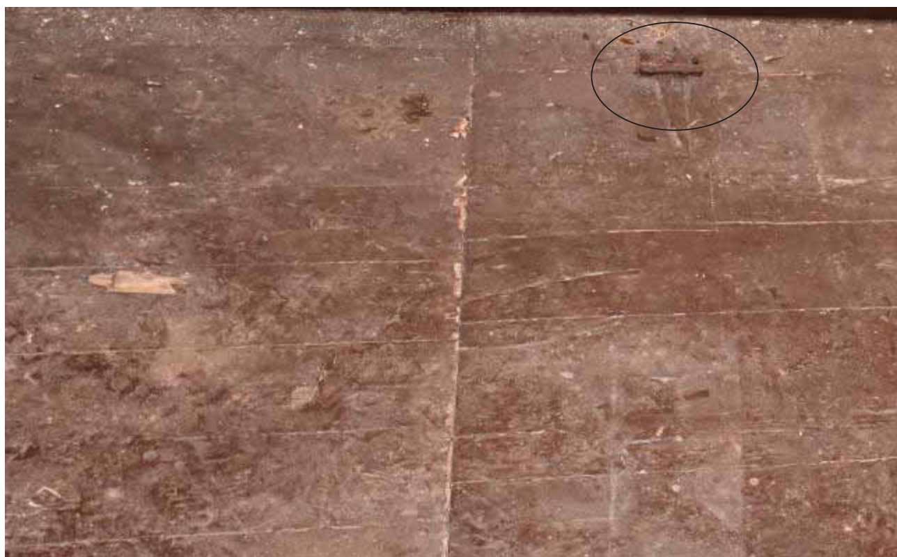
Φωτ. 358 Ρωγματώσεις, εκδορές και οξειδωμένοι μεταλλικοί σύνδεσμοι στο ξύλινο δάπεδο του χώρου ΙΣ4.
