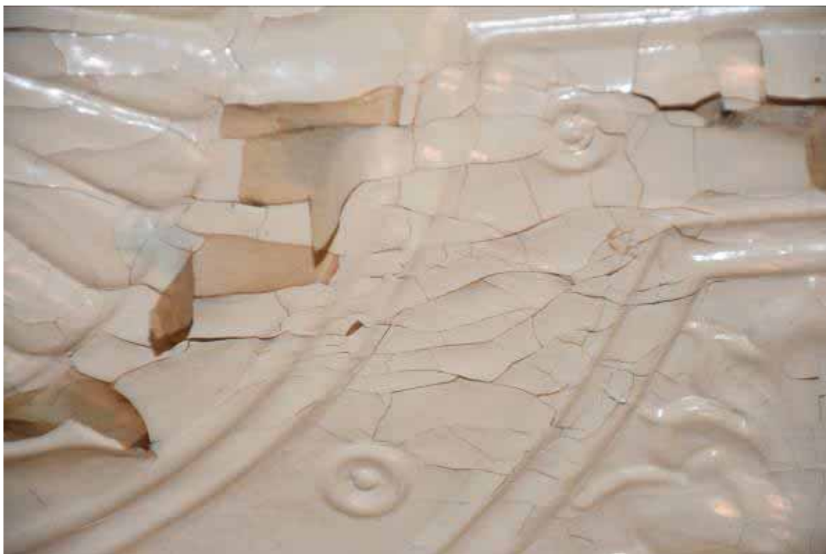
Φωτ. 222 Κρακελαρίσματα, αποκολλήσεις και απώλειες του χρωματικού στρώματος της ταπετσαρίας της οροφής.
