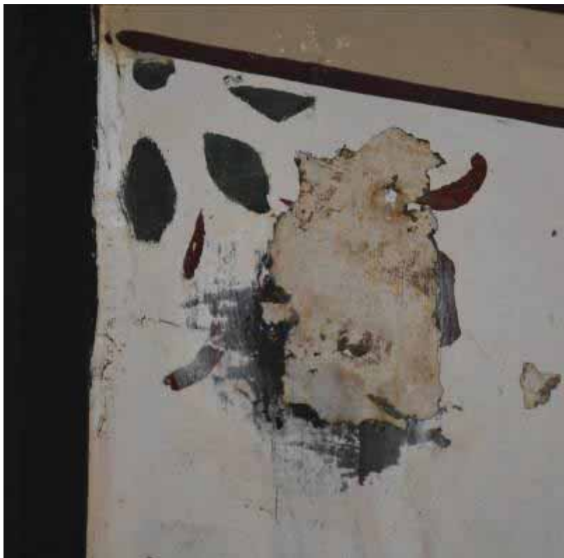
Φωτ. 190 Ρωγματώσεις, κονιορτοποιημένο και αποχρωματισμένο ζωγραφικό στρώμα.
