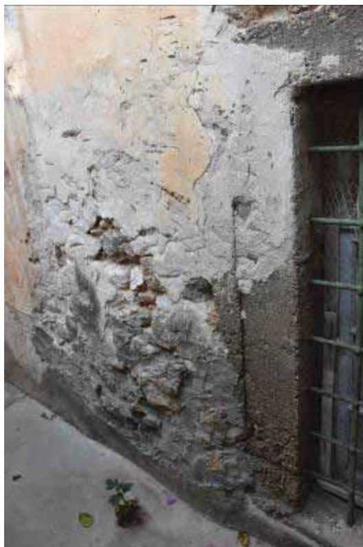
Φωτ. 43 Απώλειες των επιχρισμάτων και συμπλήρωση των απωλειών με νεότερα τσιμεντοκονιάμα στην ανατολική όψη.
