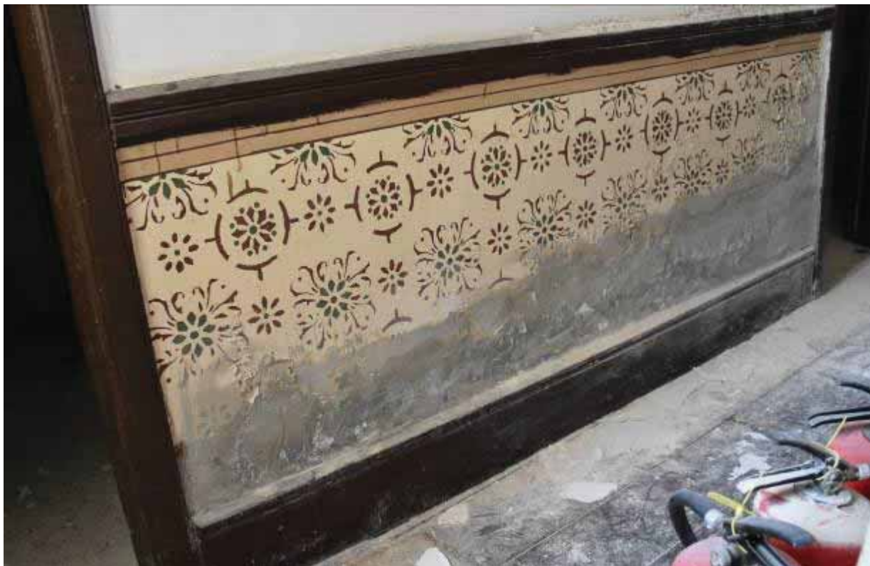
Φωτ. 120 Πλήρωση των απωλειών με νεότερα τσιμεντοκονιάματα, απολεπισμένο, κονιορτοποιημένο και αποχρωματισμένο ζωγραφικό στρώμα στο πασαμέντο του χώρου ΙΣ7.
