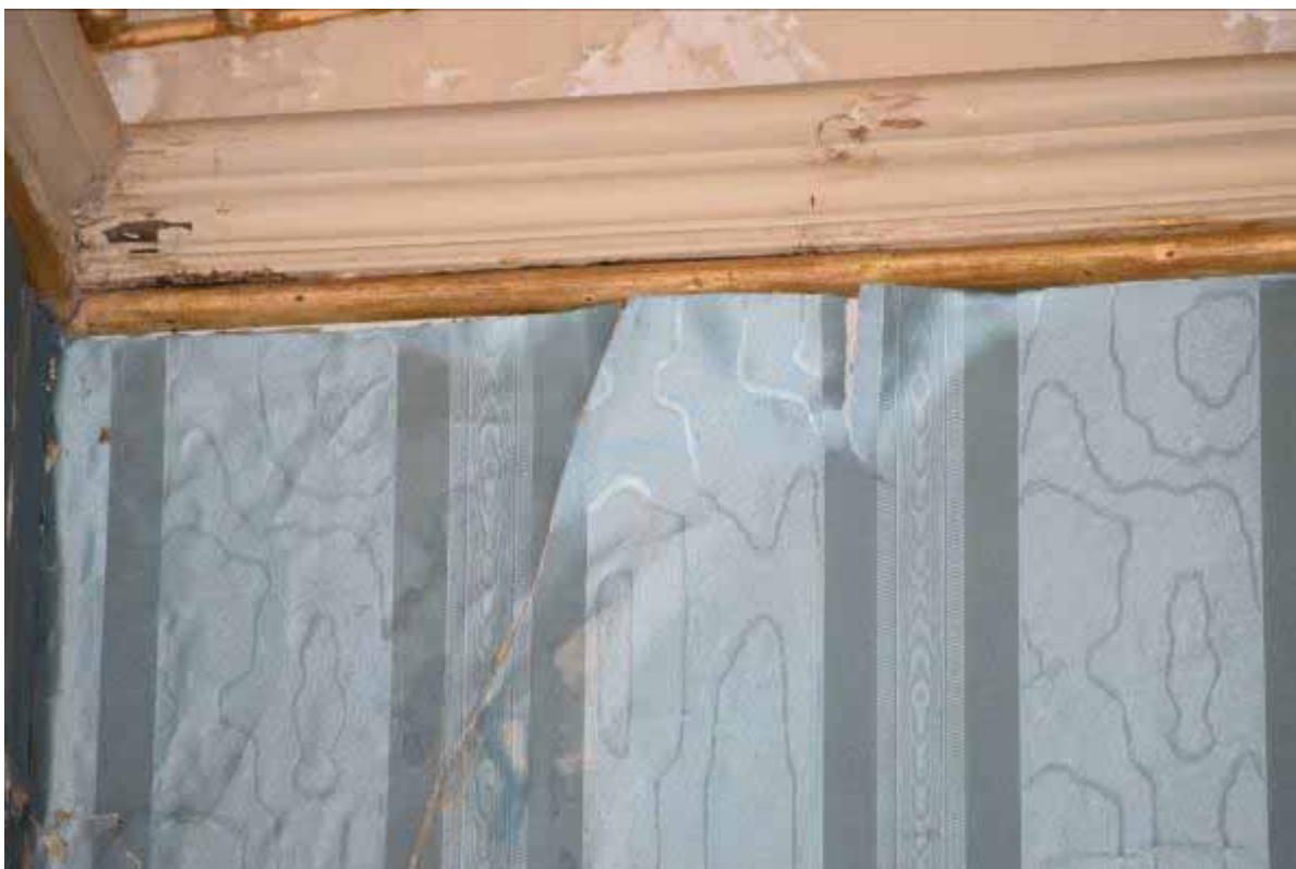
Φωτ. 230 Σκισίματα και αποκολλήσεις στην ταπετσαρία των τοίχων.
