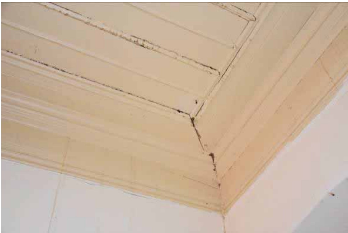
Φωτ. 274 Το γείσο της οροφής του χώρου ΙΣ4.
