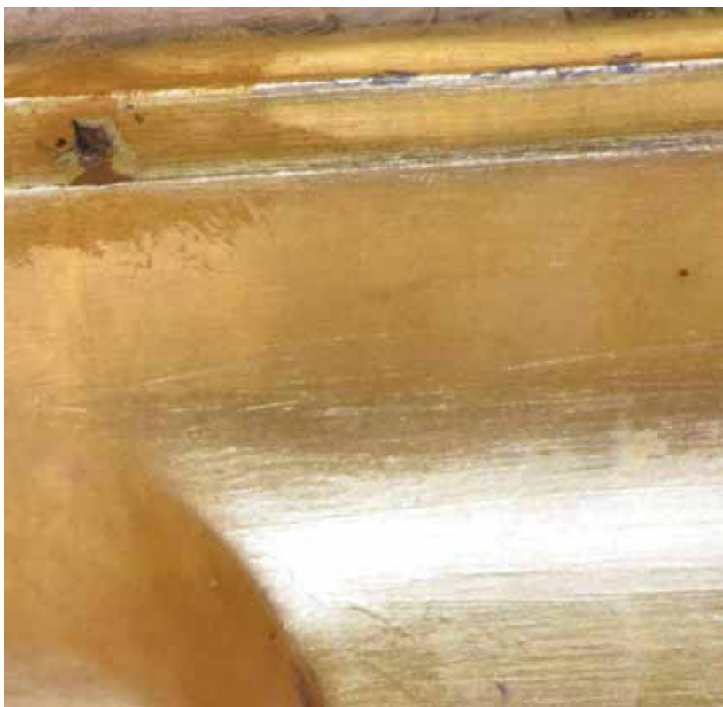
Φωτ. 501 Οξειδωμένοι μεταλλικοί σύνδεσμοι.
