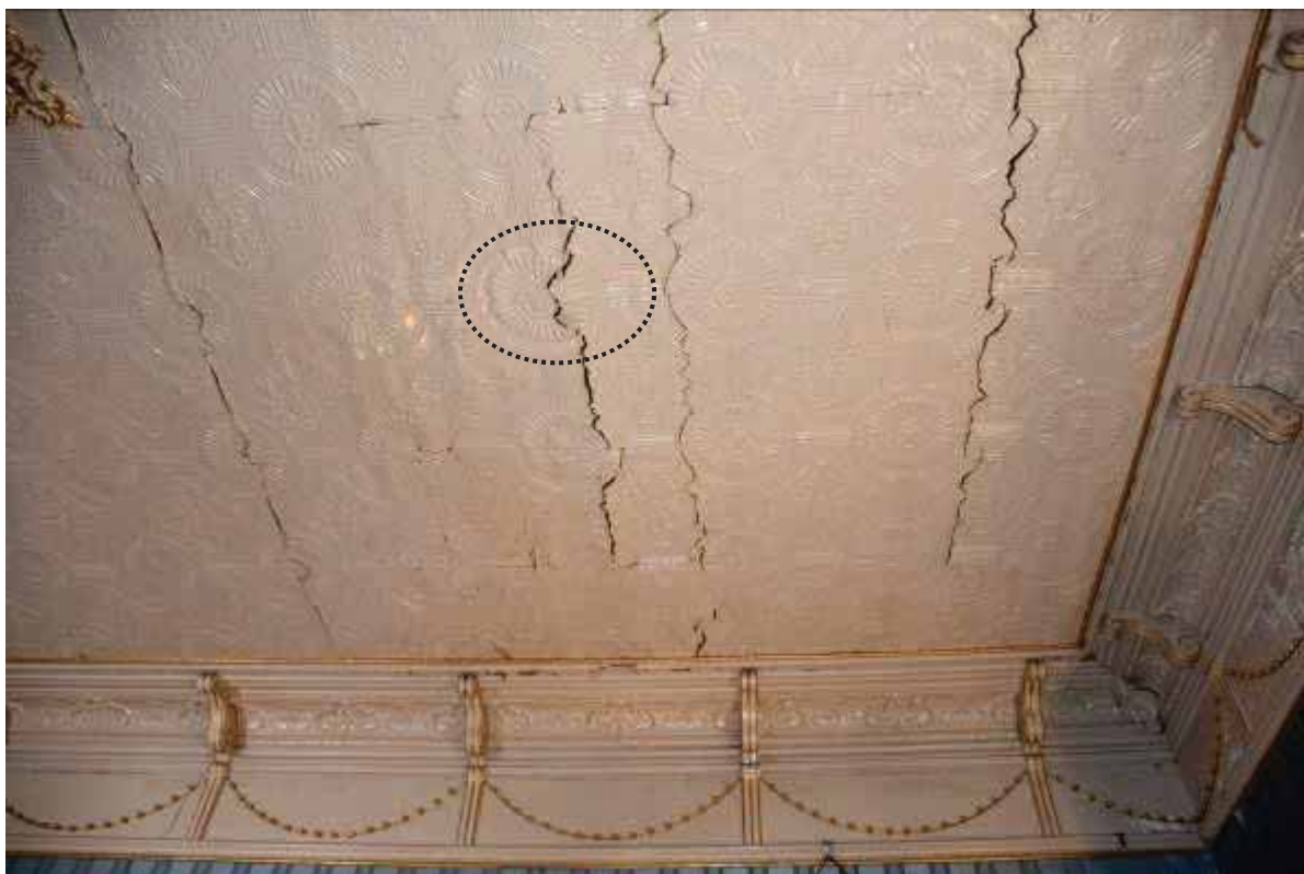
Φωτ. 215 Ρωγματώσεις και αποκολλήσεις στην ταπετσαρία της οροφής.
