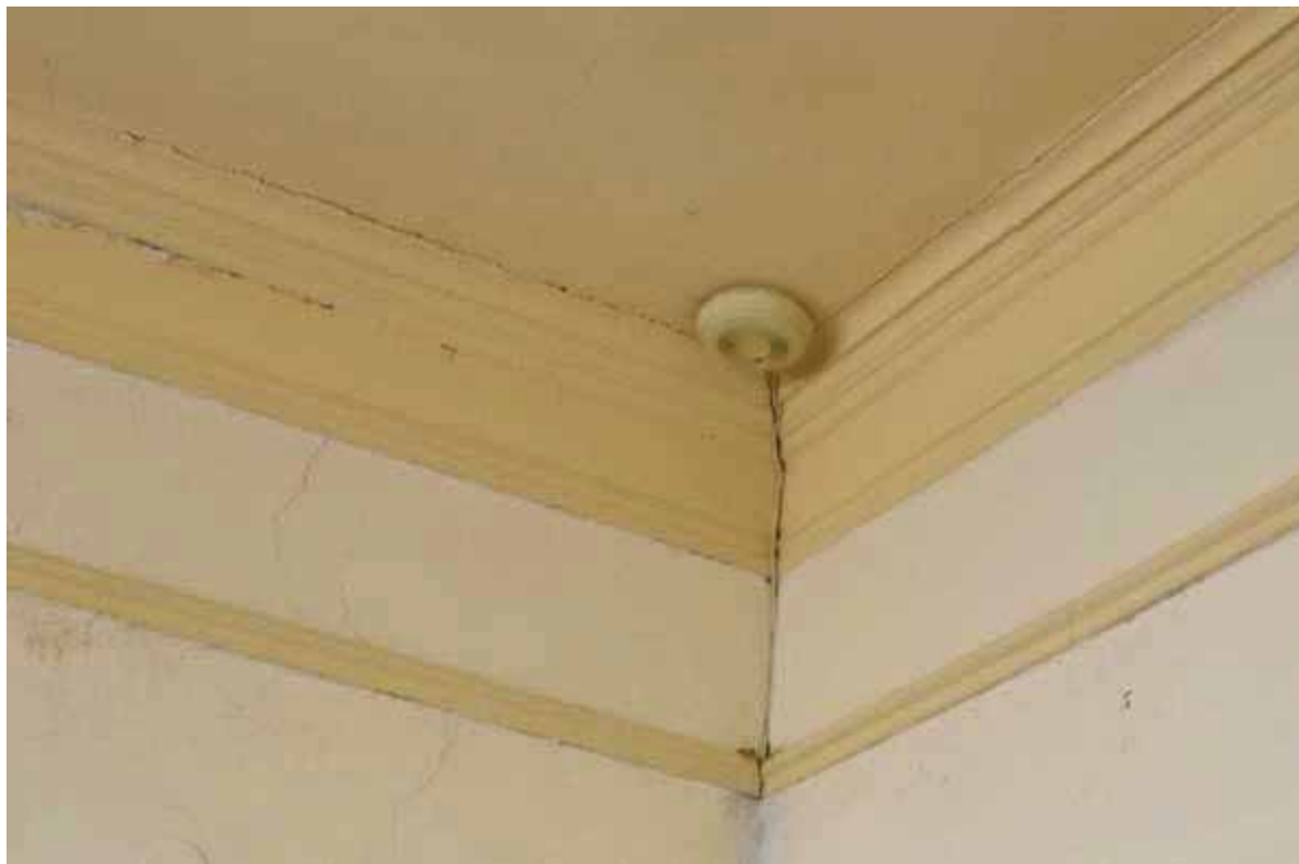
Φωτ. 291 Το ξύλινο γείσο της οροφής του χώρου Α5.
