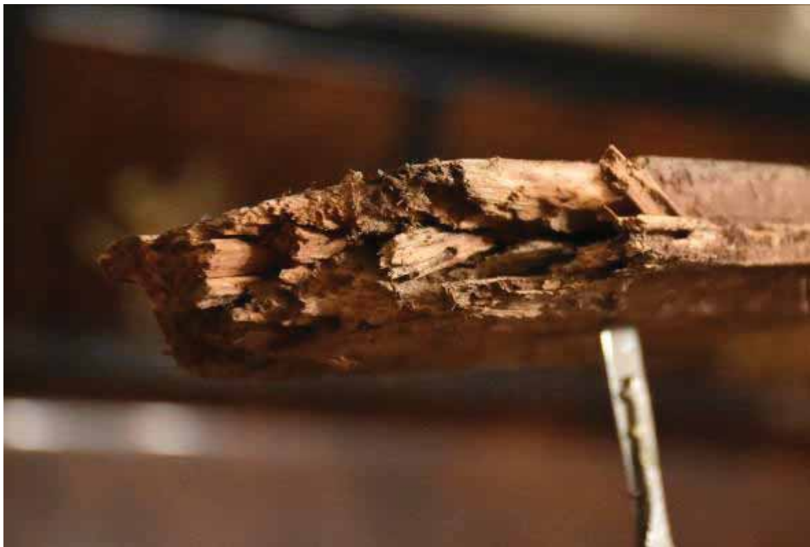
Φωτ. 352 Αποσπασμένο ξύλινο τμήμα του δαπέδου του χώρου ΙΣ5, το οποίο έχει προσβληθεί από ξυλοφάγα έντομα (τερμίτες).
