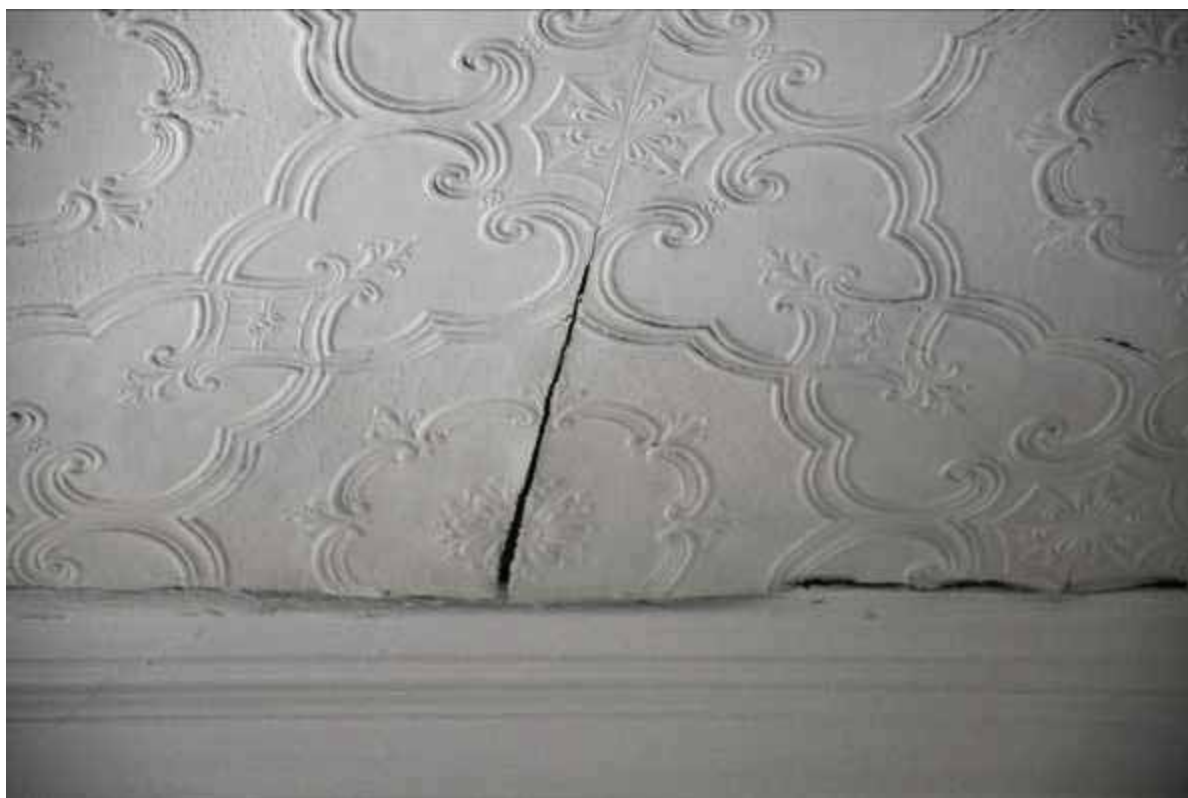
Φωτ. 206 Αποκολλημένη ταπετσαρία στην επαφή της με τα περιμετρικά ξύλινα κορνιζώματα και στην ένωση δύο τμημάτων της.
