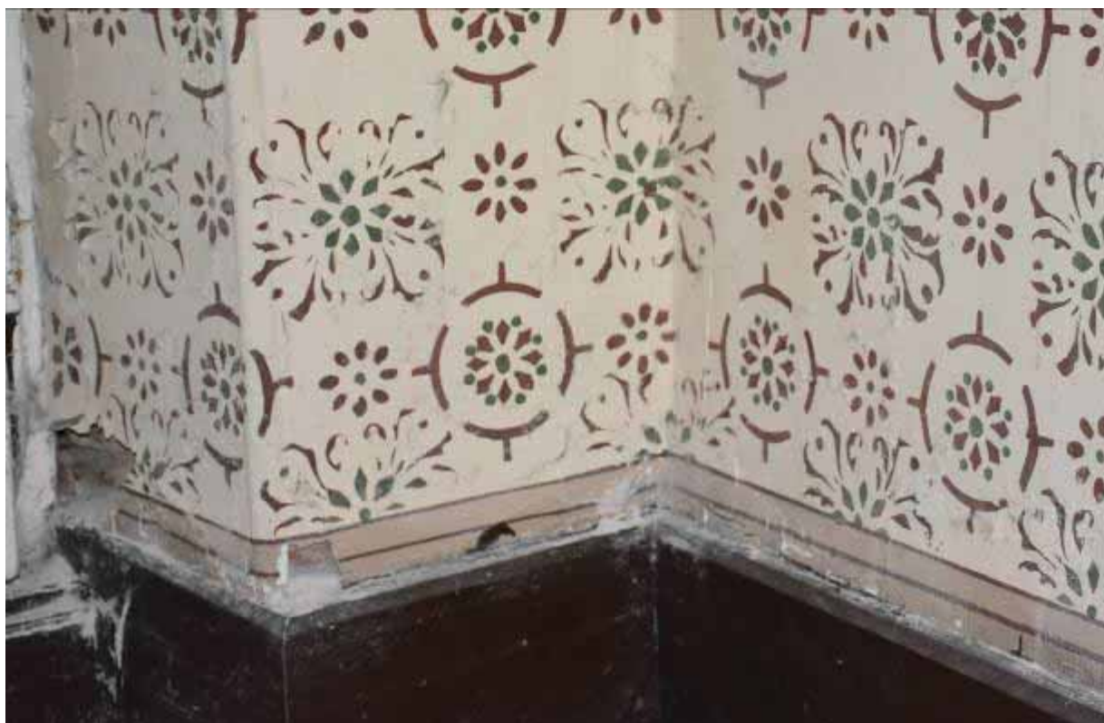
Φωτ. 94 Ρωγματώσεις, απώλειες κονιάματος μαζί με τη ζωγραφική επιφάνεια και αποσαθροποιημένο υπόστρωμα στο πασαμέντο του χώρου ΙΣ1γ.
