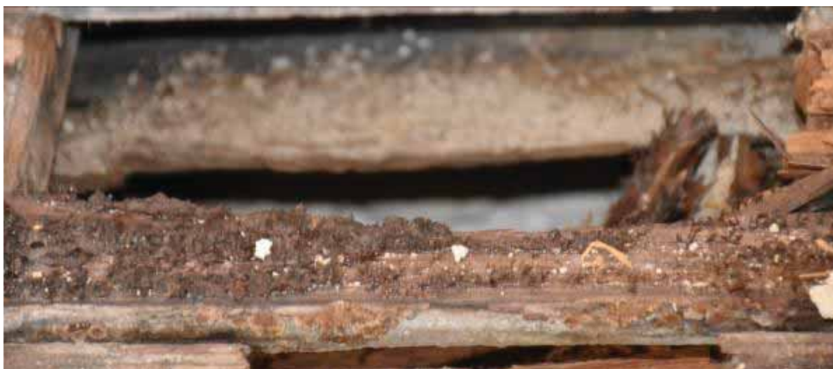
Φωτ. 354 Προσβολή από ξυλοφάγα έντομα (τερμίτες) στο δάπεδο του χώρου B2.
