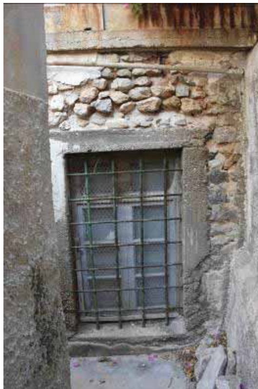
Φωτ. 41 Απώλειες των επιχρισμάτων και συμπλήρωση των απωλειών με νεότερα τσιμεντοκονιάματα στην ανατολική όψη.
