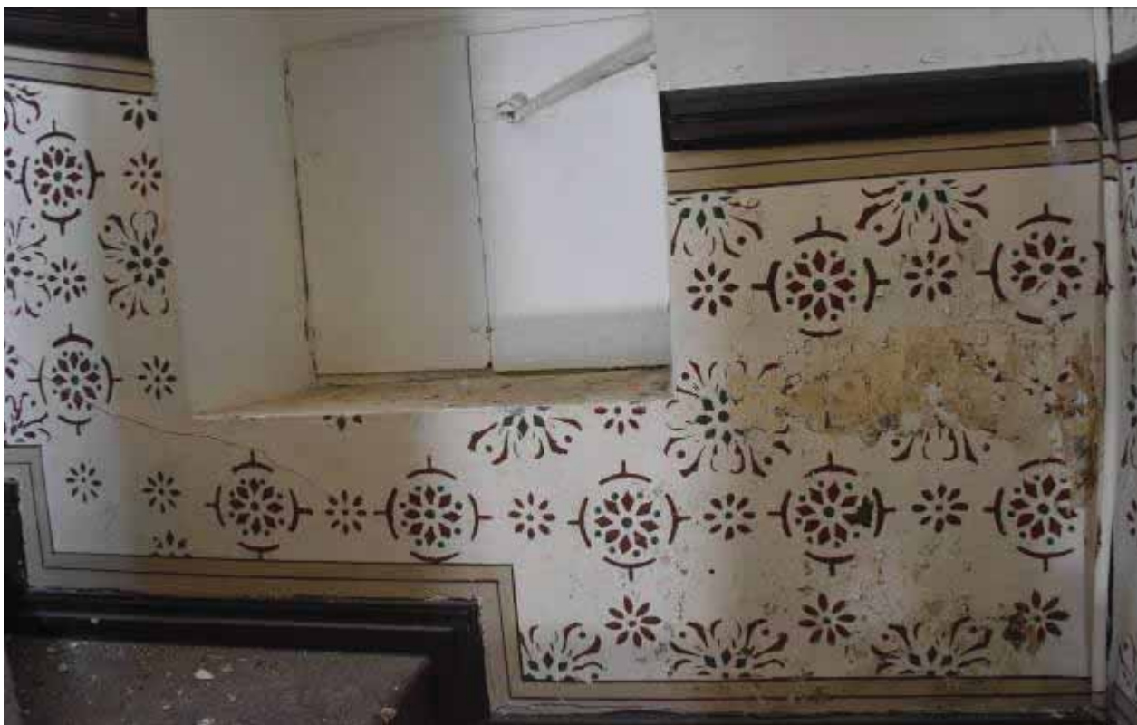
Φωτ. 191 Ρωγματώσεις, κονιορτοποιημένο και αποχρωματισμένο ζωγραφικό στρώμα.
