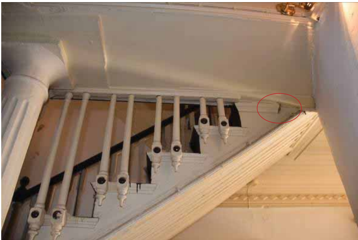
Φωτ. 244 Δείγμα αποκάλυψης στους εξωτερικούς βαθμιδοφόρους της ξύλινης κλίμακας.
