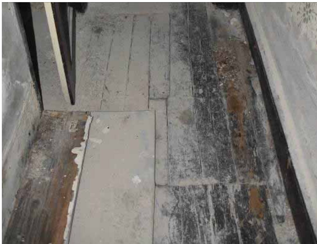
Φωτ. 355 Ρωγματώσεις, συμπλήρωση σανίδων, εκδορές και συσσώρευση ρύπων στο ξύλινο δάπεδο του χώρου ΙΣ7.
