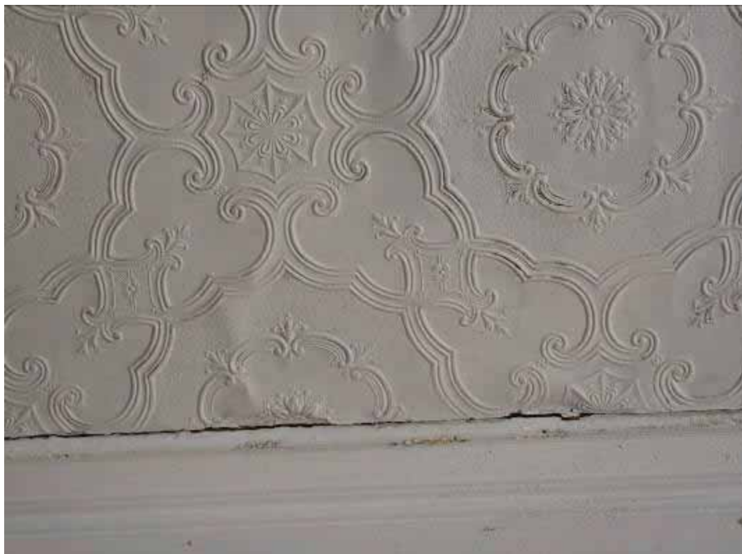
Φωτ. 205 Αποκολλημένη ταπετσαρία στην επαφή της με τα περιμετρικά ξύλινα κορνιζώματα.
