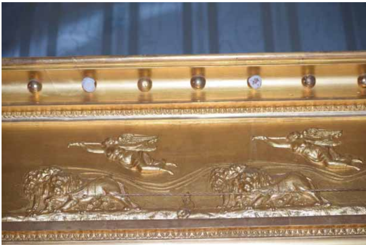
Φωτ. 500 Απώλειες και αποκολλήσεις του γύψινου υποστρώματος των κουρτινόξυλων.
