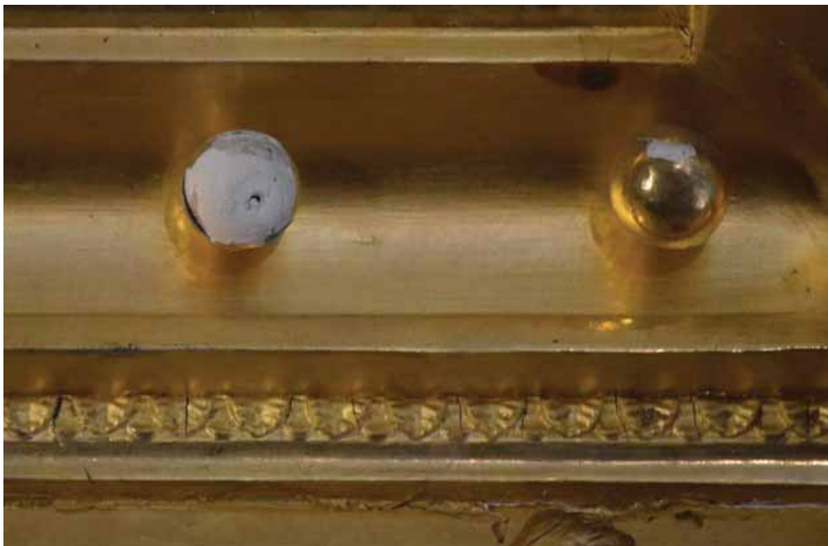
Φωτ. 498 Απώλειες και αποκολλήσεις του γύψινου υποστρώματος των κουρτινόξυλων.
