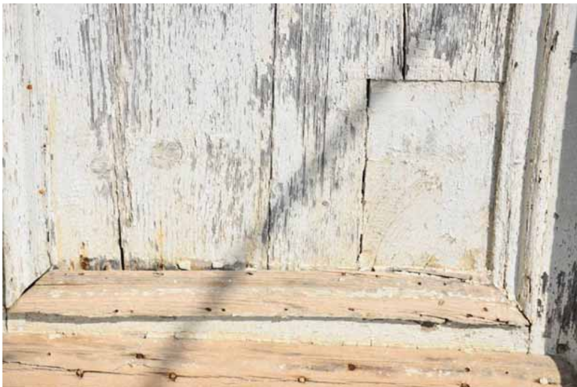
Φωτ. 460 Ρωγματώσεις, υδρόλυση του ξύλινου φορέα, αποχρωματισμός των εξωτερικών ξύλινων επιφανειών και απώλειες, αποκολλήσεις και κρακελαρίσματα των χρωματικών στρωμάτων στην εξωστόθυρα του χώρου Β1. Επιπλέον παρατηρείται παλαιότερη επέμβαση επιδιόρθωσης των ξύλινων σανιδωμάτων.
