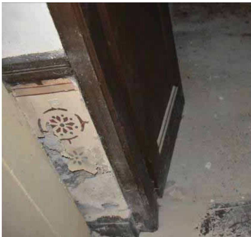
Φωτ. 119 Απώλεια κονιάματος μαζί με τη ζωγραφική επιφάνεια, αποσαθροποιημένο υπόστρωμα, απολεπισμένο, κονιορτοποιημένο και αποχρωματισμένο ζωγραφικό στρώμα στο πασαμέντο του χώρου ΙΣ7.
