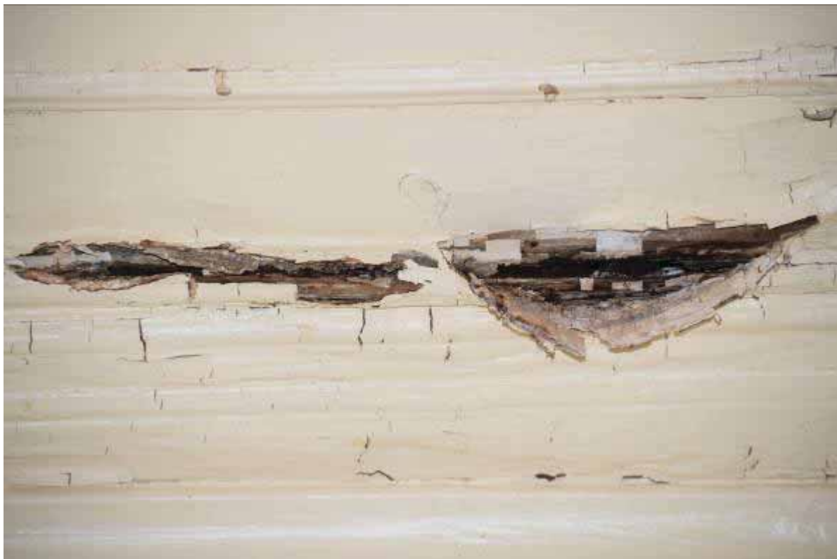
Φωτ. 315 Αποκολλήσεις και απώλειες ξύλινων τμημάτων από την είσοδο νερού και την προσβολή από ξυλοφάγα έντομα (τερμίτες) στην οροφή του χώρου Α1.
