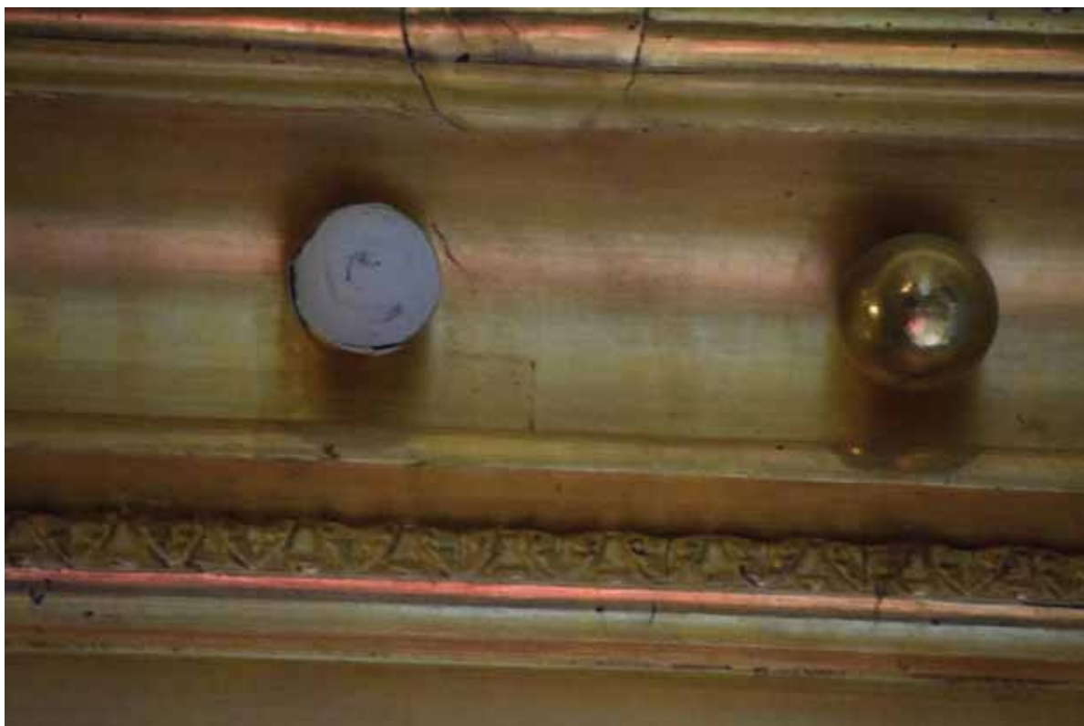
Φωτ. 497 Ρωγματώσεις, απώλειες και αποκολλήσεις του γύψινου υποστρώματος των κουρτινόξυλων.
