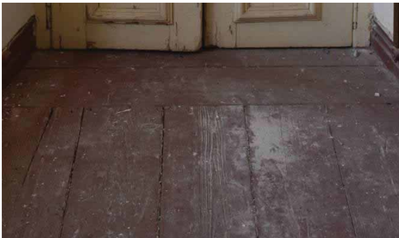
Φωτ. 360 Ρωγματώσεις, εκδορές και οξειδωμένοι μεταλλικοί σύνδεσμοι στο ξύλινο δάπεδο του χώρου Α5.
