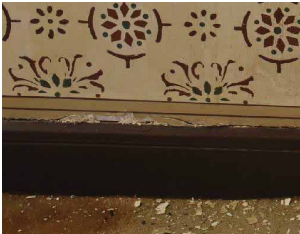
Φωτ. 134 Ρωγματώσεις και απώλειες του κονιάματος μαζί με το ζωγραφικό στρώμα στο πασαμέντο του χώρου Α1α.
