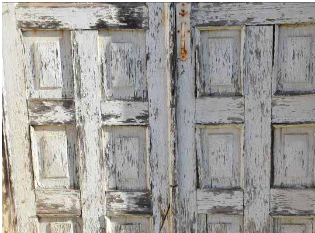
Φωτ. 400 Ρωγματώσεις, γκριζάρισμα και υδρόλυση του ξύλινου φορέα και απώλεια χρωστικών μέχρι την επιφάνεια του ξύλου στην εξωτερική πλευρά της ξύλινης εξώθυρας του χώρου ΙΣ6β.
