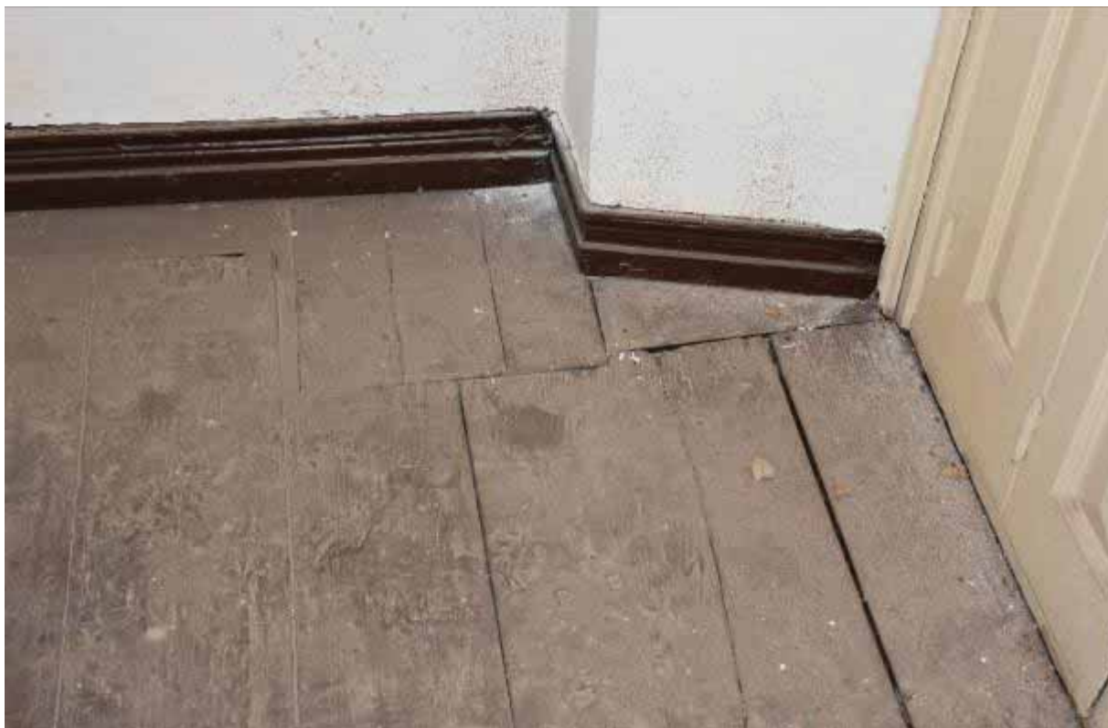
Φωτ. 359 Ρωγματώσεις, εκδορές και οξειδωμένοι μεταλλικοί σύνδεσμοι στο ξύλινο δάπεδο του χώρου Α3.
