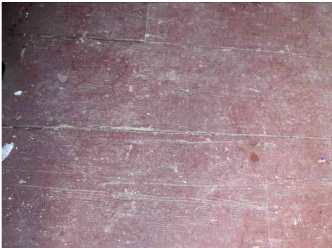
Φωτ. 361 Ρωγματώσεις και εκδορές στο ξύλινο δάπεδο του χώρου Β3.
