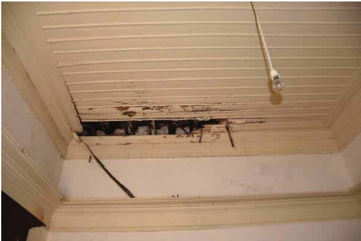
Φωτ. 311 Απώλειες και αποκολλήσεις ξύλινων τμημάτων στην οροφή του χώρου Α6.
