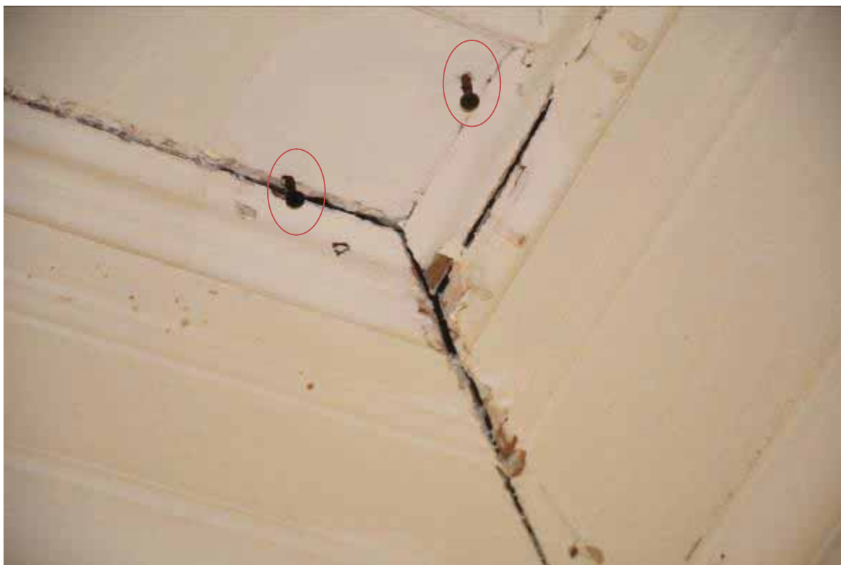
Φωτ. 320 Αποκόλληση ξύλινων τμημάτων και οξειδωμένοι μεταλλικοί σύνδεσμοι στην οροφή του χώρου ΙΣ4.
