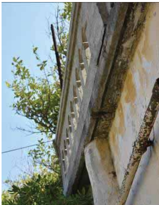
Φωτ. 59 Οξειδωμένοι δοκοί, ρωγματώσεις και απώλειες στο στηθαίο της βόρειας όψης.
