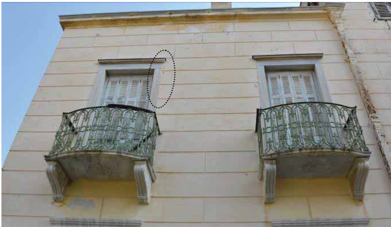
Φωτ. 39 Ρωγματώσεις και απώλειες στη νότια όψη.
