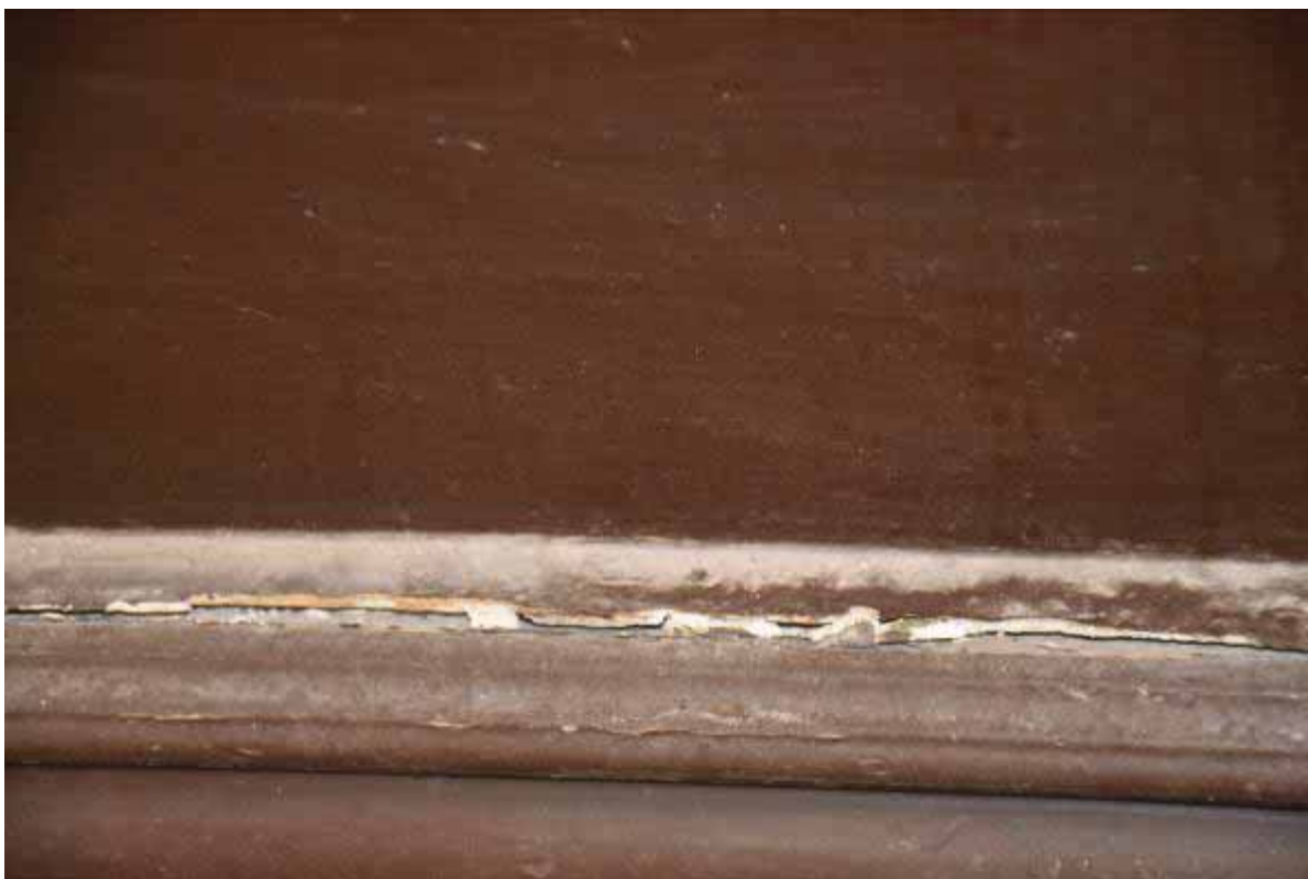
Φωτ. 253 Ρωγματώσεις και αποκολλήσεις ξύλινων στοιχείων.
