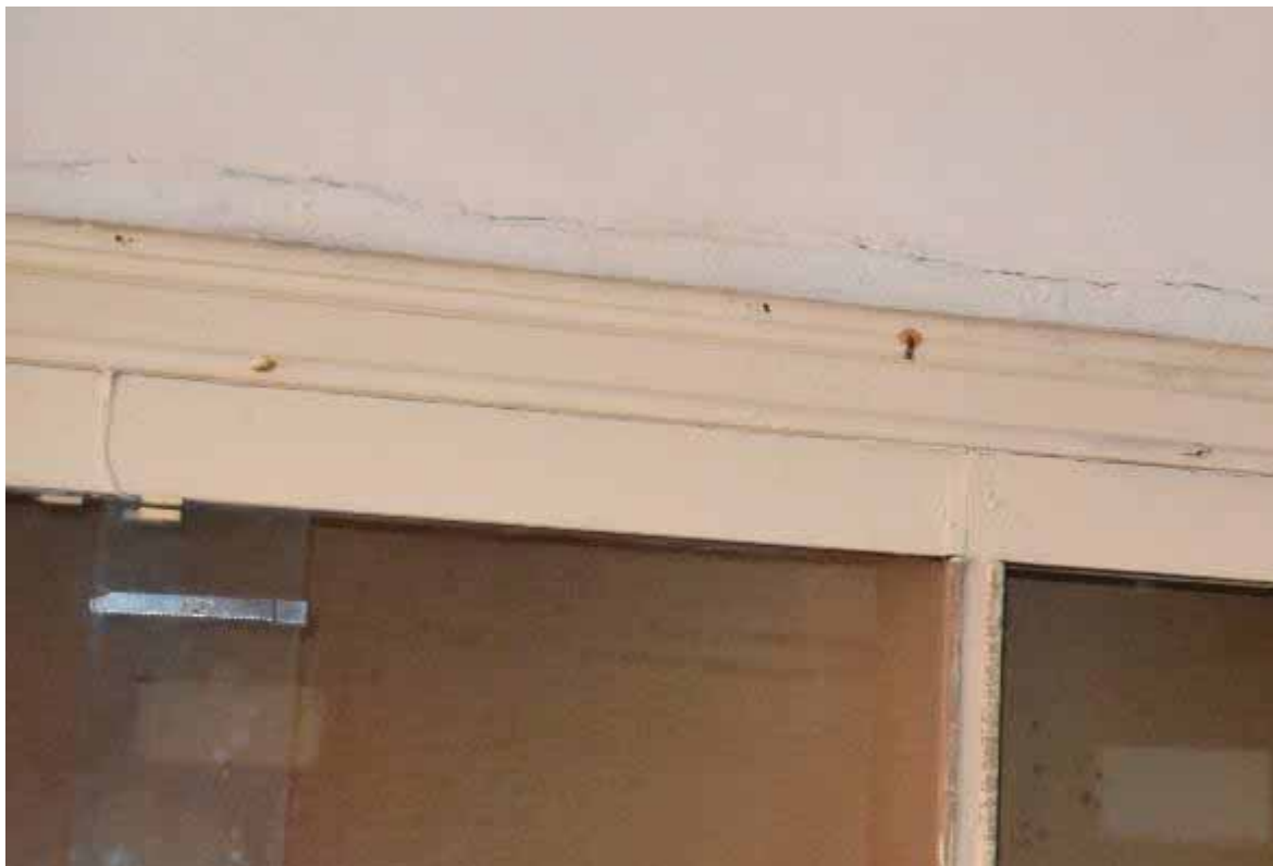
Φωτ. 474 Οξειδωμένοι μεταλλικού σύνδεσμοι στην ξύλινη εντοιχισμένη βιτρίνα του χώρου ΙΣ4.
