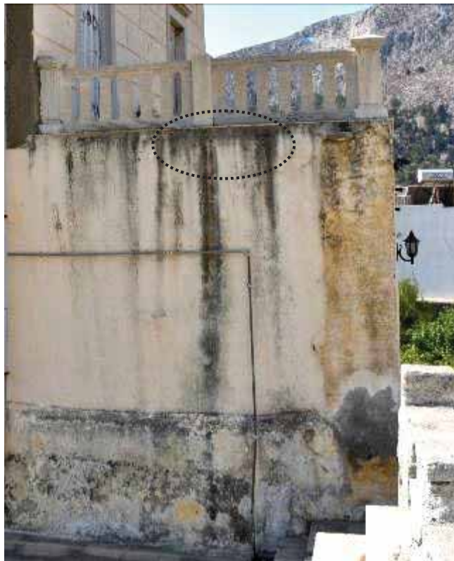
Φωτ. 49 Ρηγματώσεις, αποκολλήσεις, κονιορτοποιήσεις και ανάπτυξη βιολογικών επικαθίσεων στο επίχρυσμα της βόρειας όψης.
