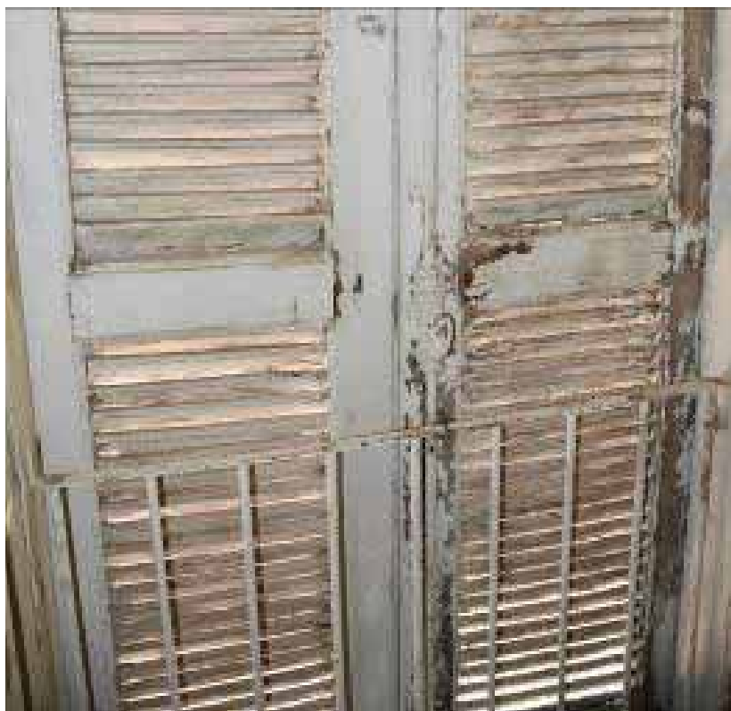
Φωτ. 459 Υδρόλυση του ξύλινου φορέα, αποχρωματισμός των ξύλινων επιφανειών και απώλειες, αποκολλήσεις και κρακελαρίσματα των χρωματικών στρωμάτων σε άνοιγμα του χώρου Β4.
