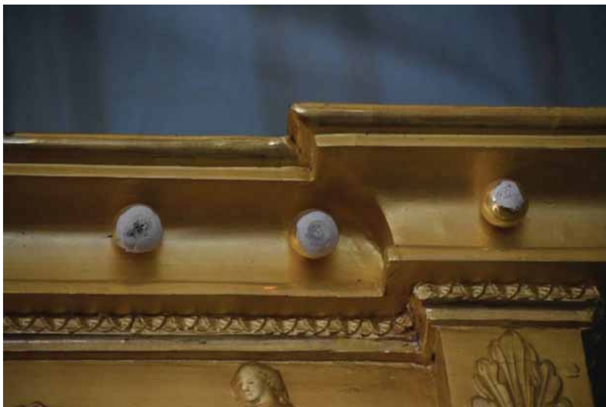
Φωτ. 499 Απώλειες και αποκολλήσεις του γύψινου υποστρώματος των κουρτινόξυλων.
