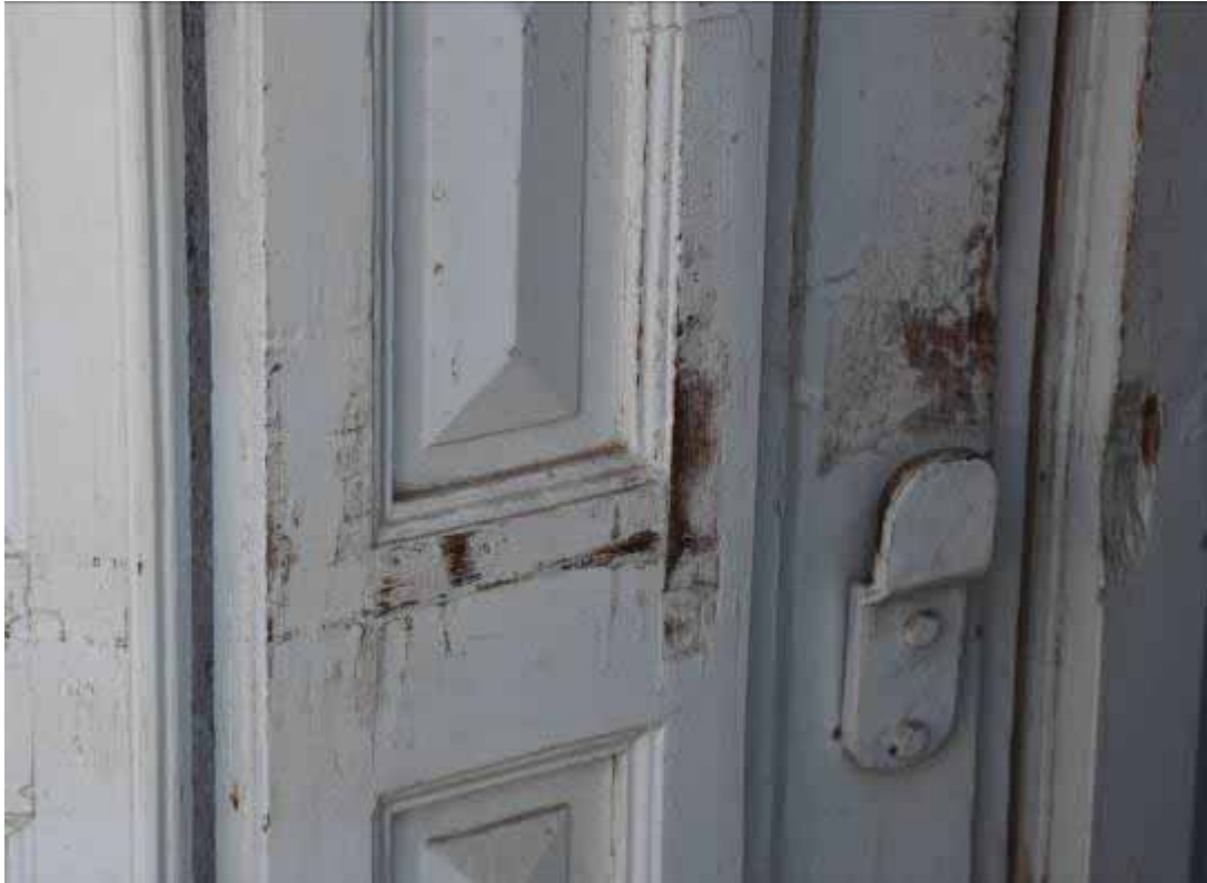
Φωτ. 463 Απώλεια χρωματικού στρώματος και εκδορές από τη χρήση της μεταλλικής μπάρας σφράγισης της εξωστόθυρας του χώρου Α1β.
