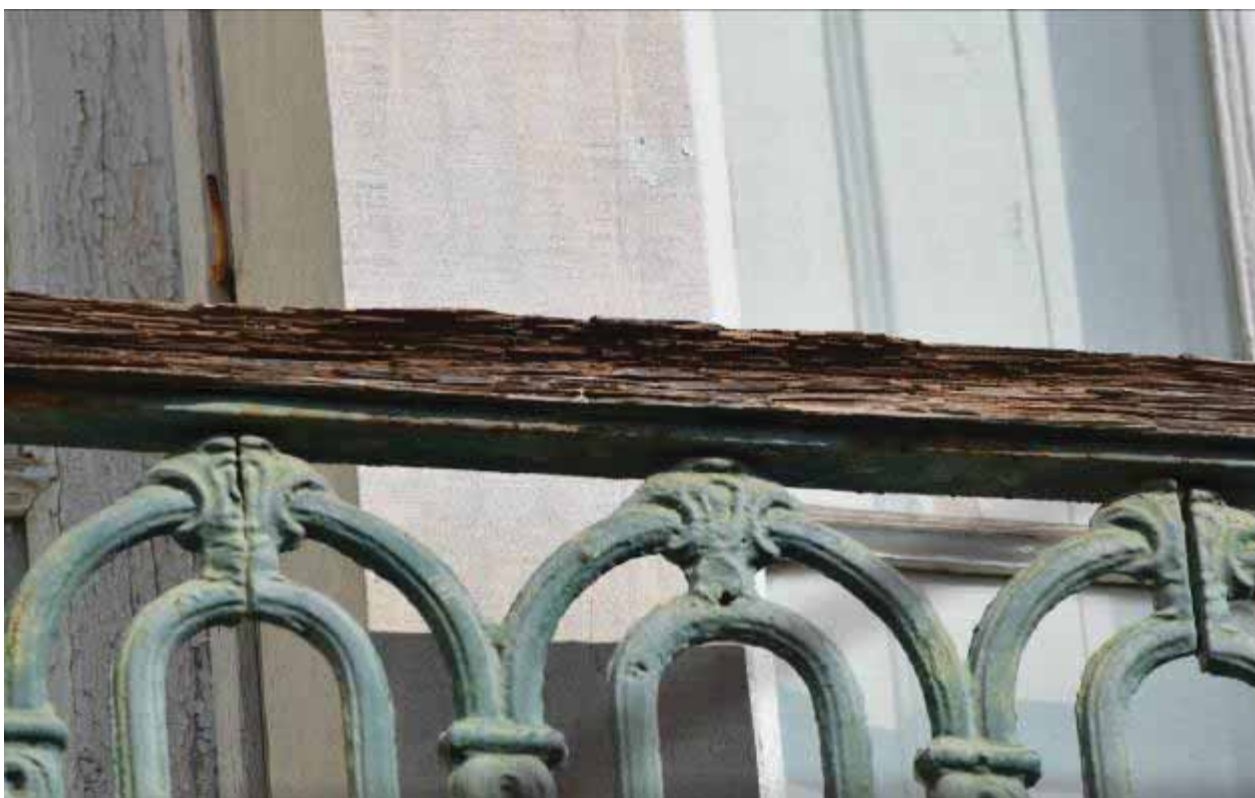
Φωτ. 482 Προσβολή από ξυλοφάγα έντομα, απώλειες ξύλινων τμημάτων, υδρολυμένος και αποσασθροποιημένος ξύλινος φορέας στην κουπαστή του εξώστη του χώρου Α5.
