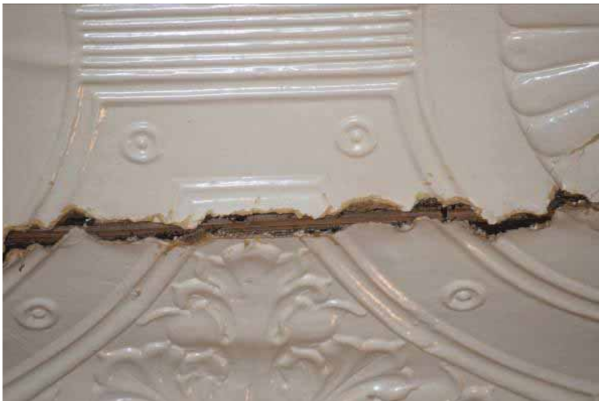
Φωτ. 218 Λεπτομέρεια της φθοράς που βρίσκεται εντός μαύρου πλαισίου στην προηγούμενη φωτογραφία.
