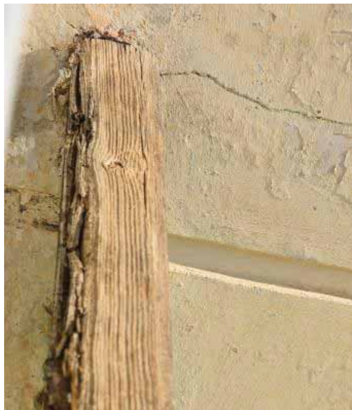
Φωτ. 483 Προσβολή από ξυλοφάγα έντομα στην κουπαστή του εξώστη του χώρου Α3.
