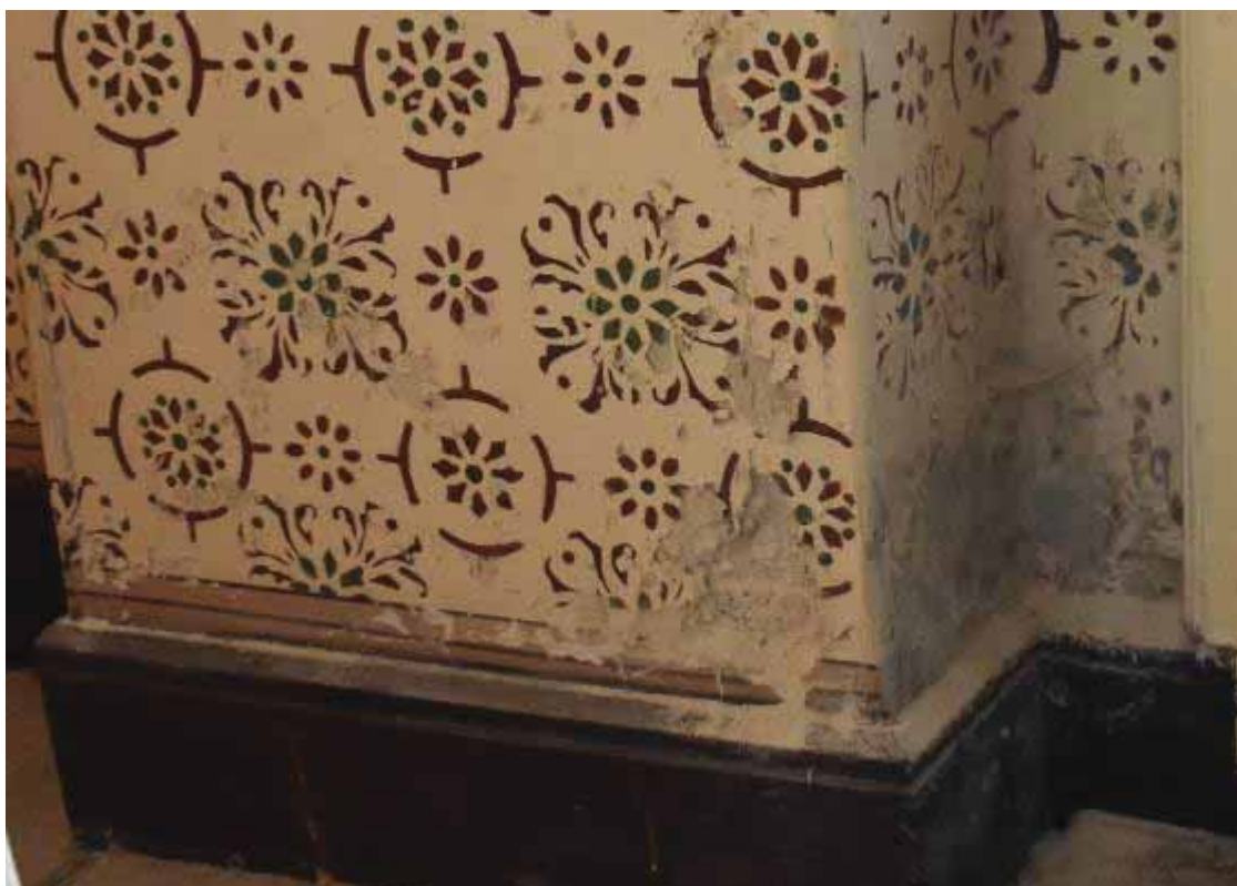
Φωτ. 118 Απώλεια κονιάματος μαζί με τη ζωγραφική επιφάνεια, αποσαθροποιημένο υπόστρωμα, απολεπισμένο, κονιορτοποιημένο και αποχρωματισμένο ζωγραφικό στρώμα στο πασαμέντο του χώρου ΙΣ7.
