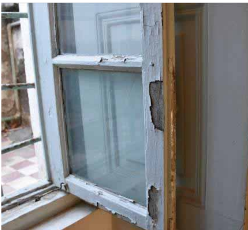
Φωτ. 462 Υδρόλυση του ξύλινου φορέα, αποχρωματισμός των εξωτερικών ξύλινων επιφανειών και απώλειες, αποκολλήσεις και κρακελαρίσματα των χρωματικών στρωμάτων σε άνοιγμα του κλιμακοστασίου.
