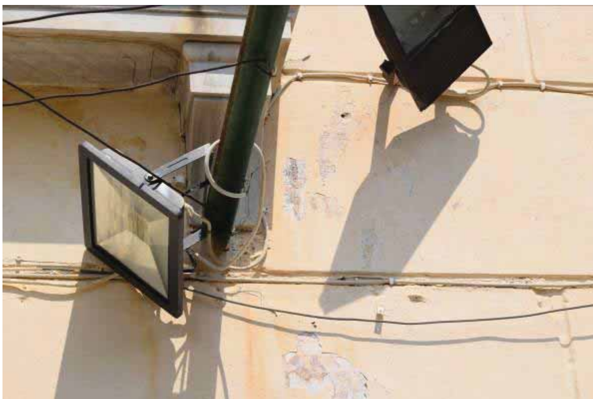
Φωτ. 62 Νεότερη ηλεκτρολογική εγκατάσταση στη νότια όψη.
