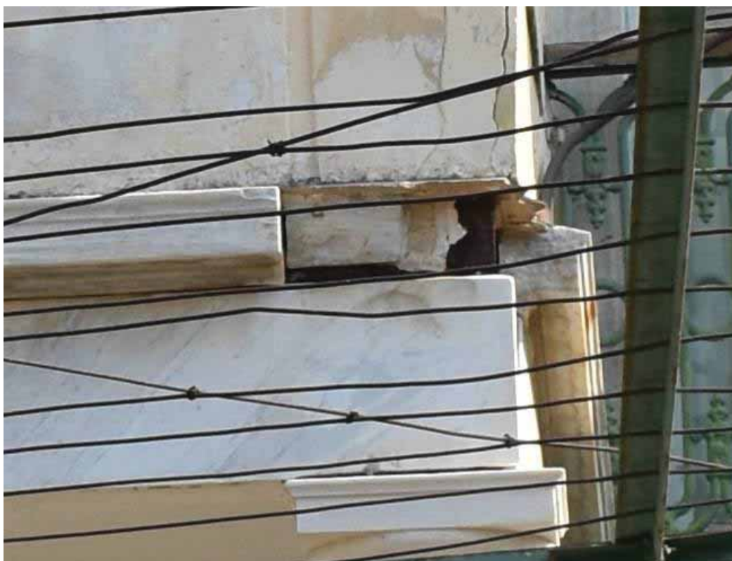
Φωτ. 7 Μεταλλικός σιδηροδοκός ο οποίος είναι εμφανής από απώλεια μαρμάρινου γείσου στην μπροστινή όψη του Αρχοντικού.
