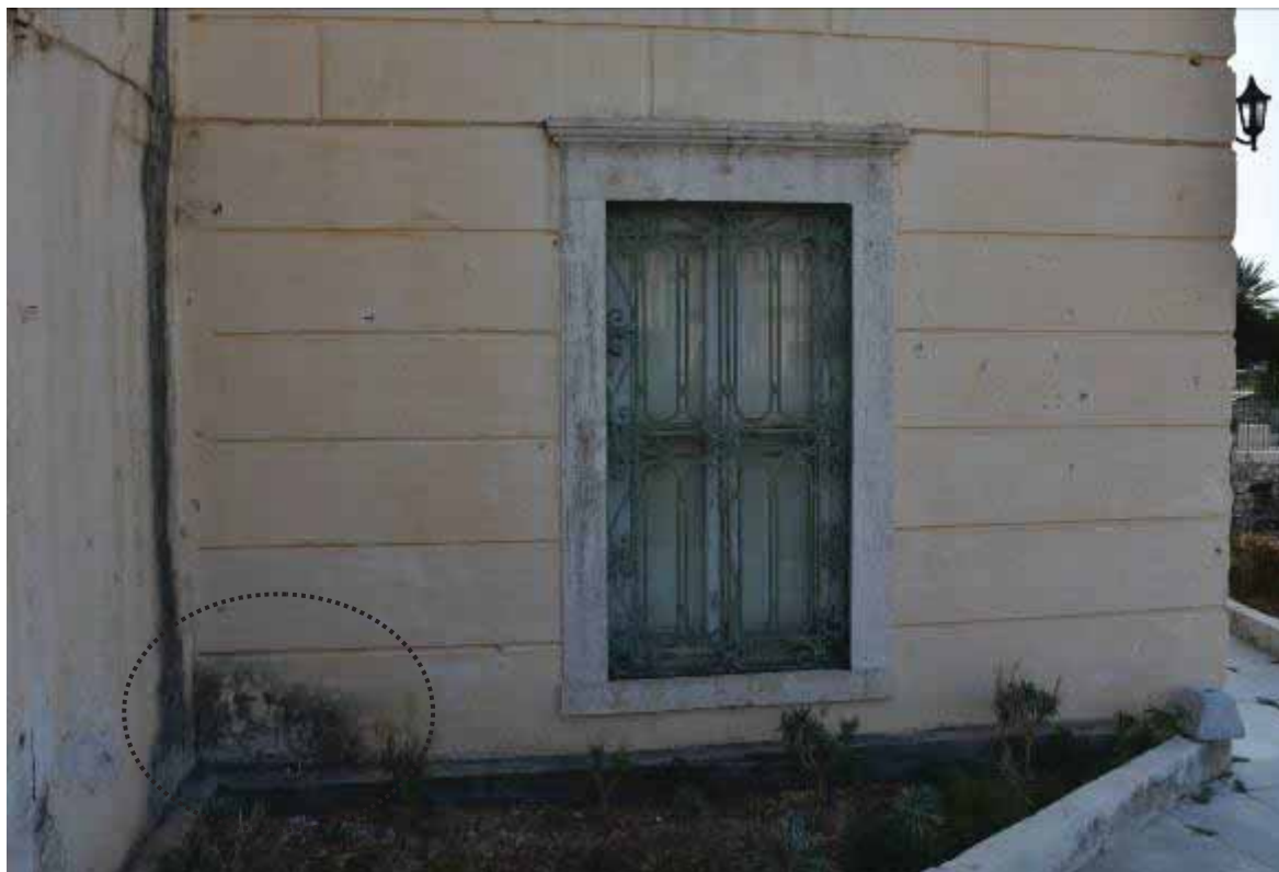
Φωτ. 53 Ρηγματώσεις, αποκολλήσεις, κονιορτοποιήσεις και ανάπτυξη βιολογικών επικαθίσεων στο επίχρισμα της βόρειας όψης.
