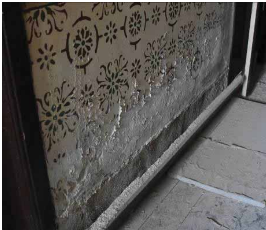
Φωτ. 121 Αποσαθροποιημένο υπόστρωμα, απολεπισμένο, κονιορτοποιημένο και αποχρωματισμένο ζωγραφικό στρώμα στο πασαμέντο του χώρου ΙΣ7.
