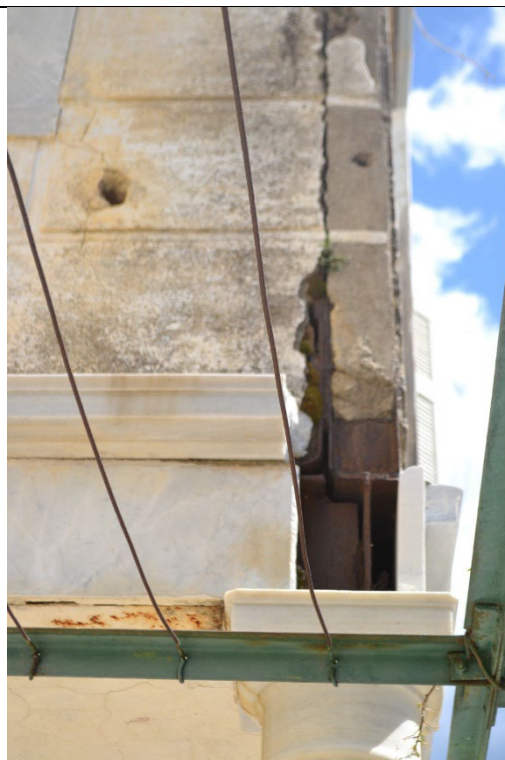
Εικ.19: ΝΔ γωνία χώρου Α4, εξωτερικά – φθορές τοιχοποιίας και μαρμάρινης επένδυσης προστώου
