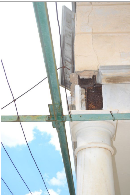
Εικ.18: Μαρμάρινη επένδυση προστώου – λεπτομέρεια: απώλεια τμήματος πάνω από την ανατολική γωνία
