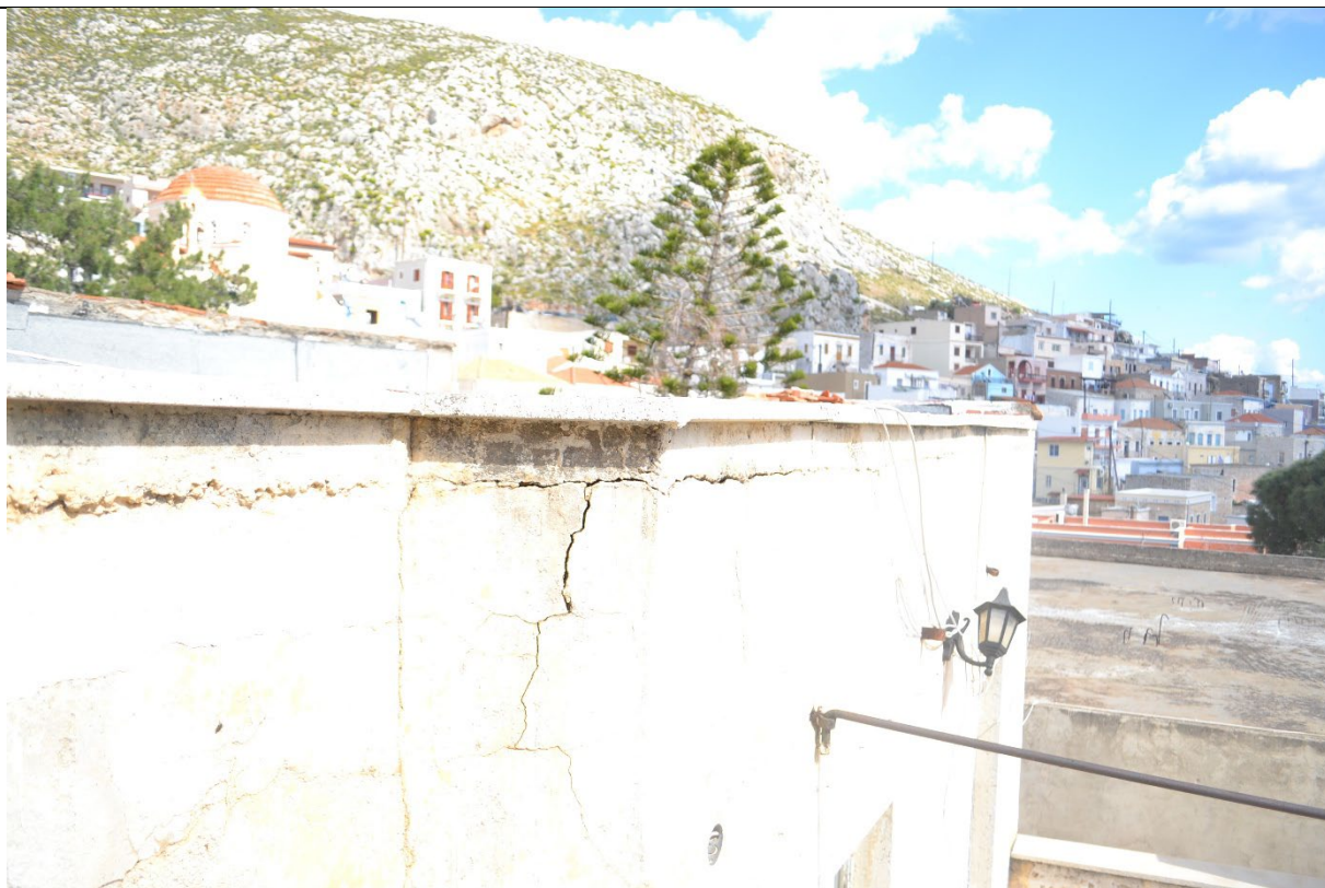
Εικ.37: Φθορές στην εξωτερική τοιχοποιία (νότια όψη) του χώρου B2
